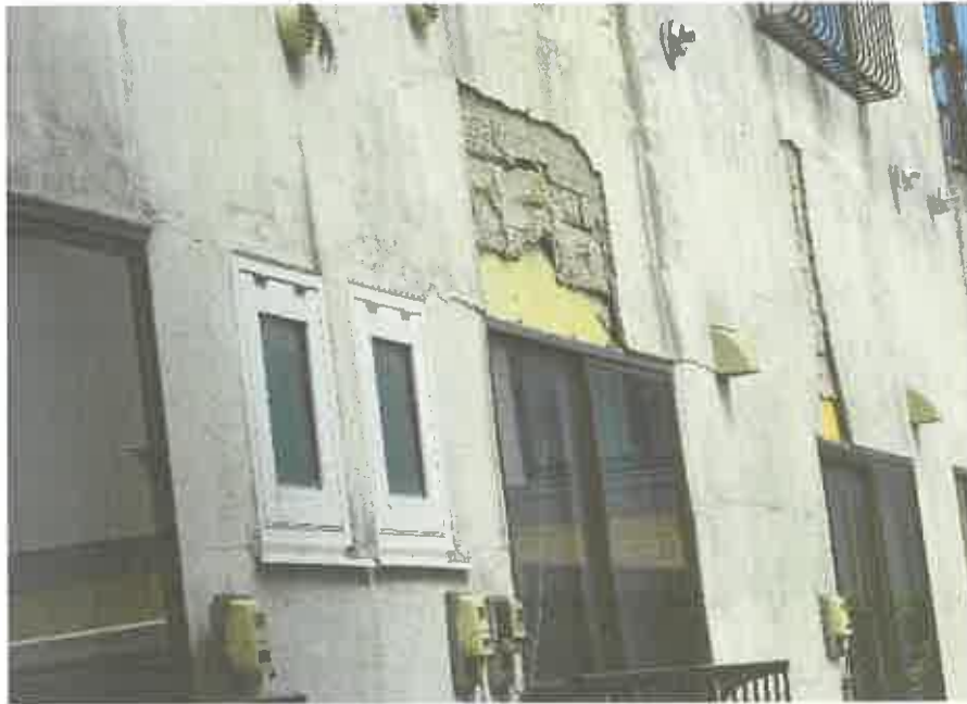
南西側外壁のモルタル面の崩落状況
