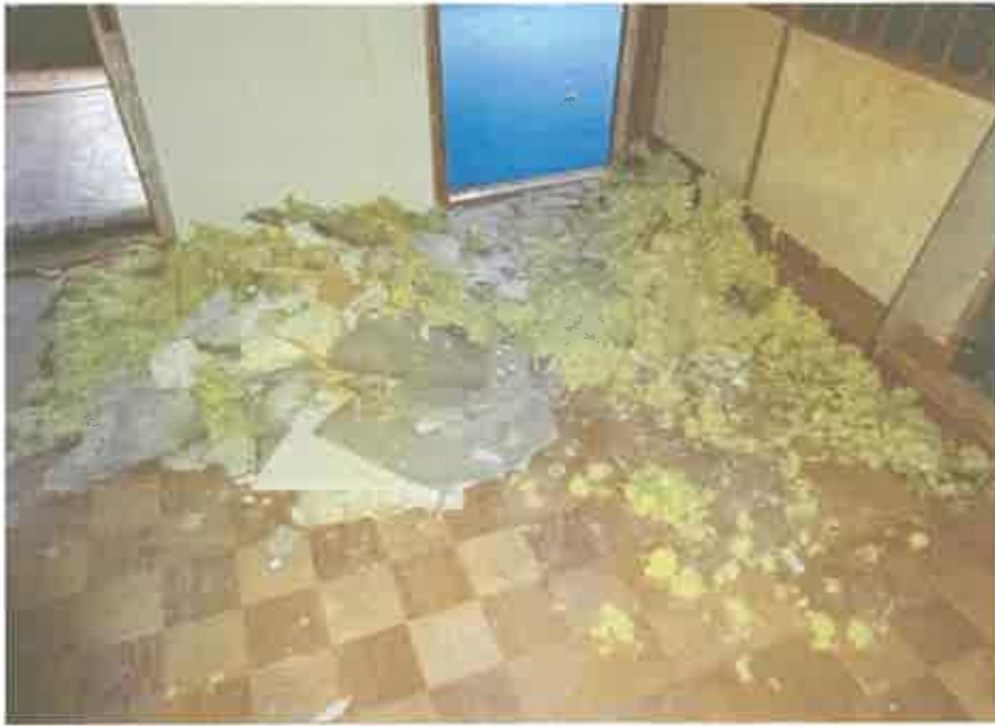
1階居宅部分の居間の床に断熱材が落下している状況
