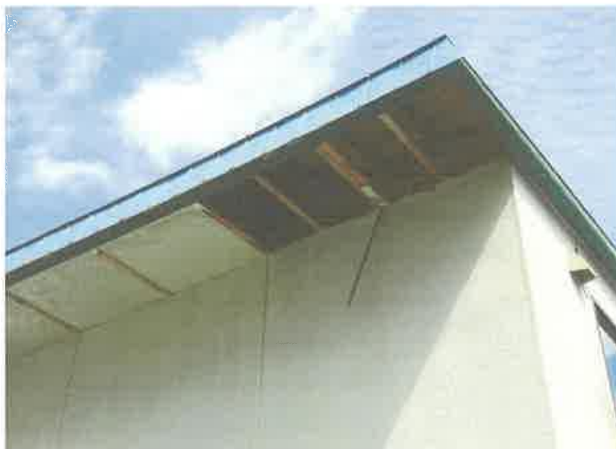
北西側軒天の損傷状況
