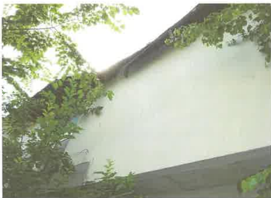
南東側軒天の損傷状況
