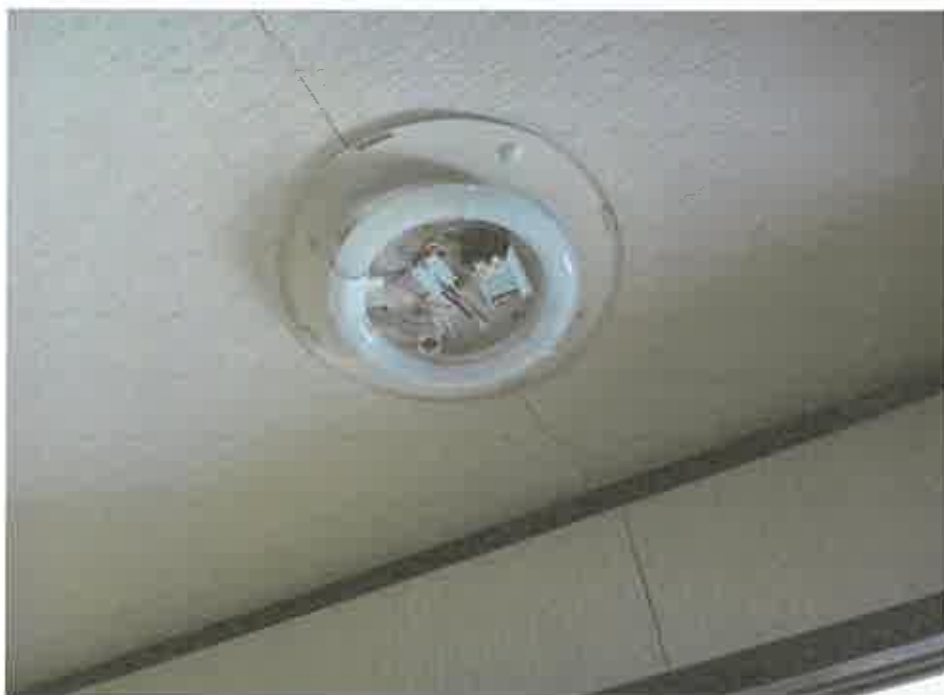
2階廊下天井クロスの亀裂
