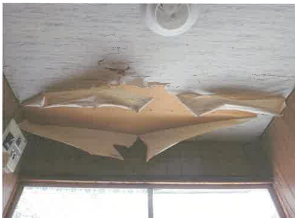
1階玄関の天井クロスの損傷
