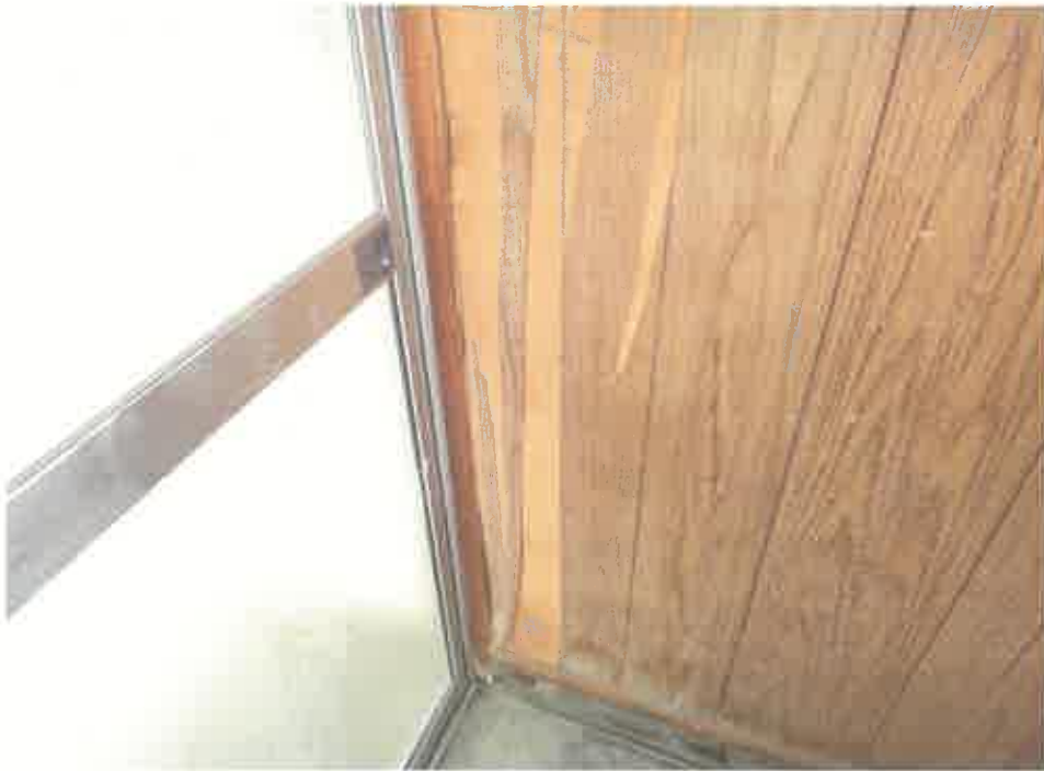
1階玄関の壁材の損傷
