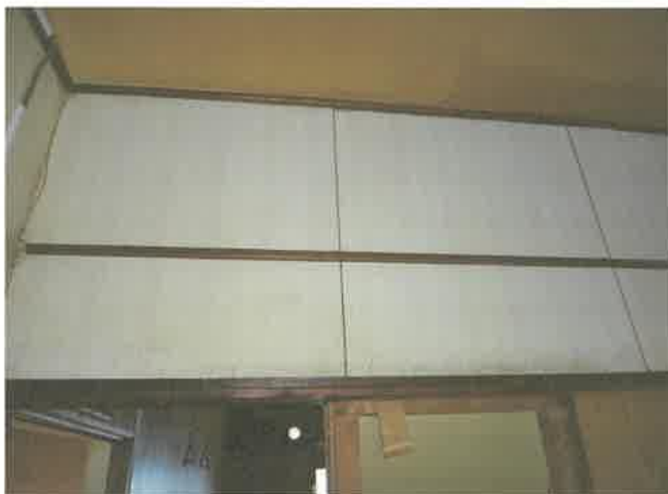
1 階洋室の壁クロスの劣化
