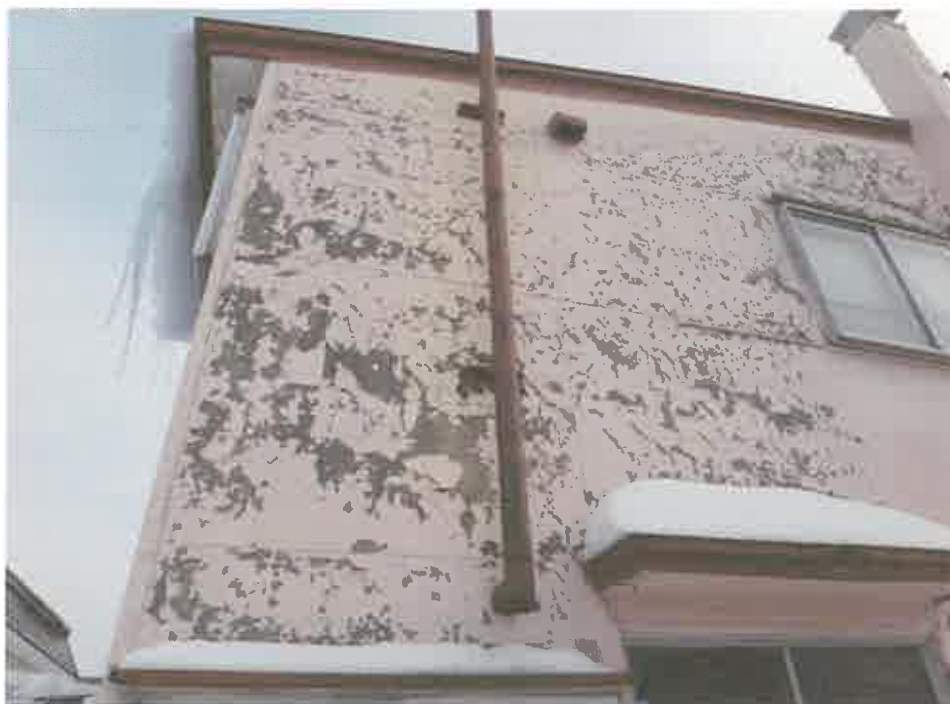
外壁塗膜の劣化
