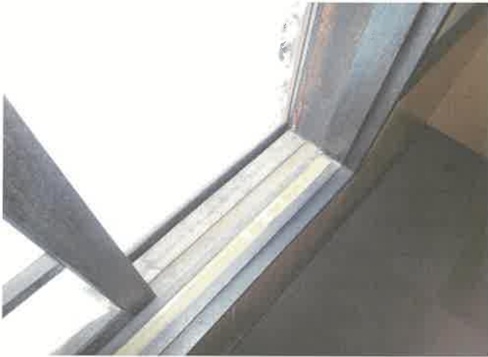
2階座敷席の窓枠の劣化
