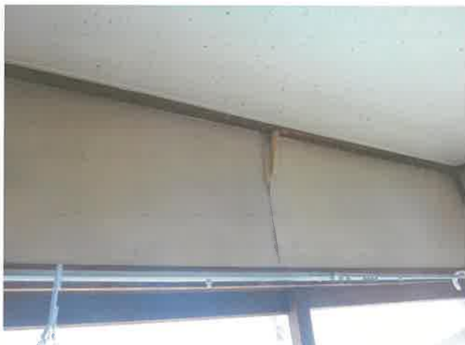
2階居間の壁クロスの剥離
