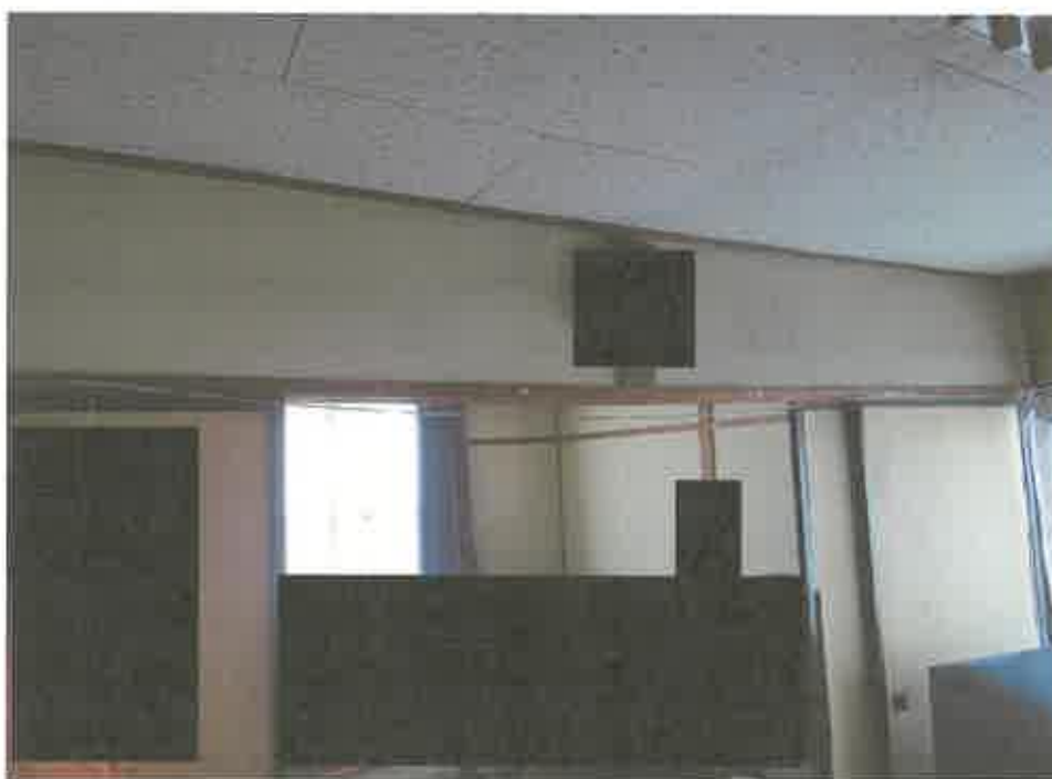
2階居間の梁の歪み
