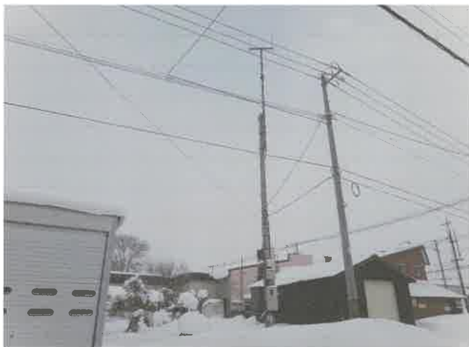
ソフトバンク株式会社の電柱（電気通信設備）（左側）
