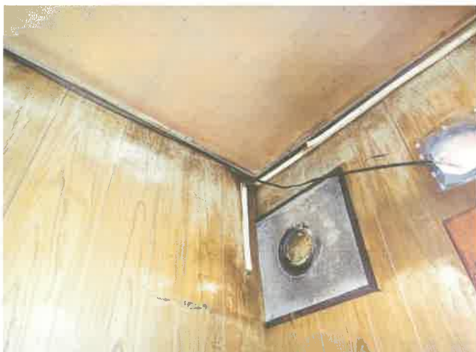
1 階台所天井付近の汚損
