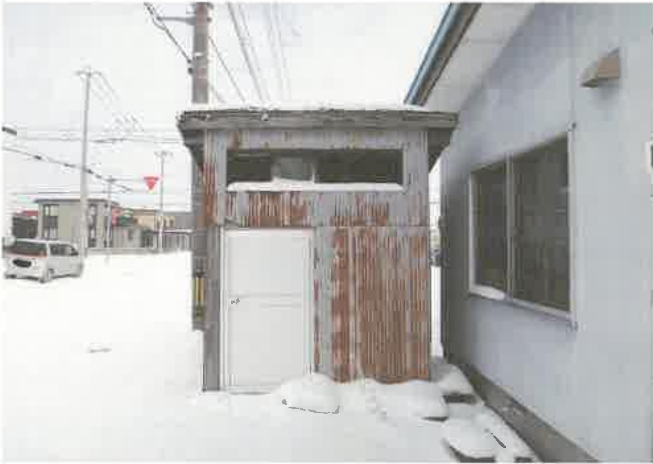
物件2の土地にある目的外木造仮設物置
