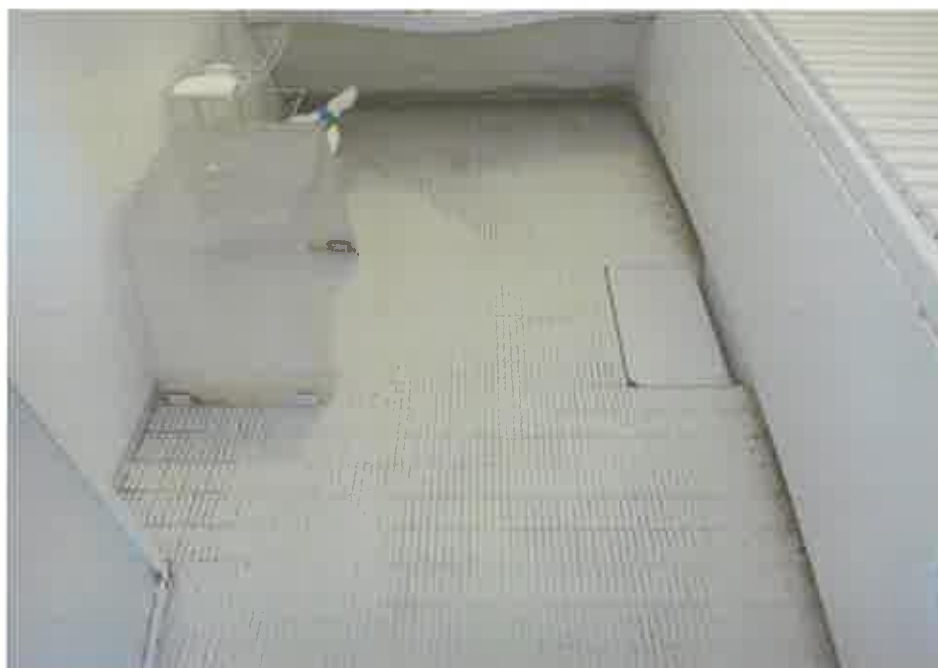
1階浴室の床の汚損
