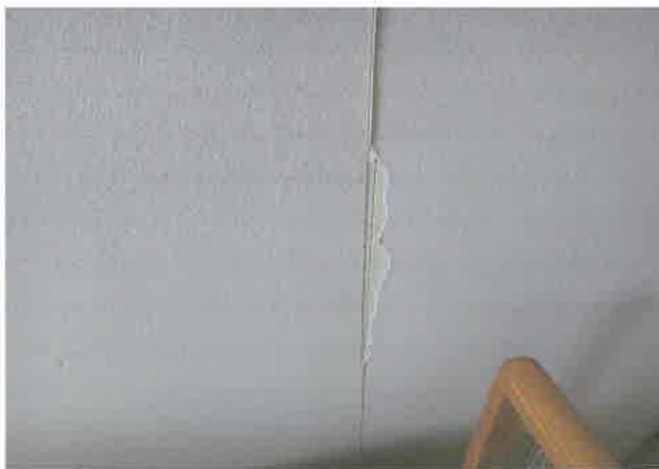
2階洋室2の壁クロス損傷
