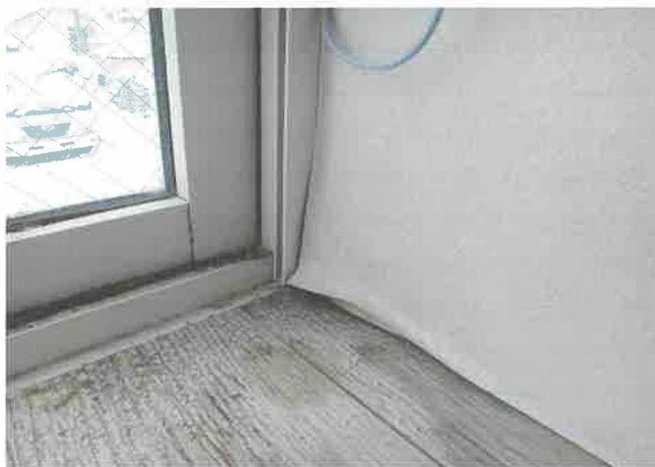
前同及び壁クロス剥離
