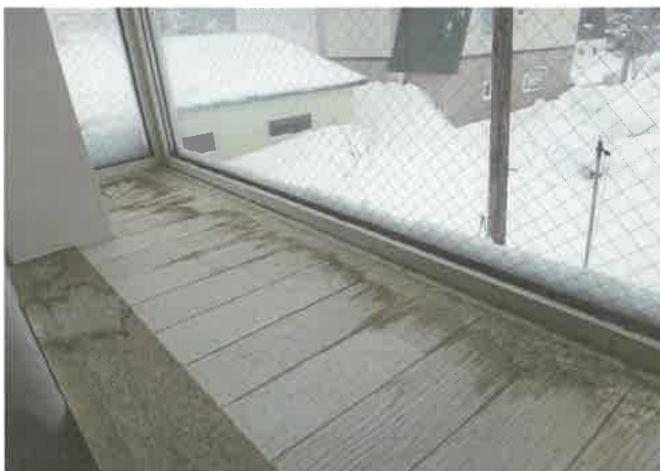
2階洋室2の出窓部分の劣化、カビによる窓枠の汚損
