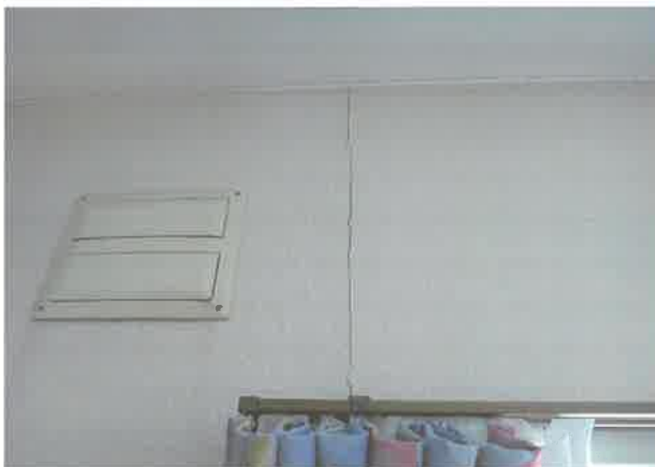
2階洋室1の壁クロスの亀裂
