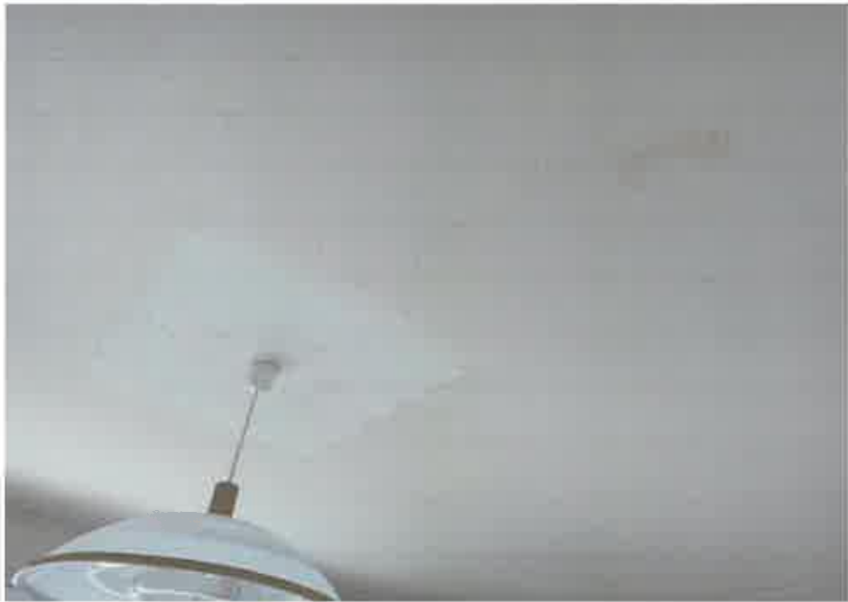
105号室の天井クロスの汚損
