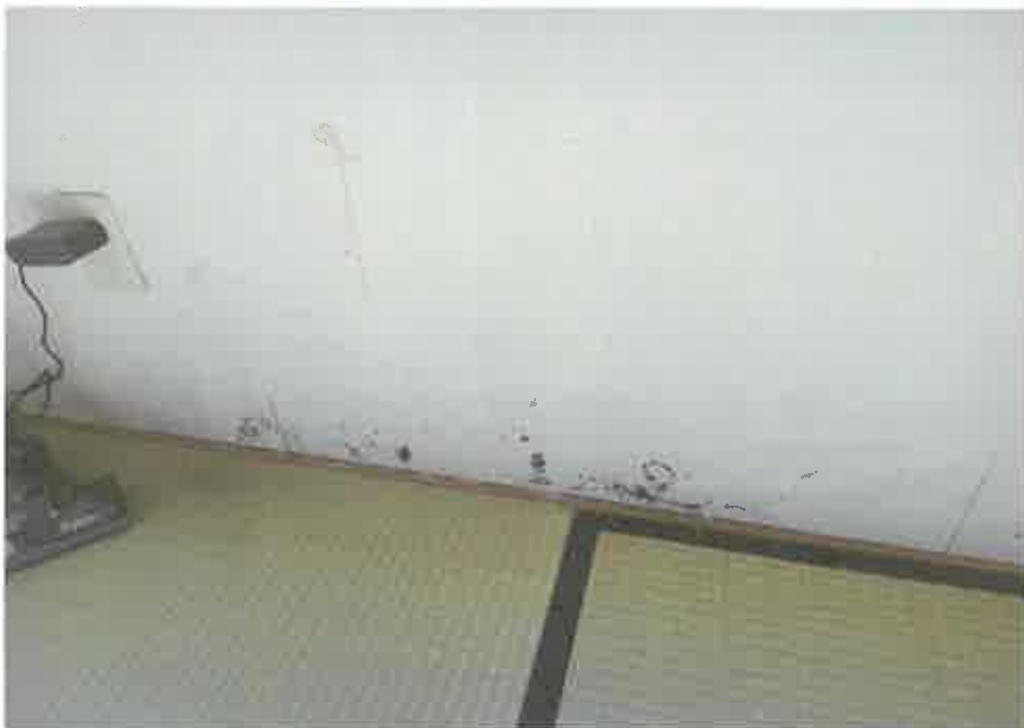
107号室の和室の壁クロスの汚損
