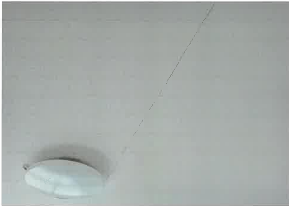
207号室の天井クロスの亀裂
