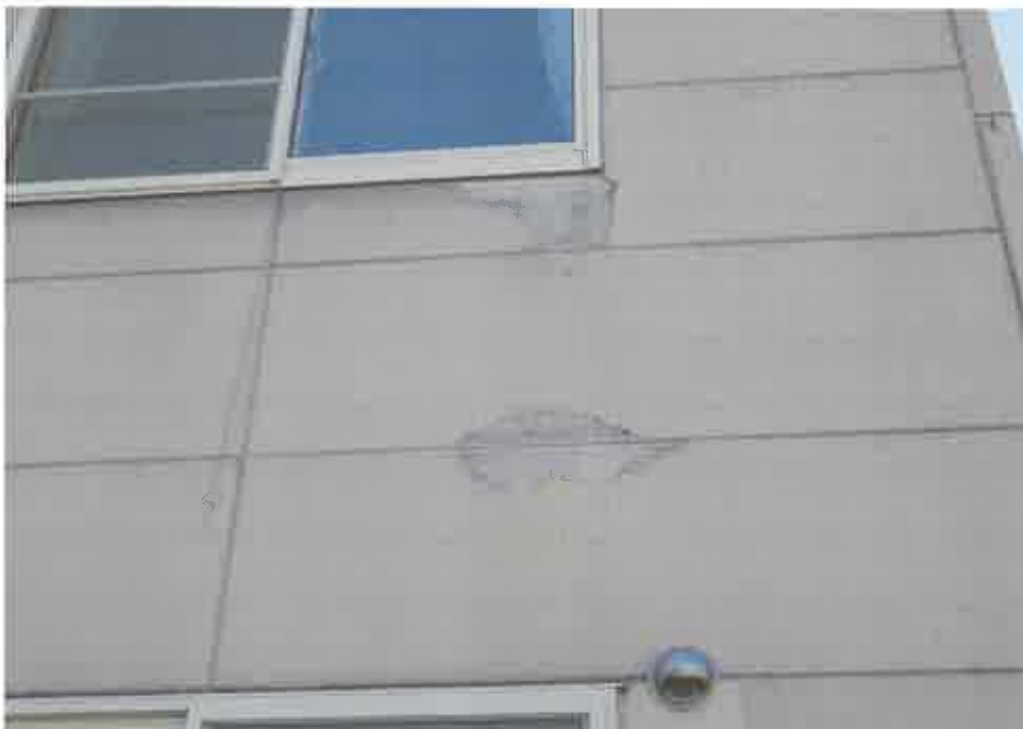
物件 7 の建物の外壁の損傷
