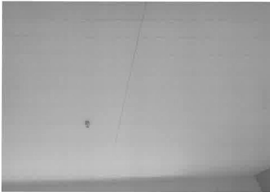
205号室の天井クロスの亀裂
