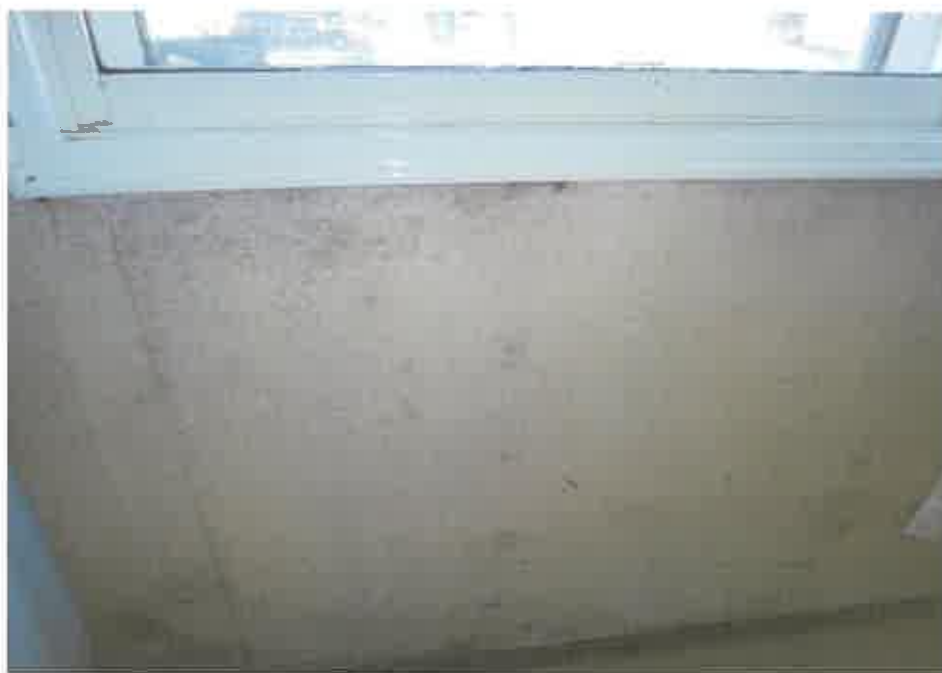
102号室の洋室1の壁クロスのカビによる汚損
