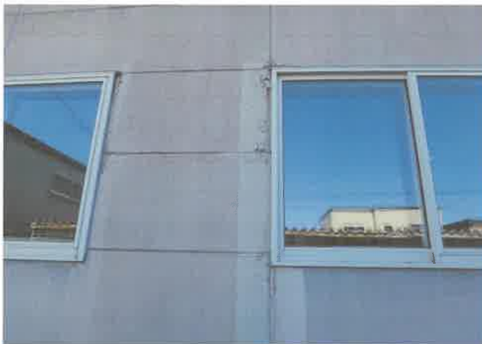
物件 6 の建物の外壁の劣化
