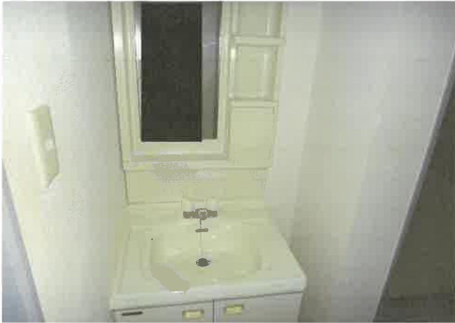
101号室の脱衣室内の洗面台
