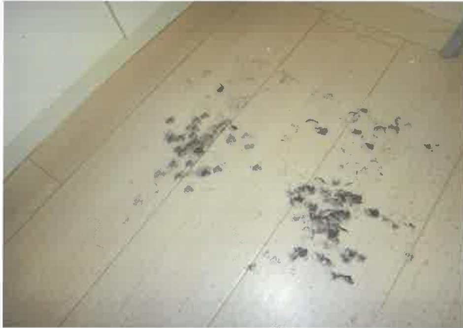
107号室の脱衣室の床の汚損
