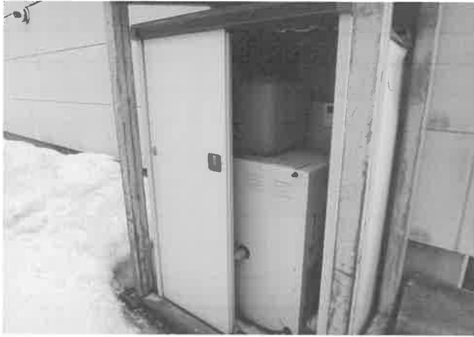
スチール製仮設ボイラー庫
