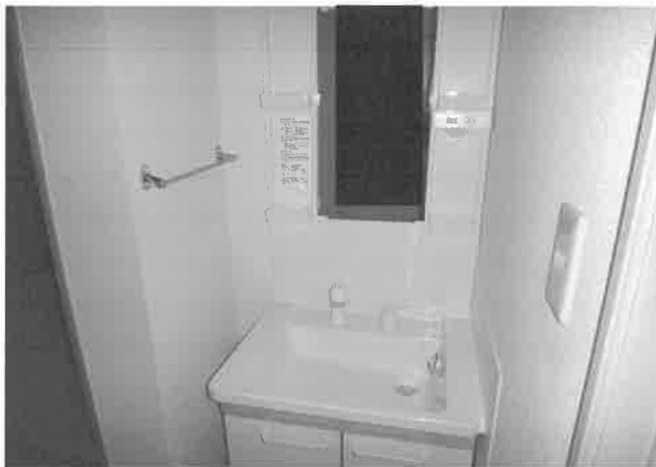
105号室の脱衣室内の洗面台
