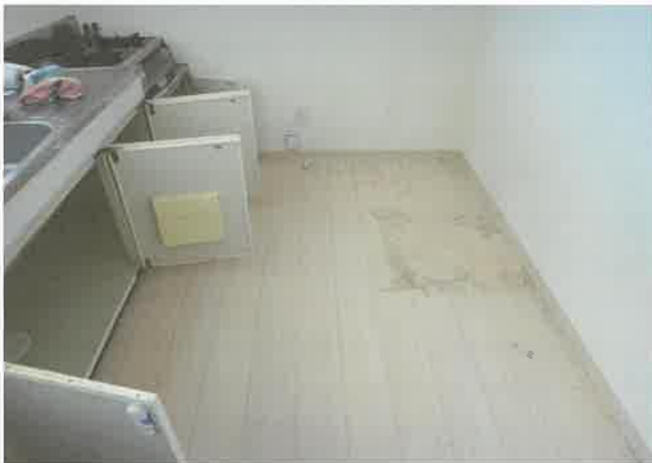
107号室の台所の床の汚損
