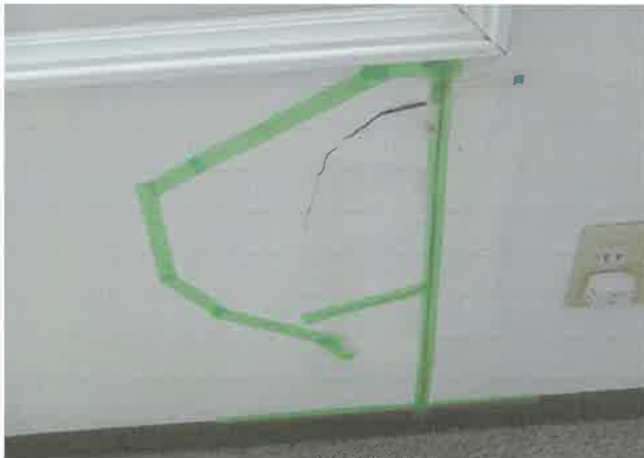
207号室の居間の壁クロスの損傷
