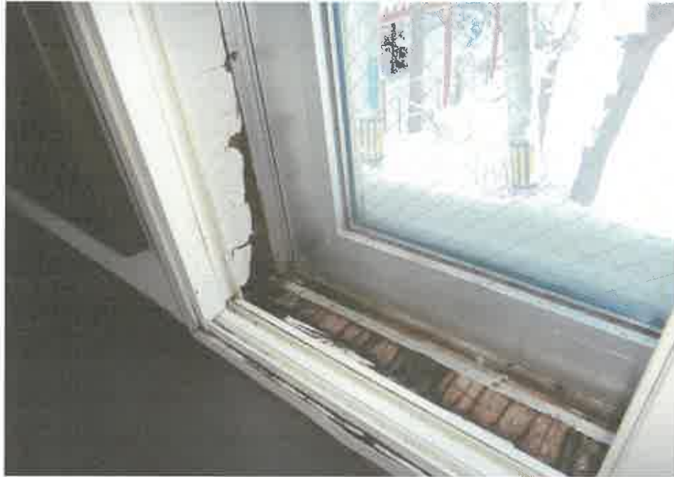
2階寢室の窓枠の劣化
