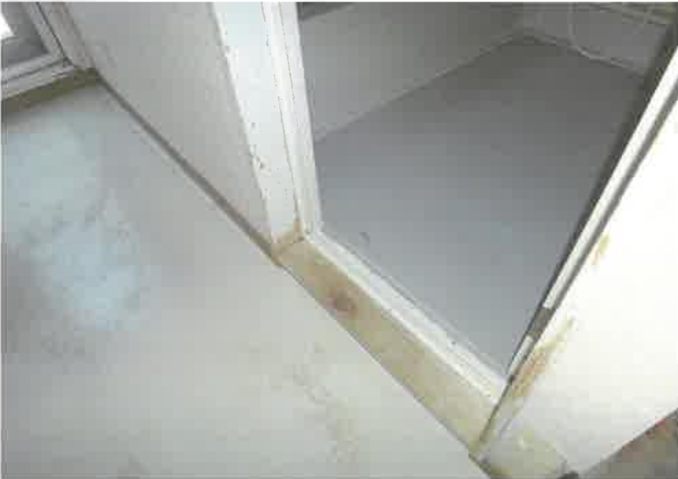
2階浴室前の床及び壁面の劣化
