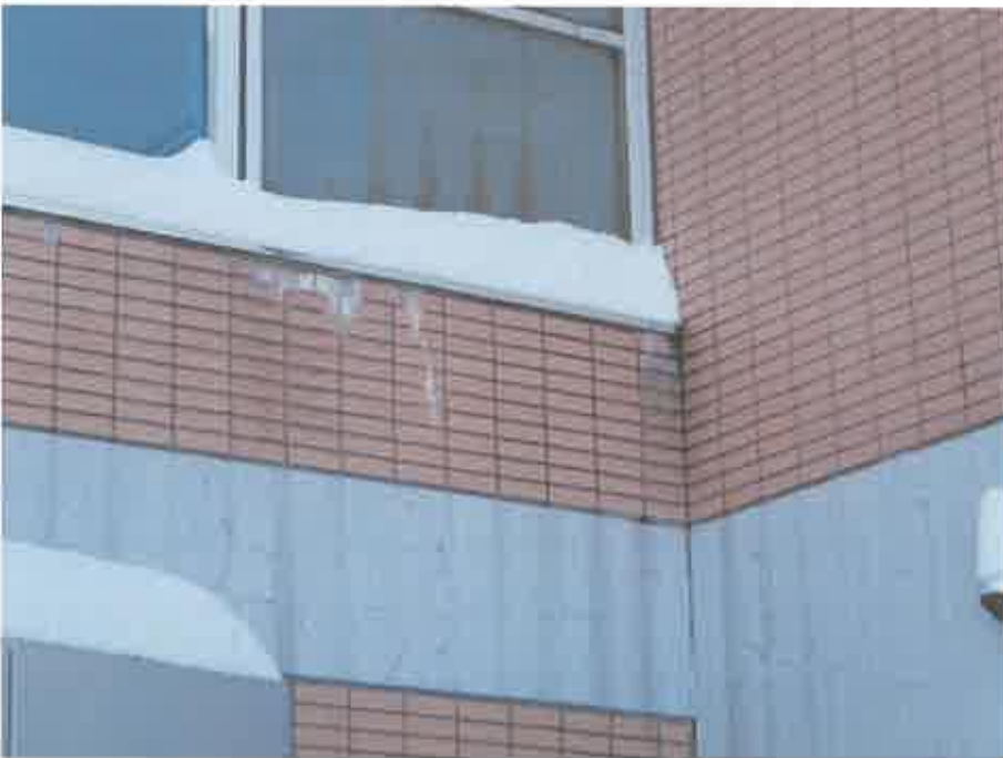
外壁の一部の劣化
