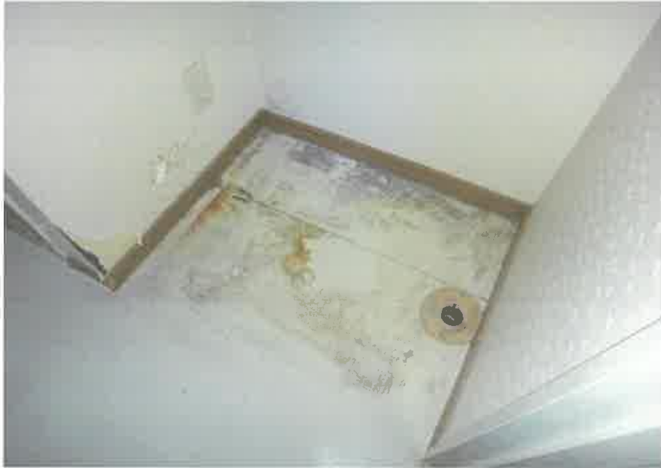
2階ユーティリティ内の床の汚損
