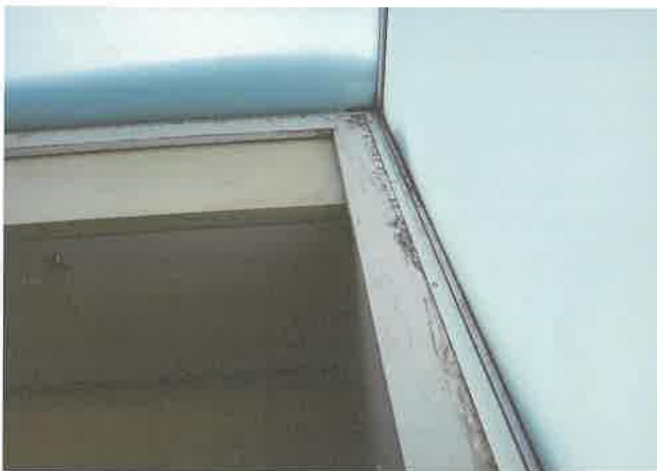
2階居間の窓付近の枠の劣化
