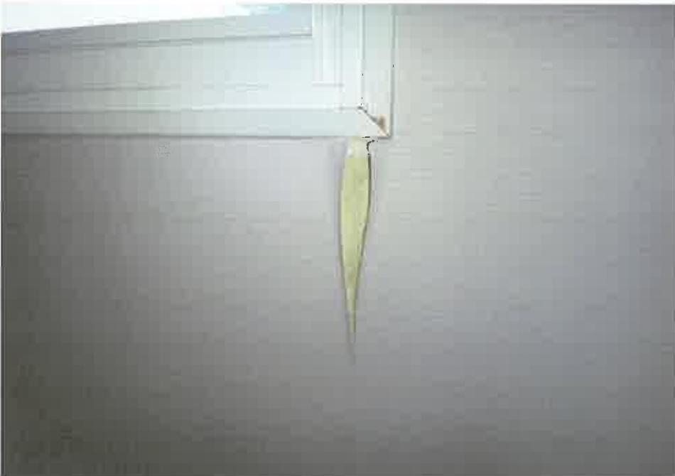
2階寢室の壁クロスの剥離
