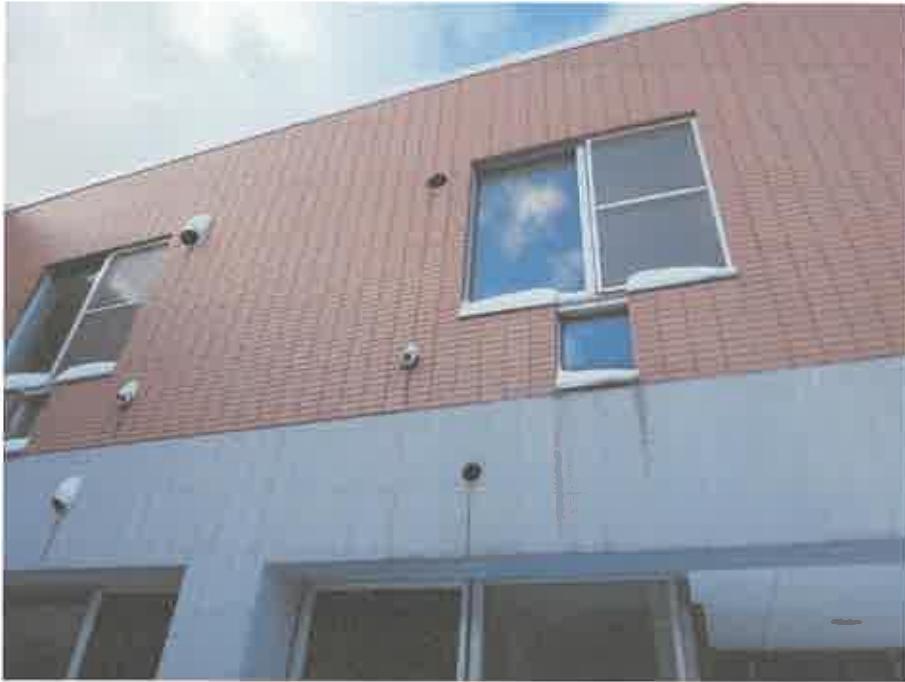
外壁に設置された通気口カバーの欠損
