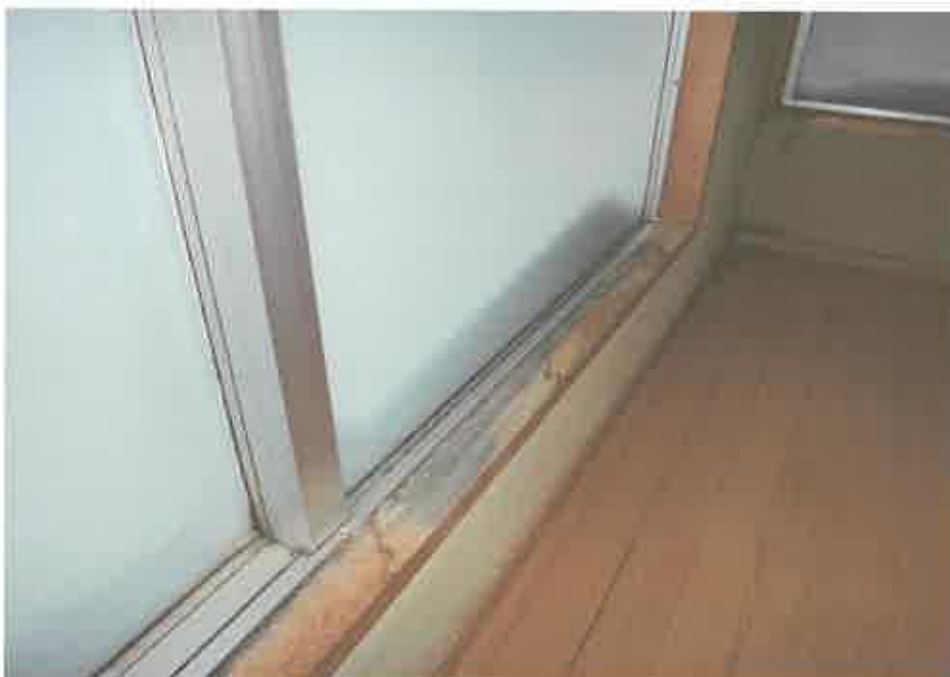
2階和室前広縁付近の劣化
