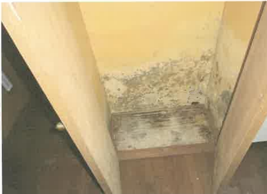
1 1 1 号室の物入内部に黒カビが発生している状況
