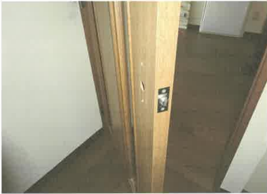
303号室の居間のドアノブが外されている状況
