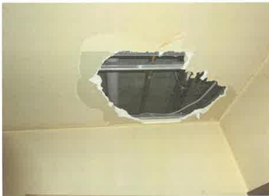
106号室の天井に穴が開いている状況
