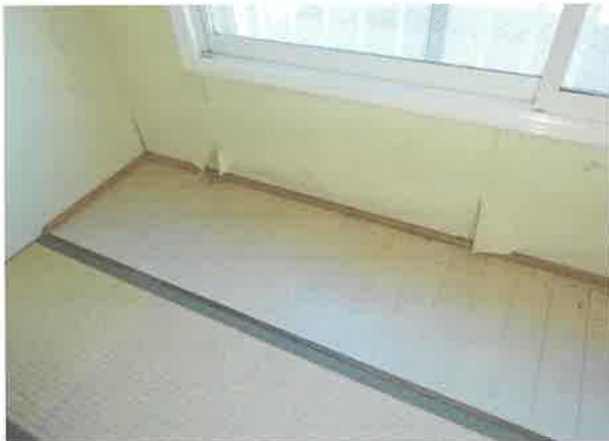
207号室の和室の窓枠下の壁紙が剥離している状況
