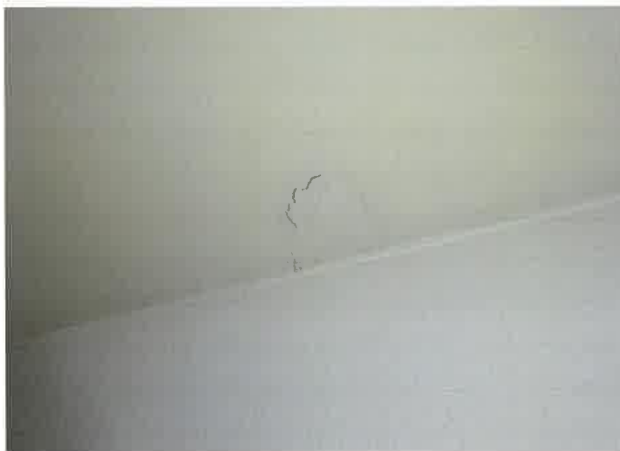
3 0 8 号室の居間の天井に穴が開いている状況
