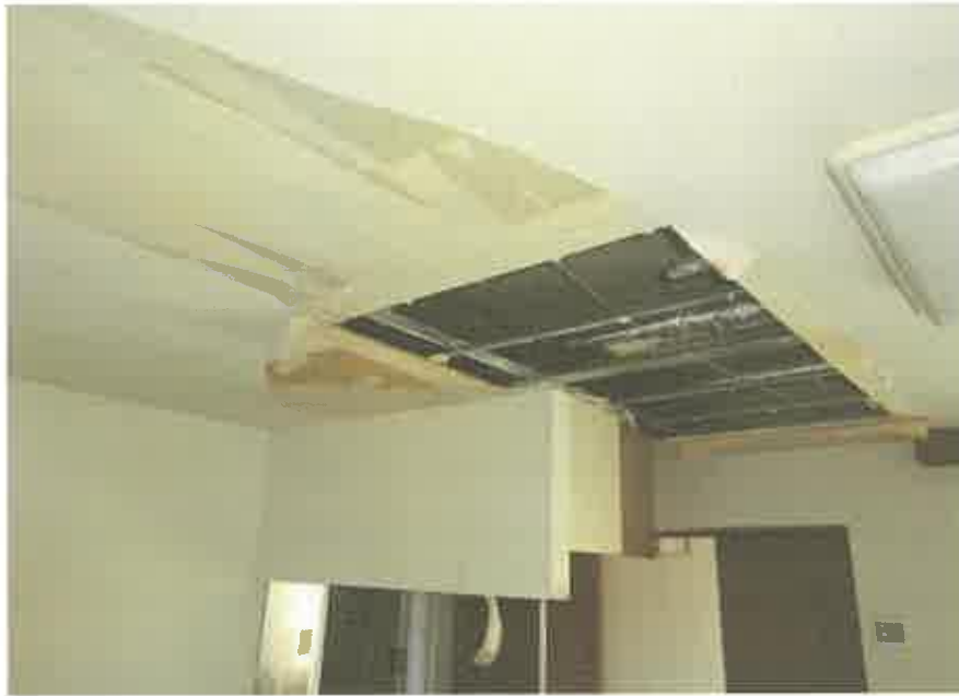
202号室の天井に大穴が開いている状況
