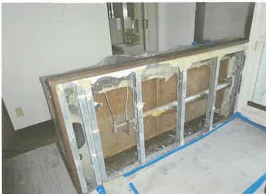
1 1 1 号室の居間と台所の間の仕切り壁が破損している状況
