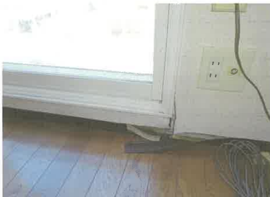
3 0 7 号室の居間の窓枠下の壁紙の剥離状況
