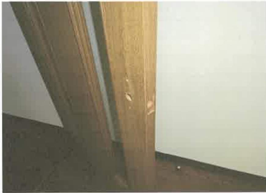
108号室の居間に通じるドアのドアノブが外されている状況
