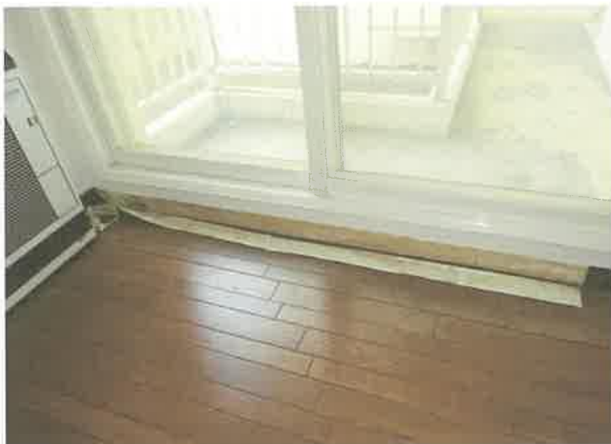
108号室の居間の窓枠下の壁紙の剥離状況
