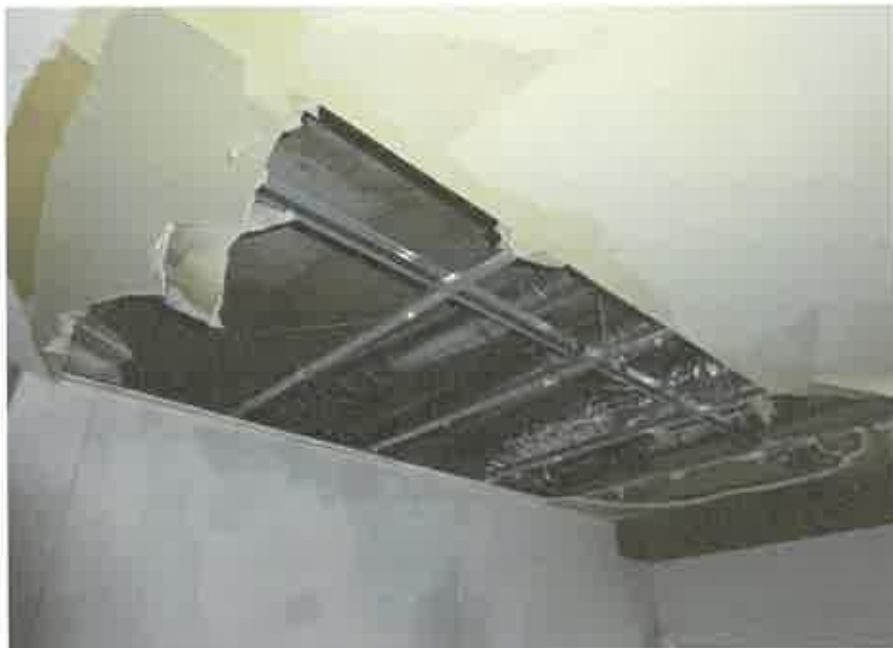
111号室の居間の天井に大穴が開いている状況
