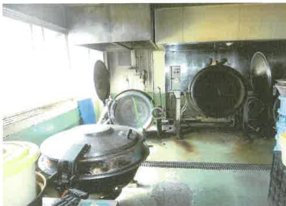
同上（写真手前及びその奥に大型釜、奥の右側は回転窯）
