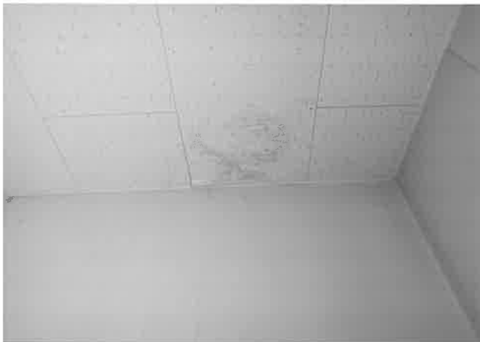
本件建物 4 階のホール天井の雨漏り跡
