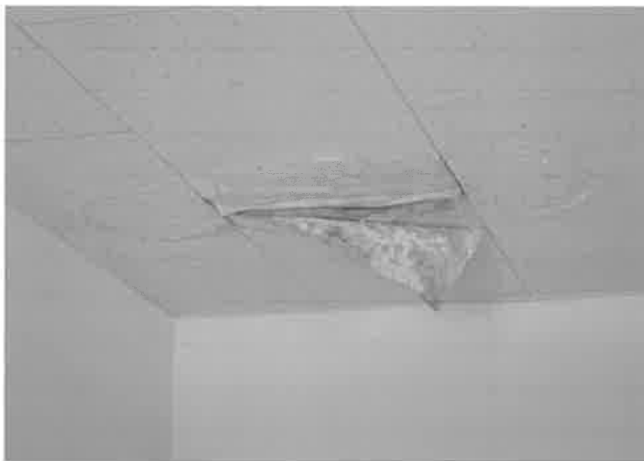
本件建物 4 階の階段部分天井の損傷
