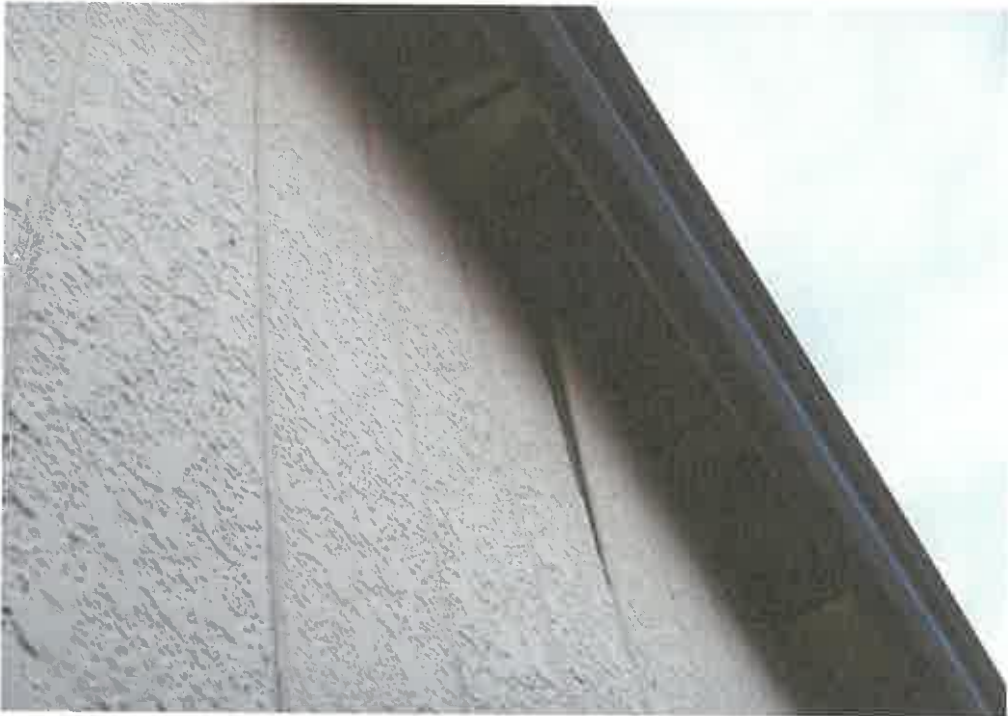
未登記附属建物（車庫）の外壁の損傷
