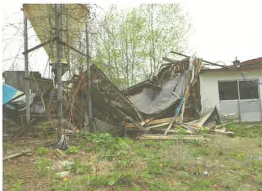
物件 1 2 建物の倒壊状況
