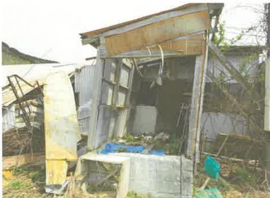
物件 1 2 建物符号 1 の畜舎の残存部分の状況
