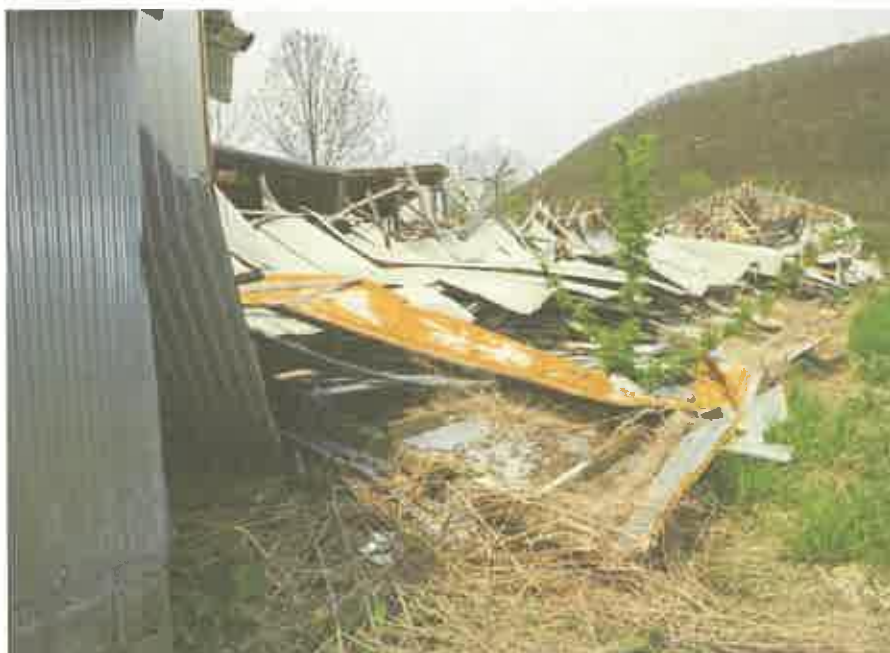
物件 1 2 建物の倒壊状況
