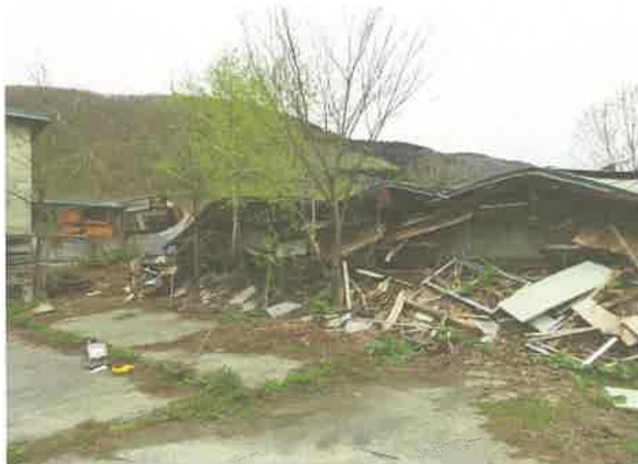
物件1 2建物の倒壊状況
