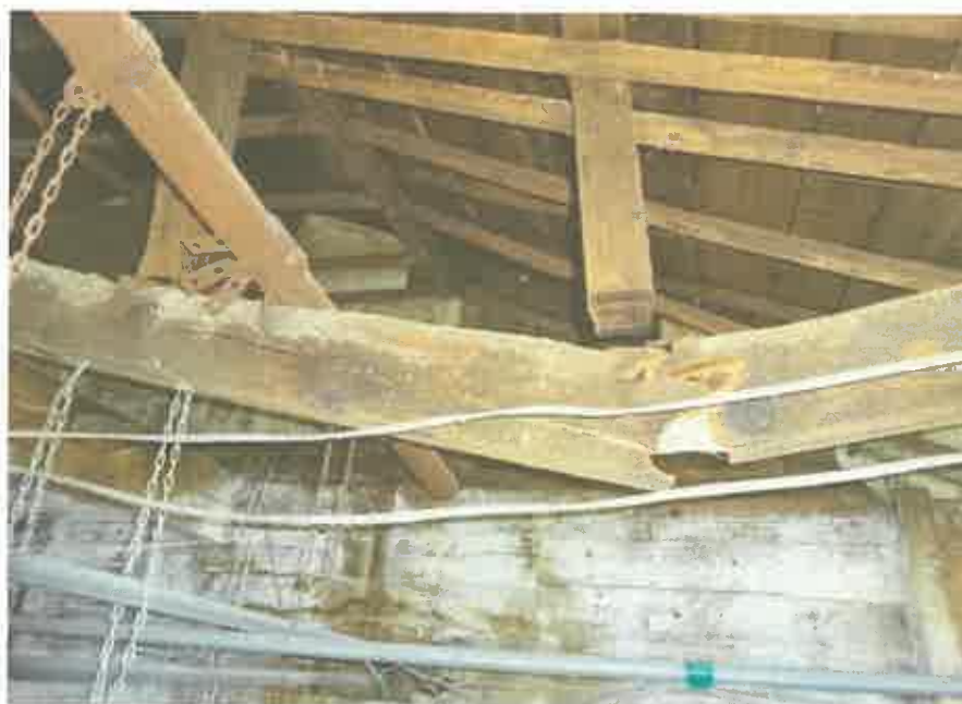
物件1 2 建物の未登記附属建物①の内部の状況 (略南東側の倉庫部分の屋根の骨組みの損傷状況)
