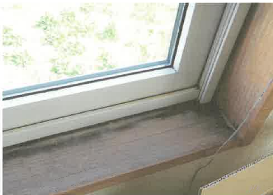
2階和室2の窓枠付近の劣化及び黒カビによる汚損
