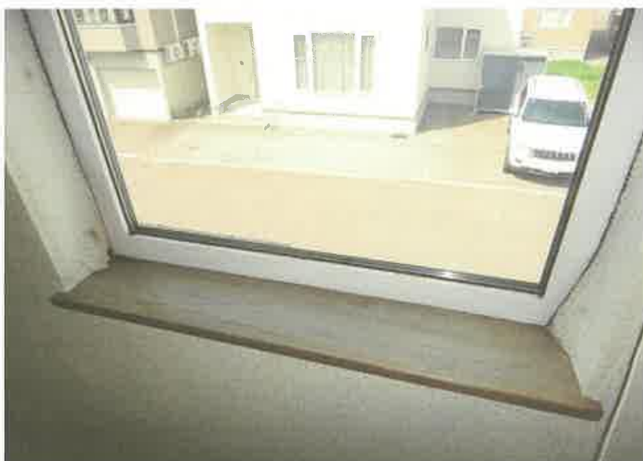
階段の窓枠付近の劣化、壁クロスの剥離及び黒カビによる汚損
