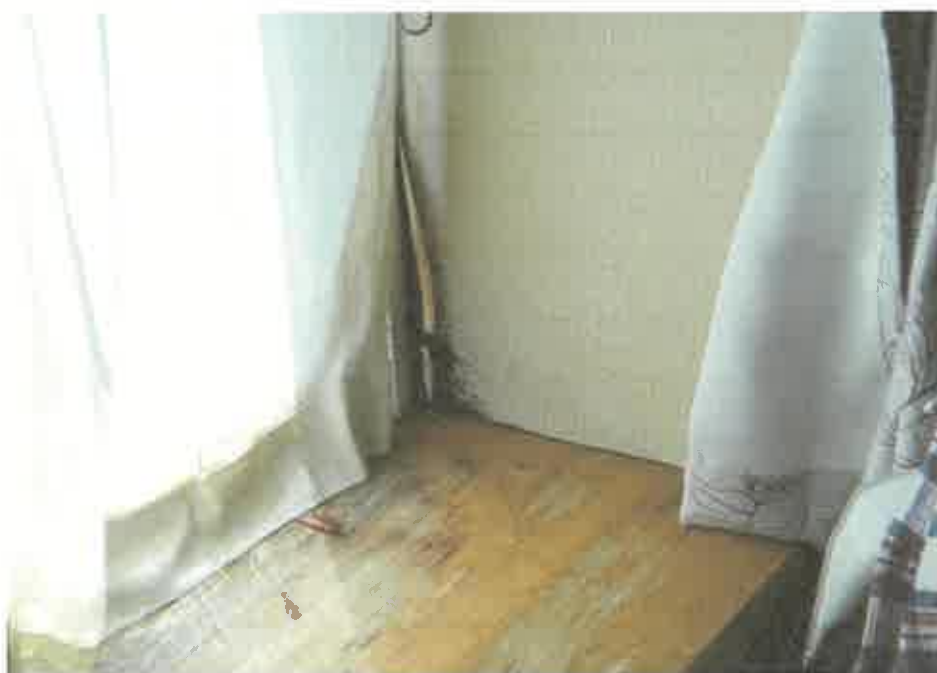
1 階台所の窓枠付近の劣化及び黒カビによる汚損
