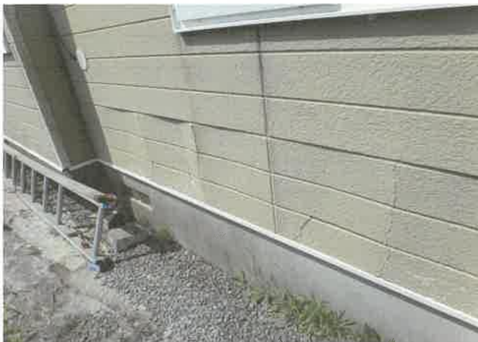
略南側外壁の一部の凹み及びひび割れ
