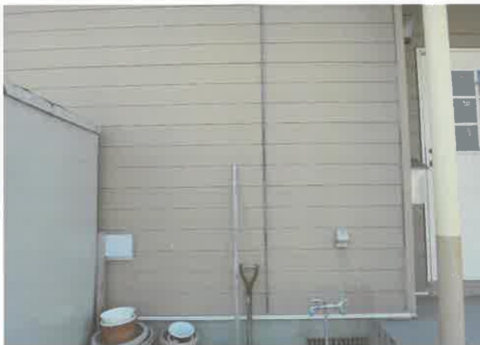
外壁コーキングの劣化
