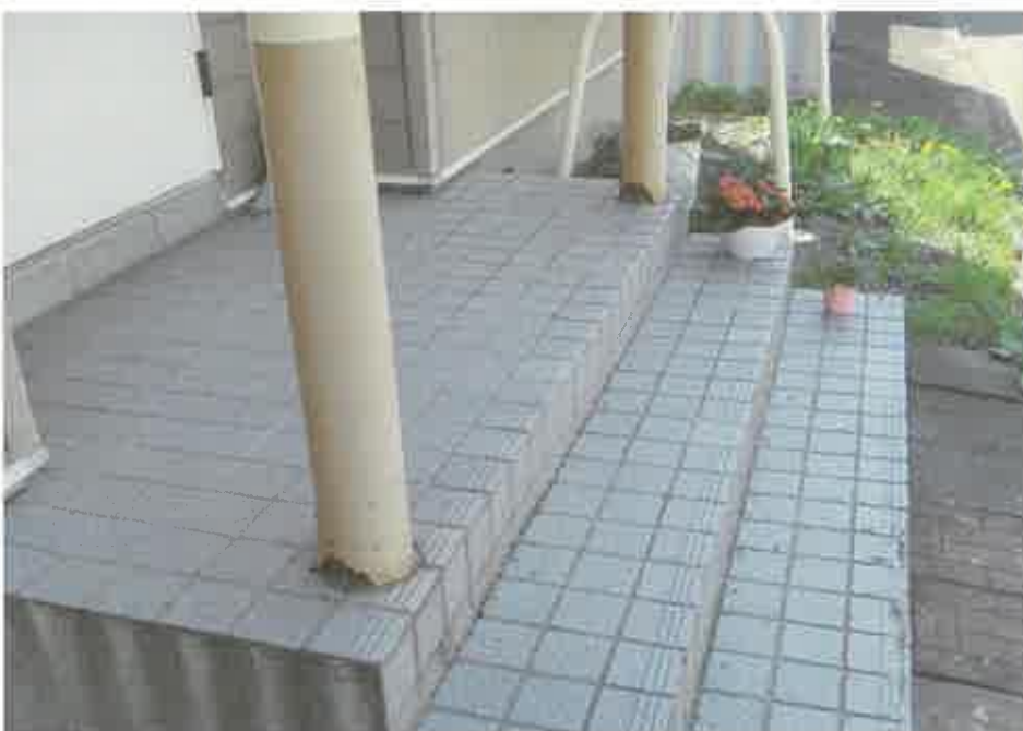
1 階屋外ポーチの支柱の劣化
