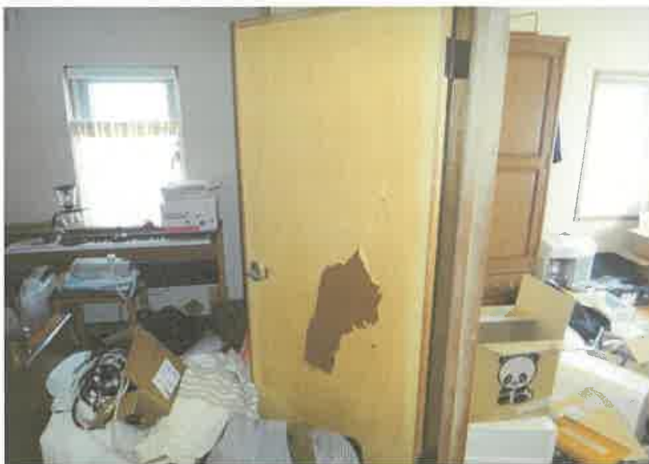
2階和室2のドアのクロスの損傷
