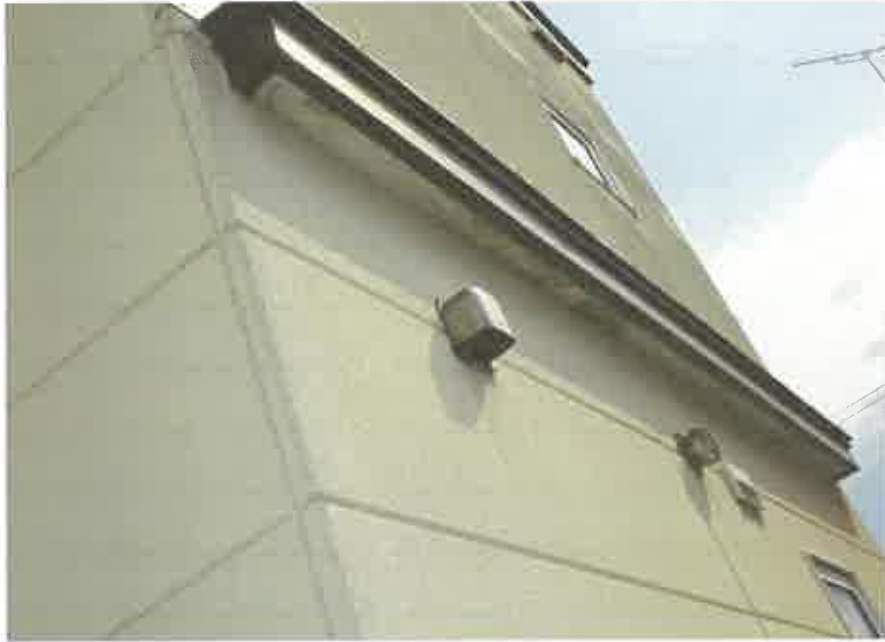
軒天の損傷状況
