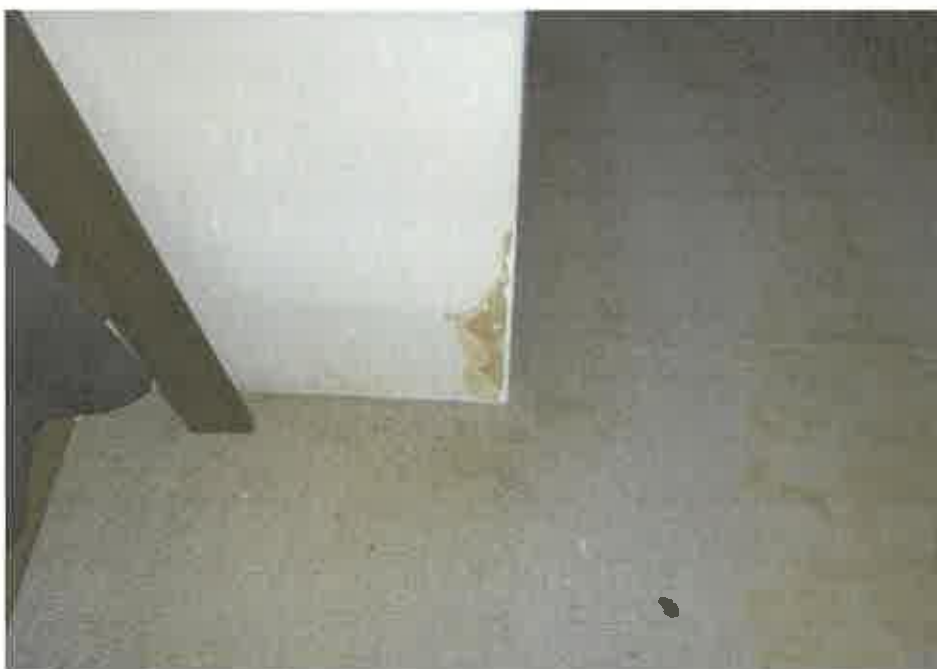
台所前の壁面の損傷
