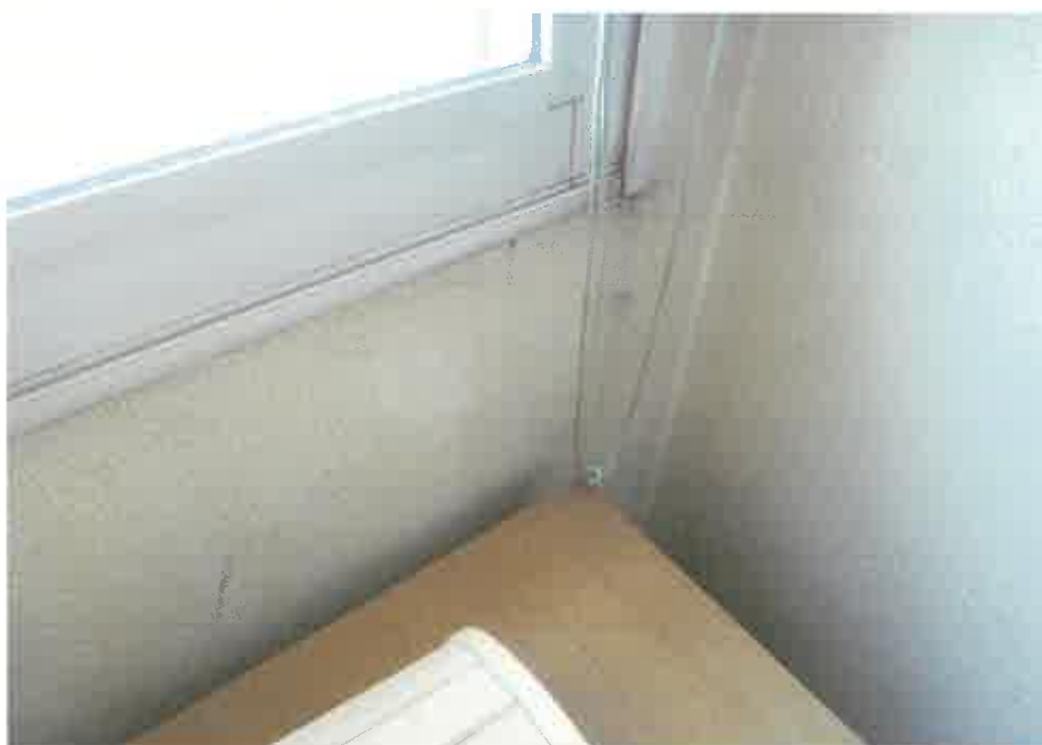
洋室1の壁クロスの黒カビが原因と思われる汚損
