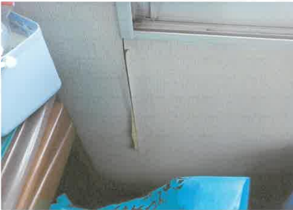
洋室 2 の壁クロスの剥離
