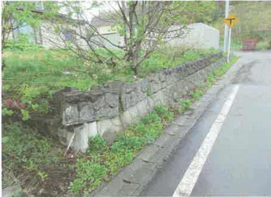
物件1土地の略南側コンクリートブロック擁壁の損傷状況
