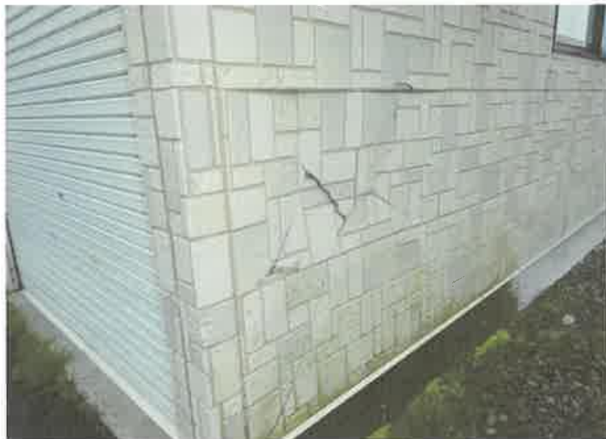
車庫横の外壁の損傷状況
