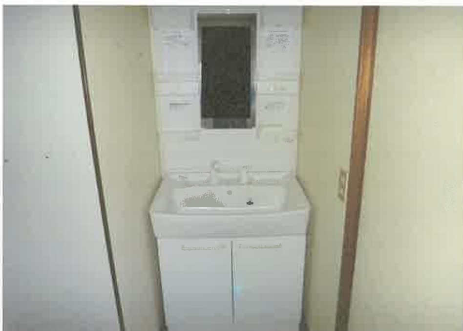
2階ユーティリティ内の洗面台
