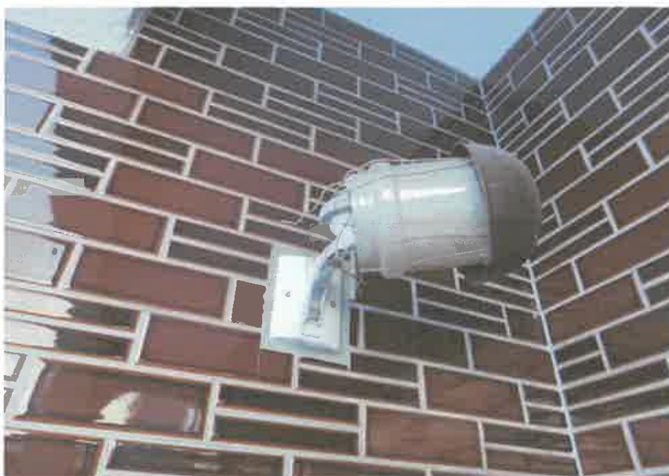
玄関灯の損傷
