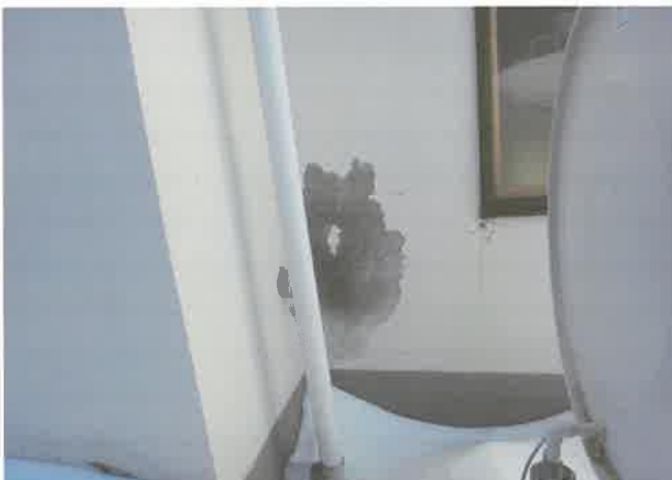
外壁の一部剥離
