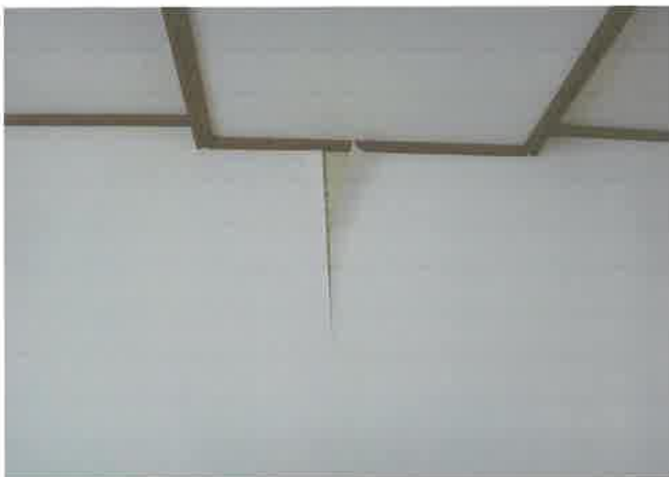
3階洋室3の壁クロスの剥離
