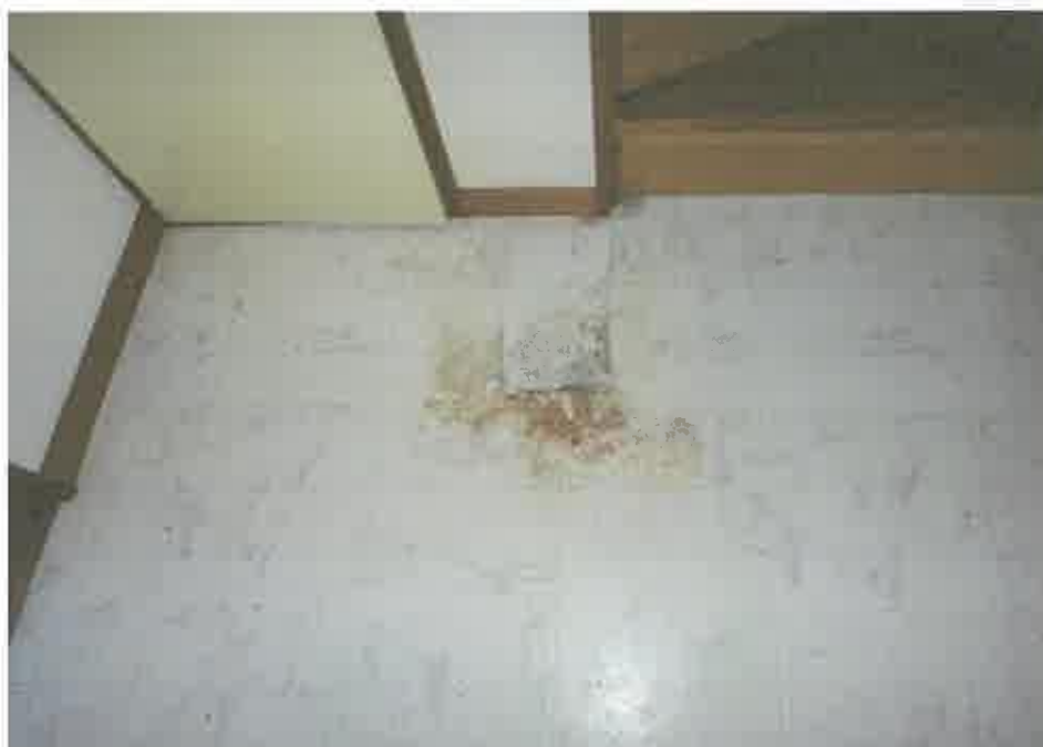
2 階台所付近の床の汚損
