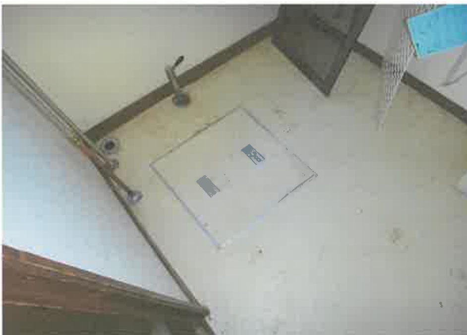
2 階ユーティリティ内の床の汚損
