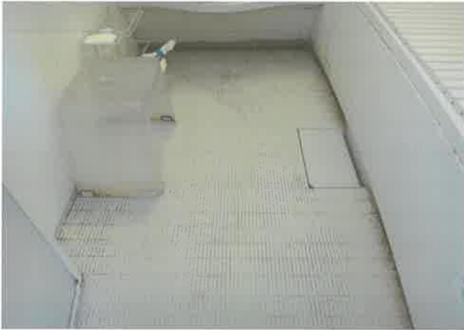
1 階浴室の床の汚損
