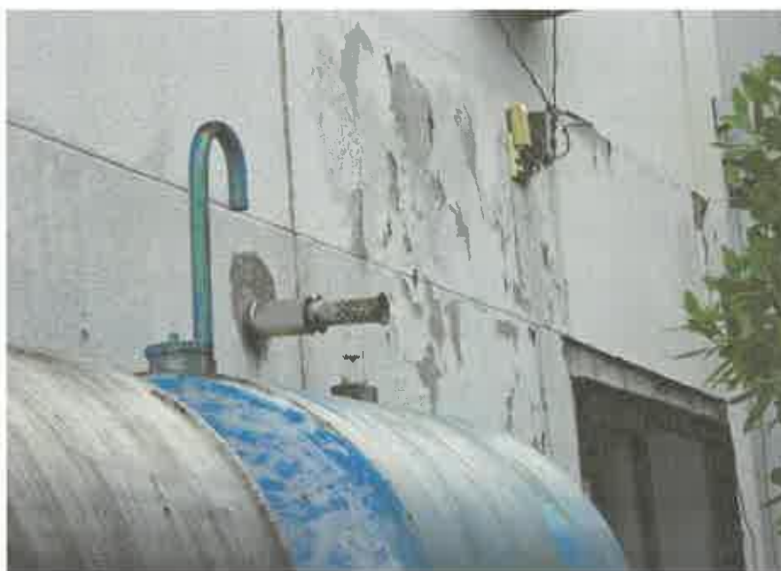
外壁塗装の剥離状況
