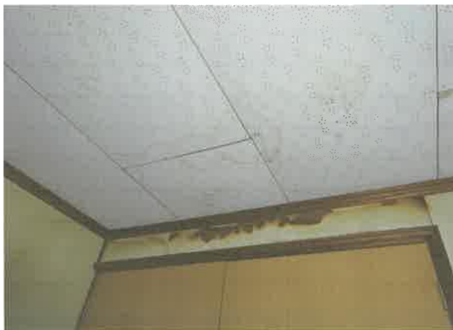
2 階洋室の天井付近の雨漏り跡
