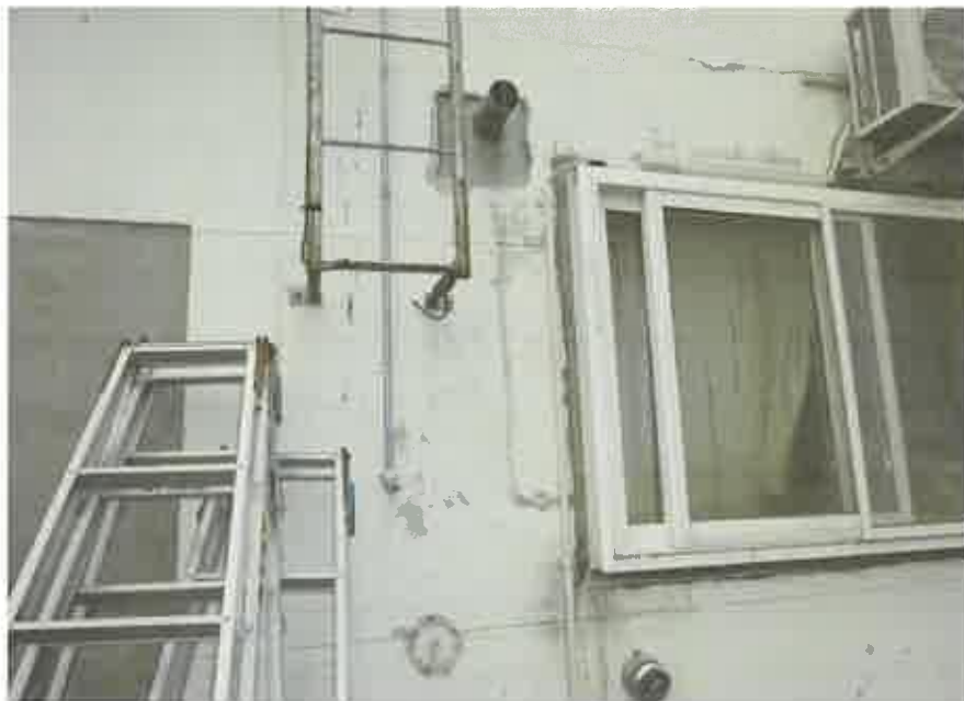
外壁塗装の剥離状況
