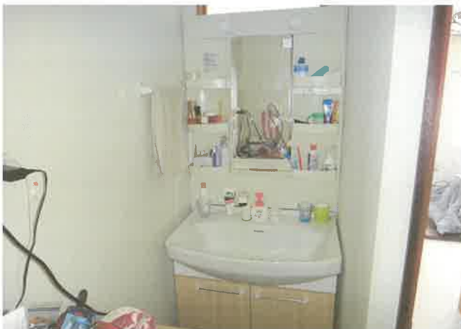
1階ユーティリティ内の洗面台
