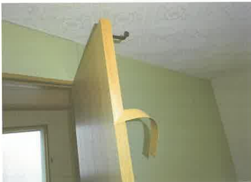
和室への入口ドアの損傷（101号室）
