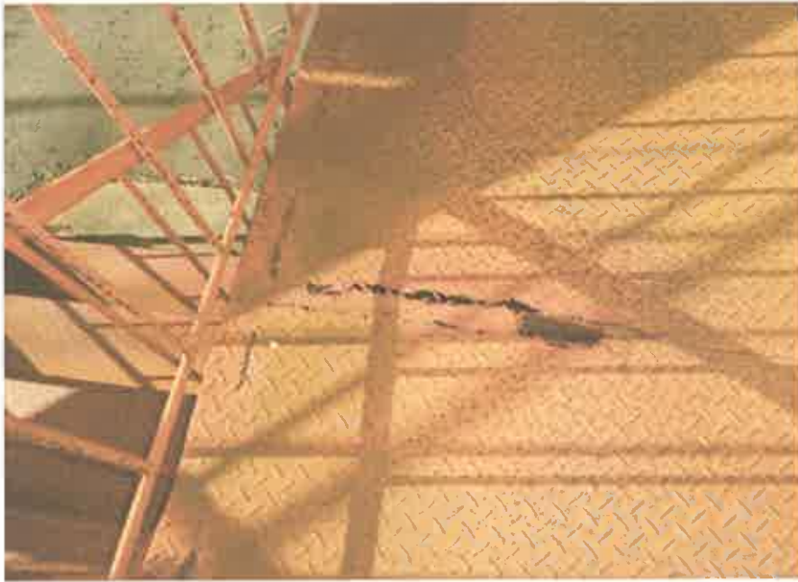
鉄骨製共用廊下の劣化状況
