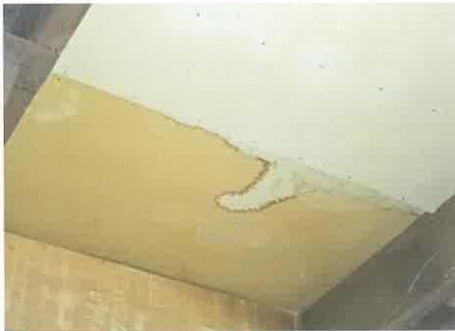
1 階倉庫・作業所の天井の雨漏り跡の状況
