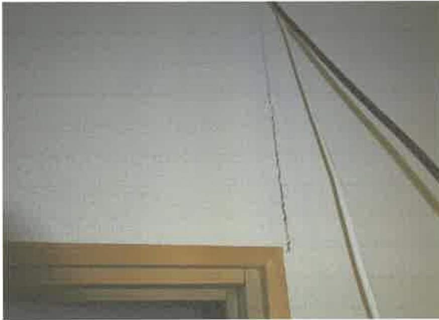
3 階居間の壁紙の亀裂
