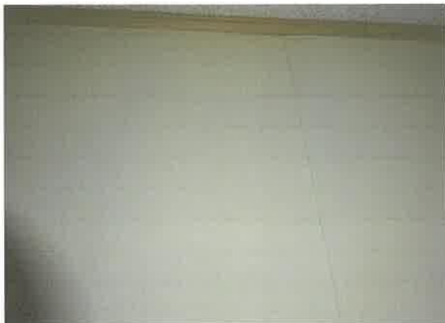
2 階台所上部の壁紙の亀裂
