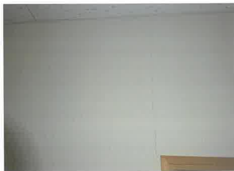
2 階の玄関から居間に通じるドア上部の壁紙の亀裂
