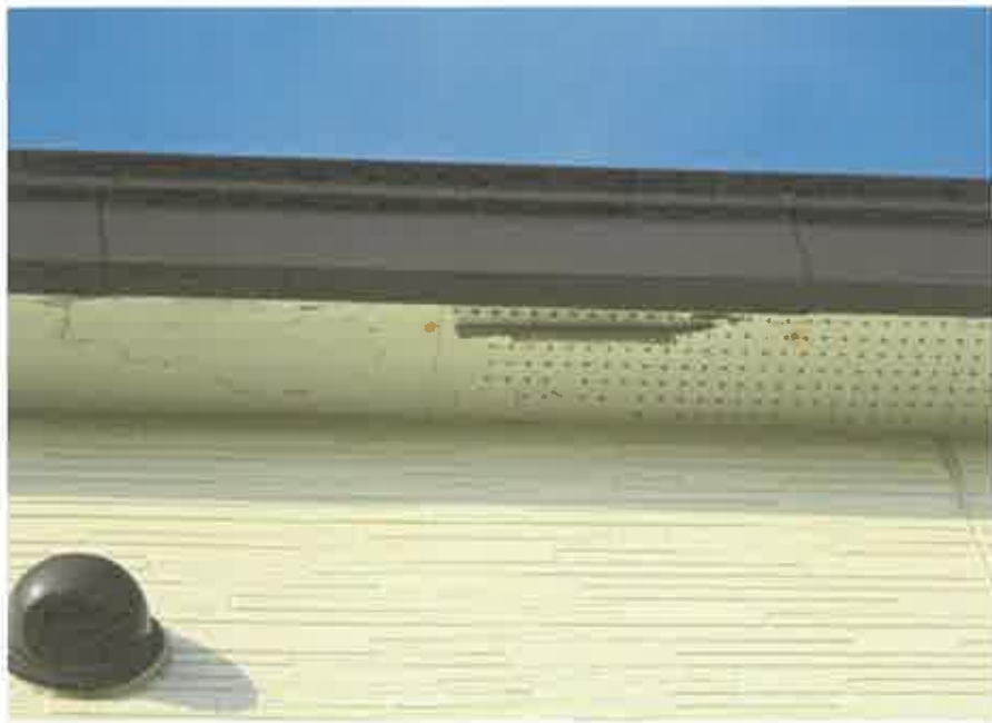
軒天の損傷状況
