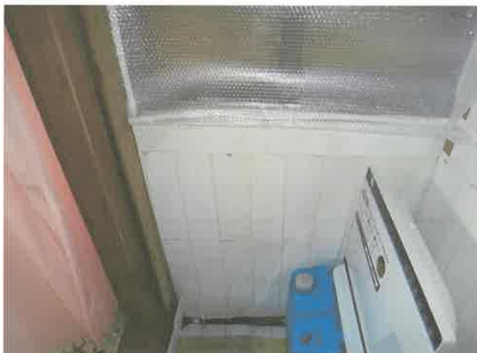
1 階浴室付近の内壁材の損傷（壁板がなくエアキャップ等で覆われている。）
