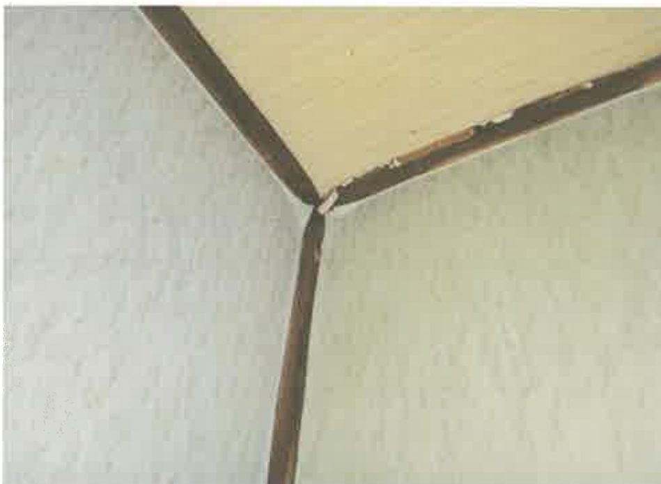
2階廊下天井クロスの剥離
