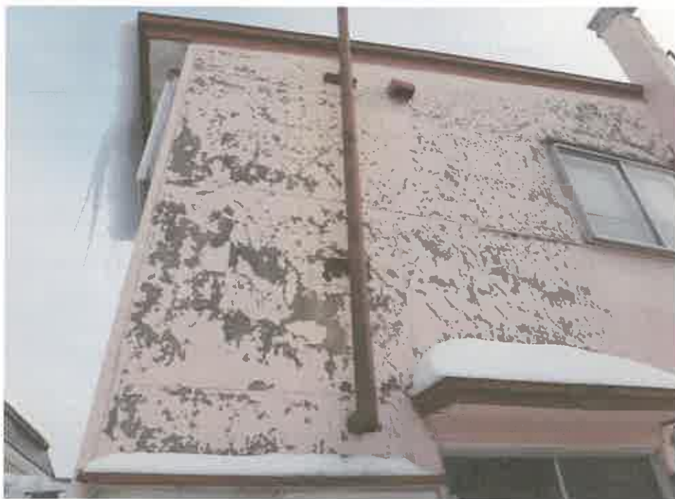
外壁塗膜の劣化
