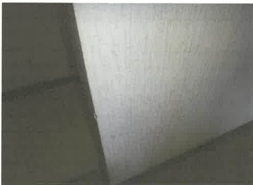
2階階段付近の壁クロス汚損
