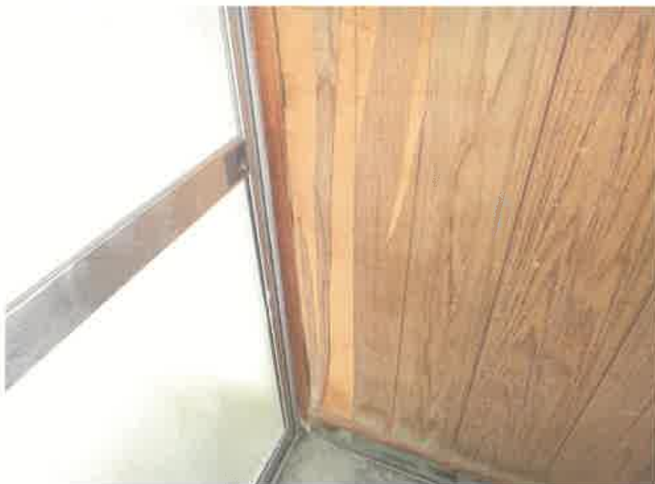
1 階玄関の壁材の損傷
