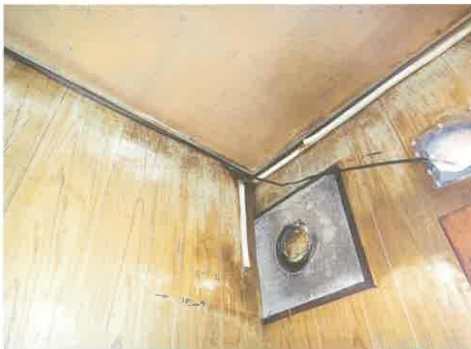
1 階台所天井付近の汚損
