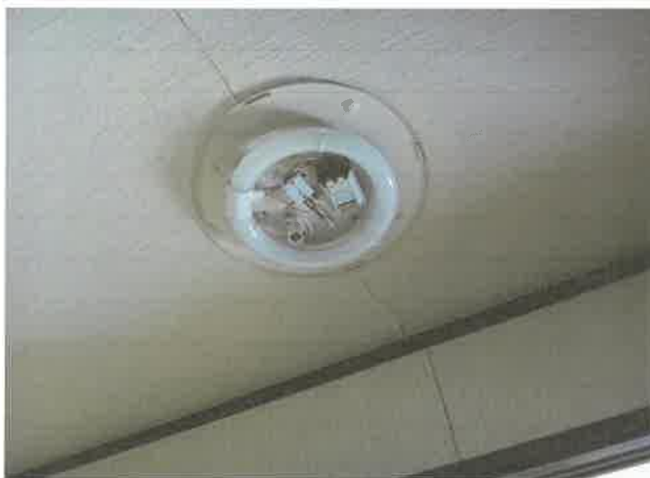
2階廊下天井クロスの亀裂
