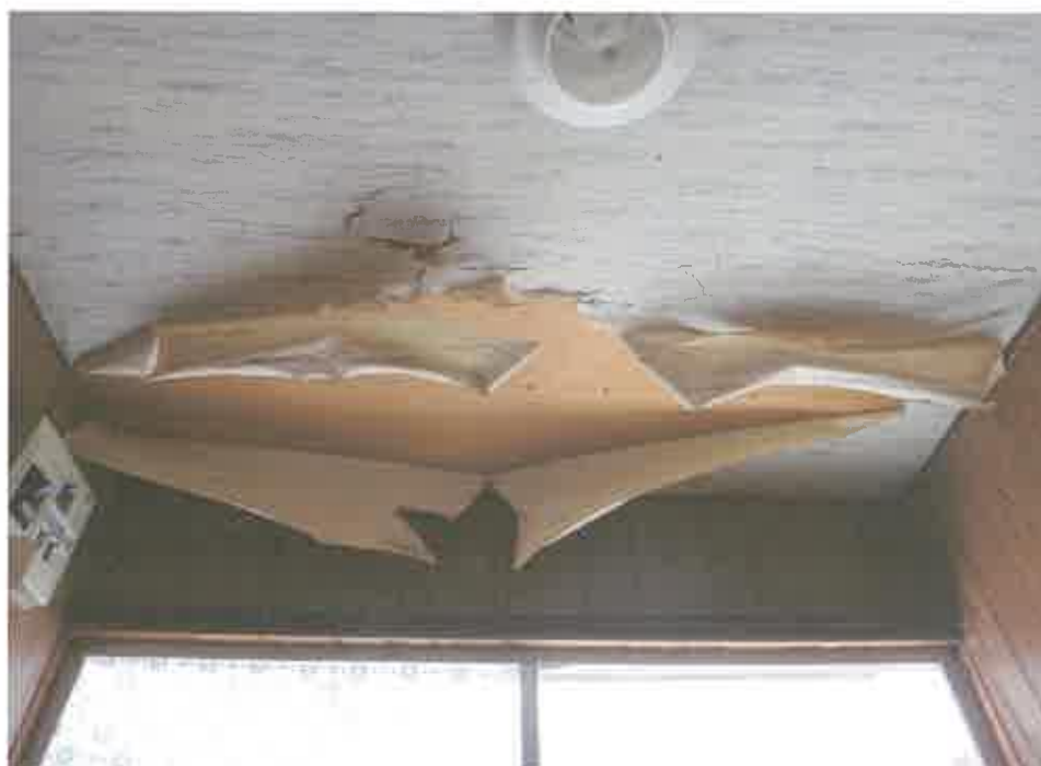
1 階玄関の天井クロスの損傷
