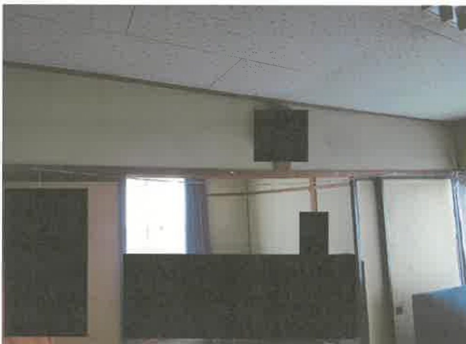
2階居間の梁の歪み
