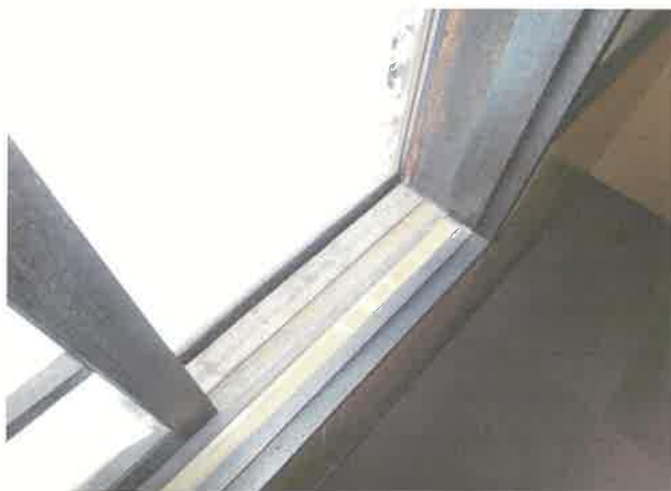
2階座敷席の窓枠の劣化
