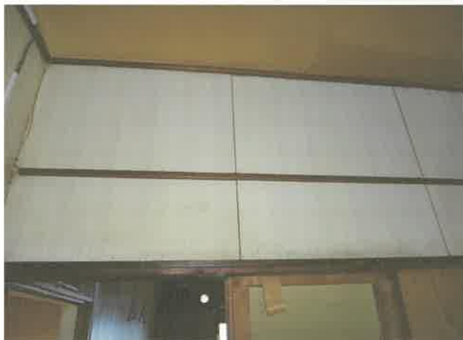
1 階洋室の壁クロスの劣化
