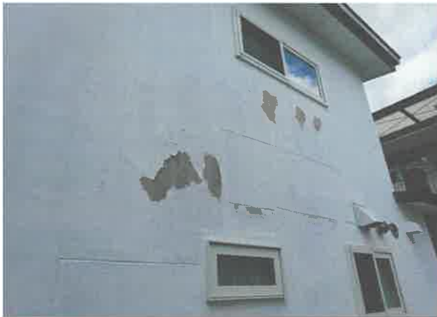
外壁塗膜の剥離の状況
