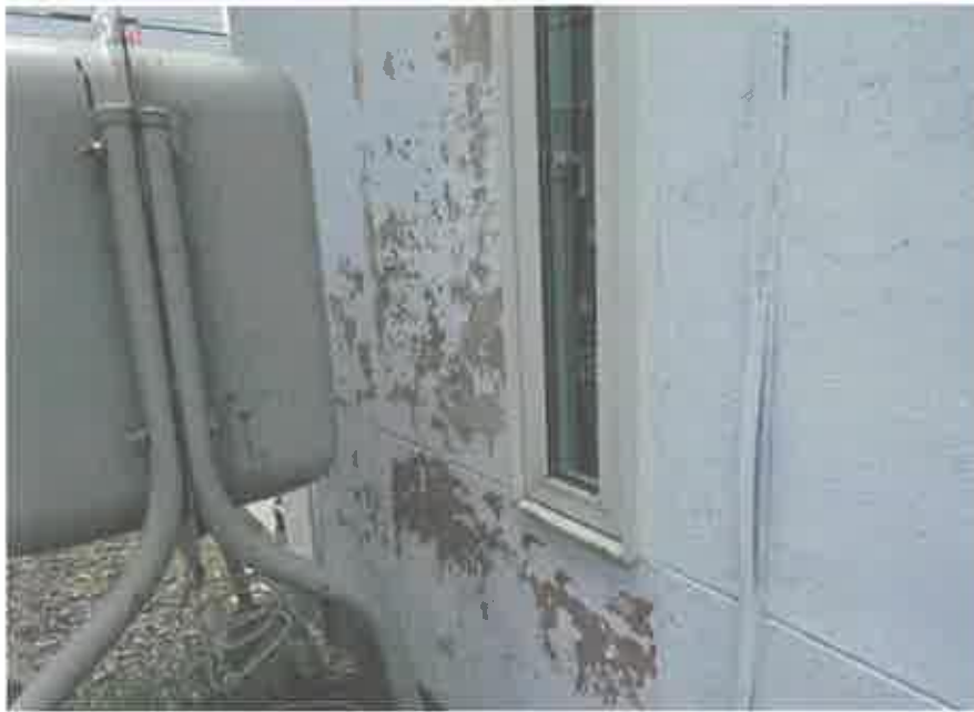
外壁塗膜の剥離の状況
