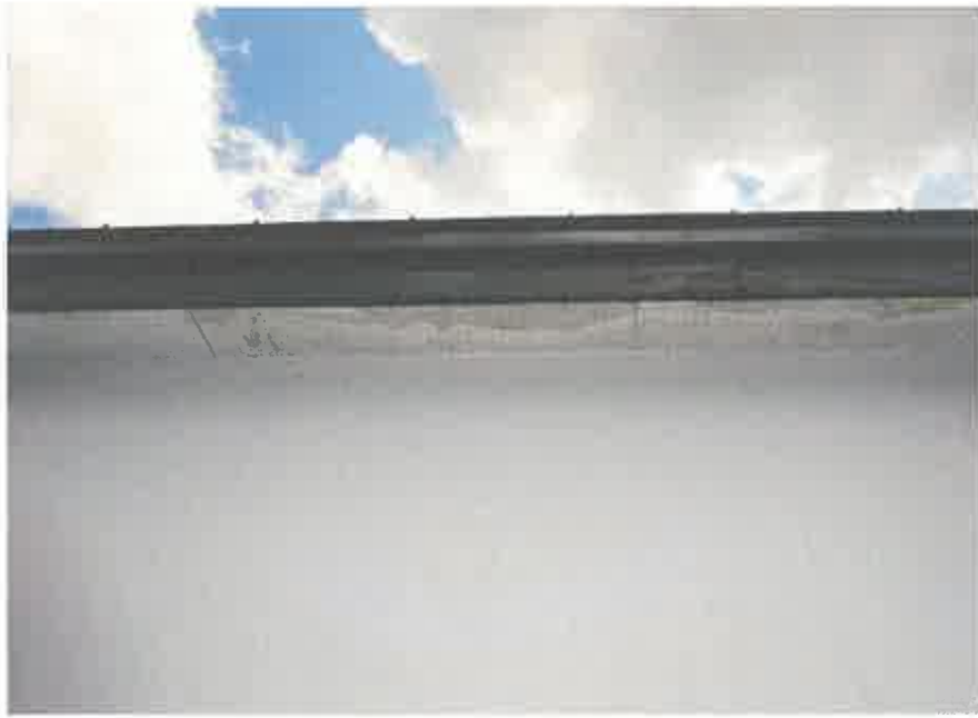
軒天の劣化状況
