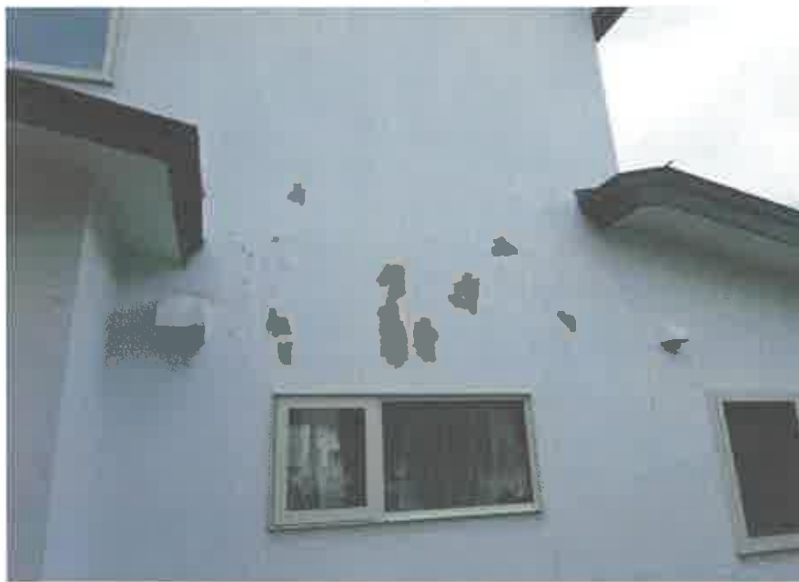
外壁塗膜の剥離の状況
