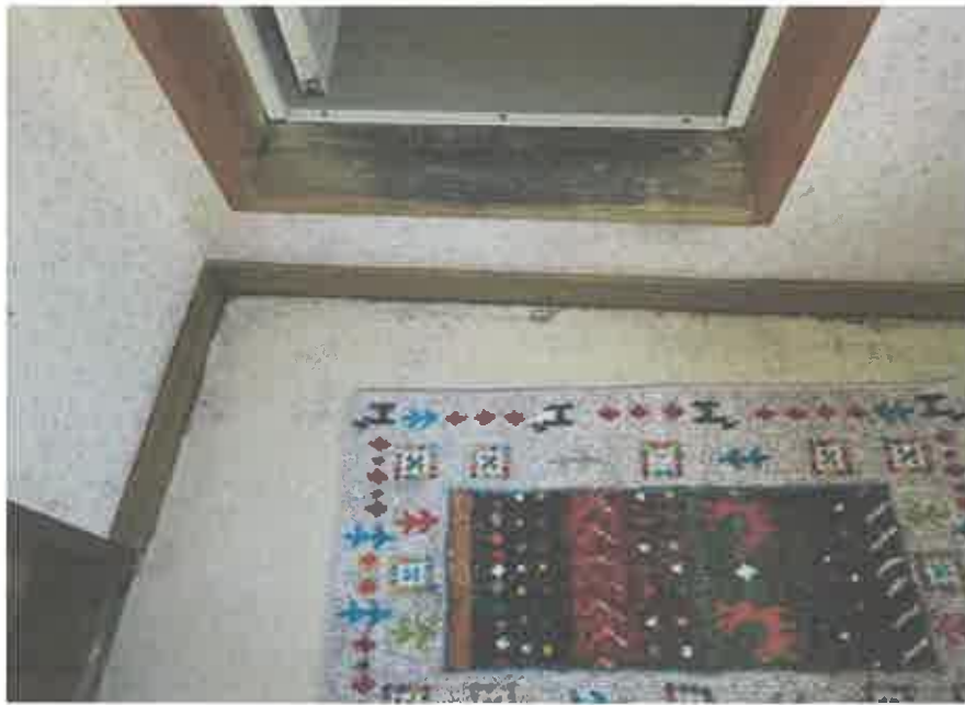
1 階浴室入口下部の黒カビの状況
