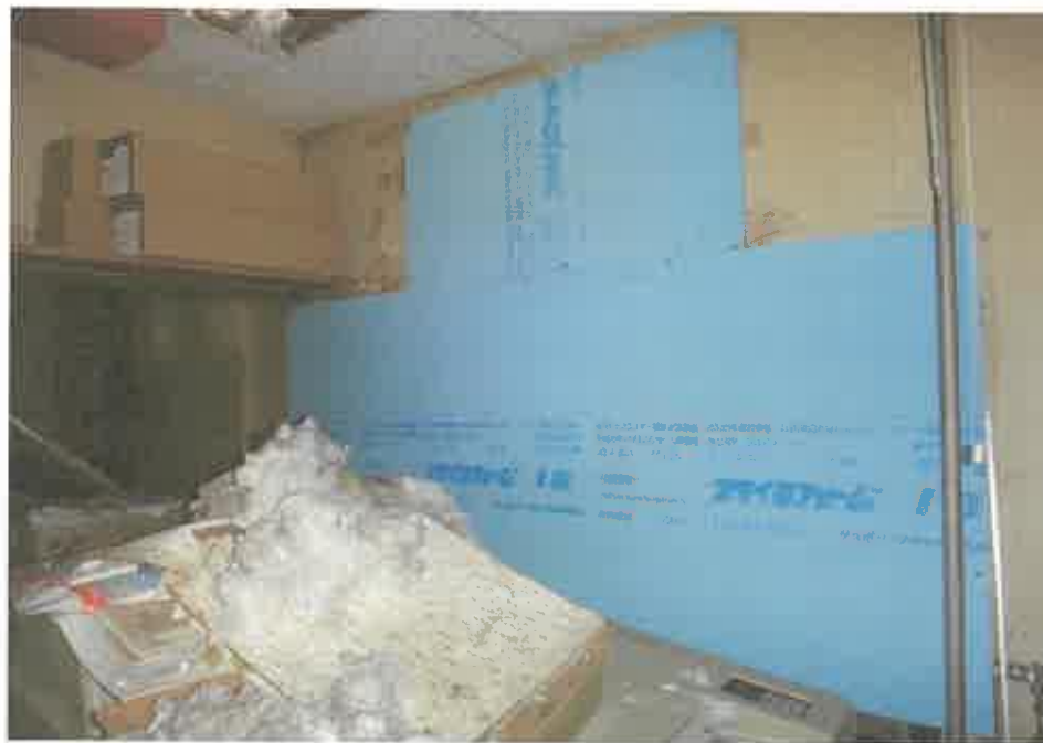
1 階暗室の壁の損傷
