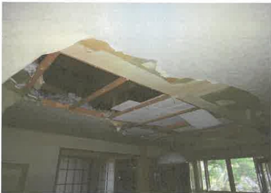
2 階居間及び食堂の天井の損壊
