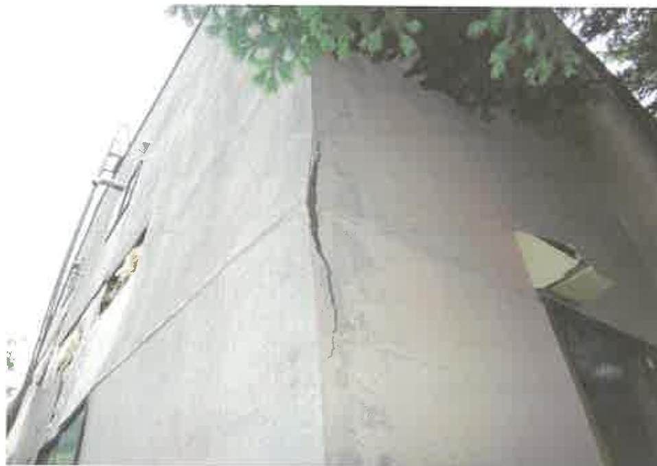
外壁の歪み及び亀裂
