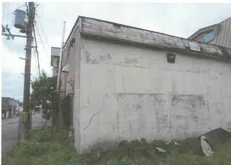
物件 6 の建物の外壁の劣化、トタン屋の損傷及び剥離
