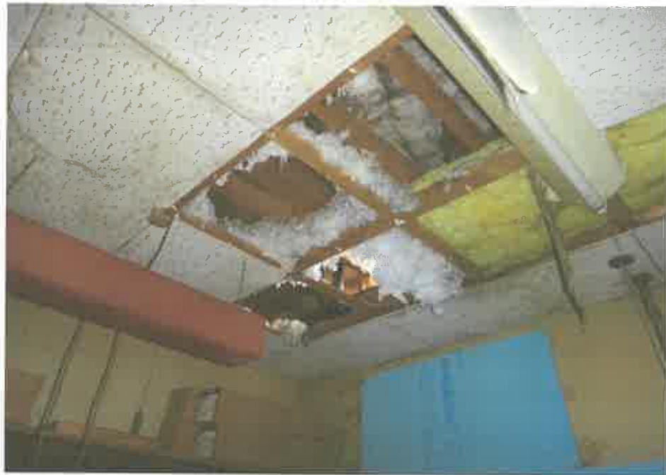
1 階暗室の天井の損壊
