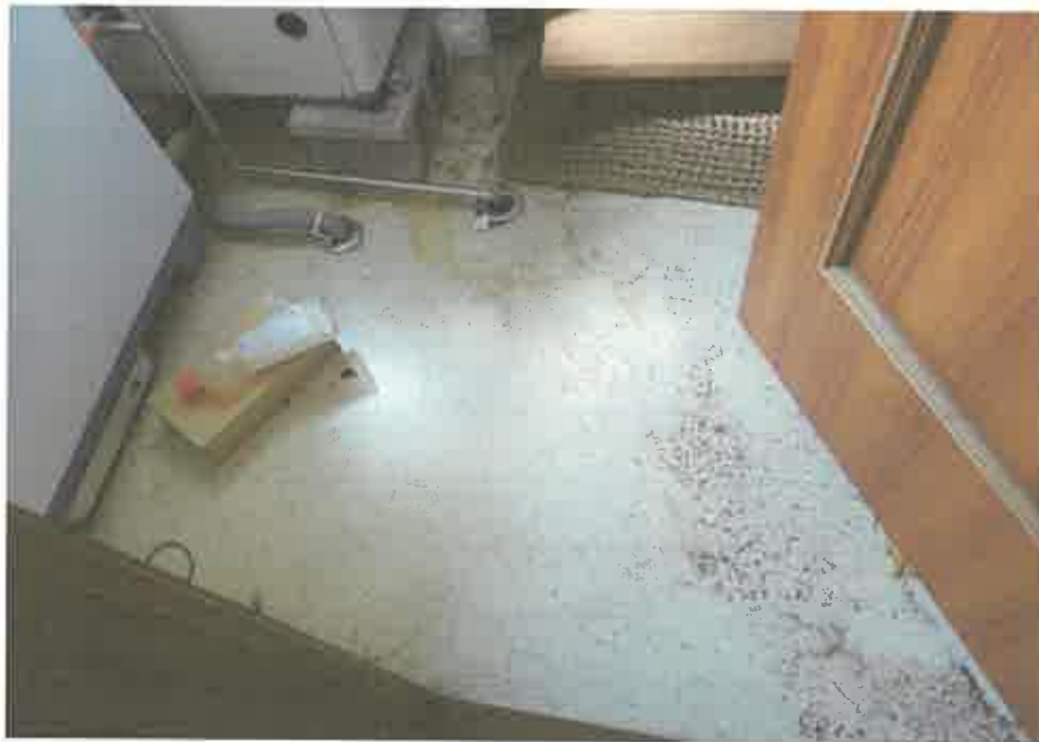
2 階脱衣所の床の汚損
