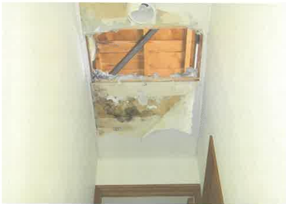
2 階階段部分の天井の損壊
