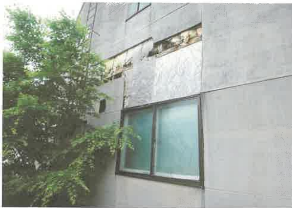
外壁の損傷及び窓ガラスの破損
