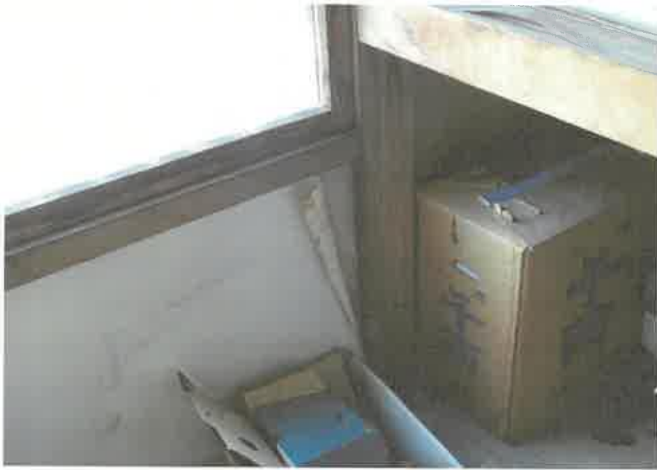
2階和室4の壁クロスの剥離
