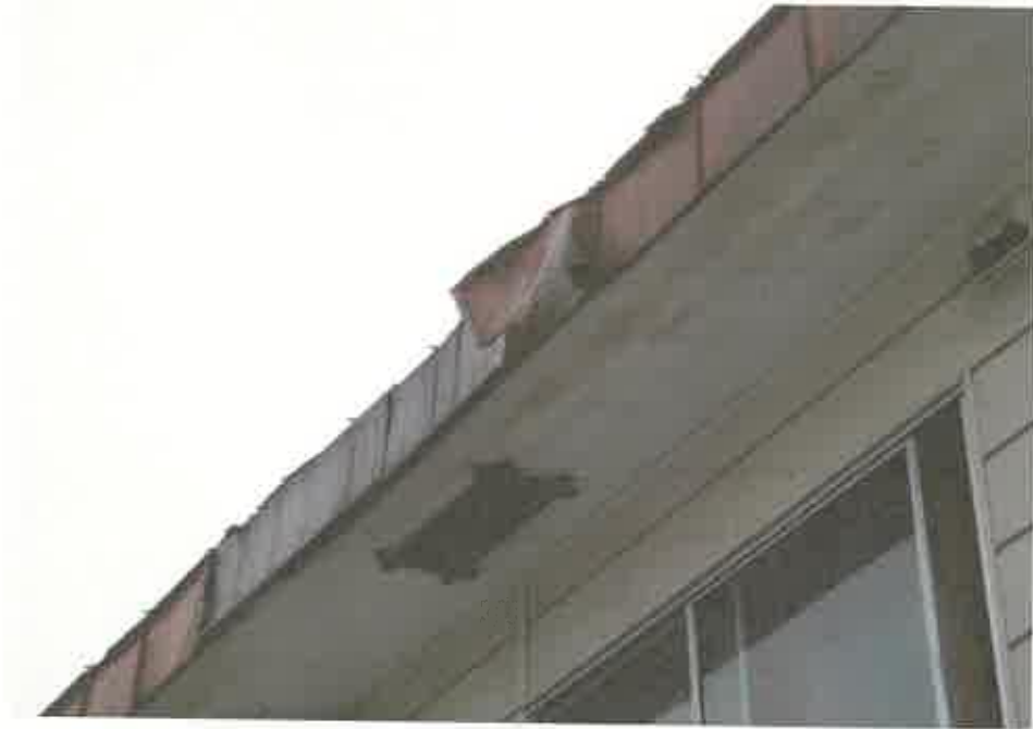
屋根トタンの一部損傷、剥離
