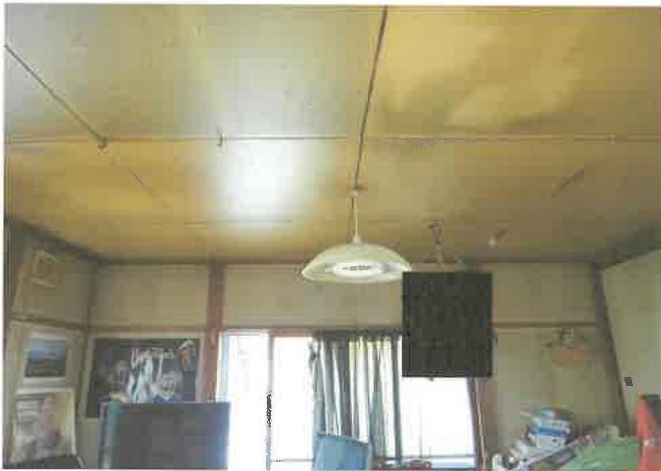
2階和室6の壁及び天井の黄ばみ汚損
