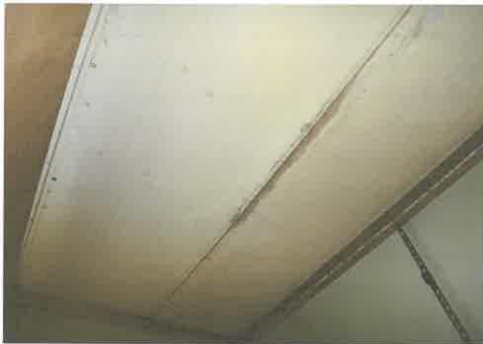
1 階和室 2 の天井の雨漏り跡
