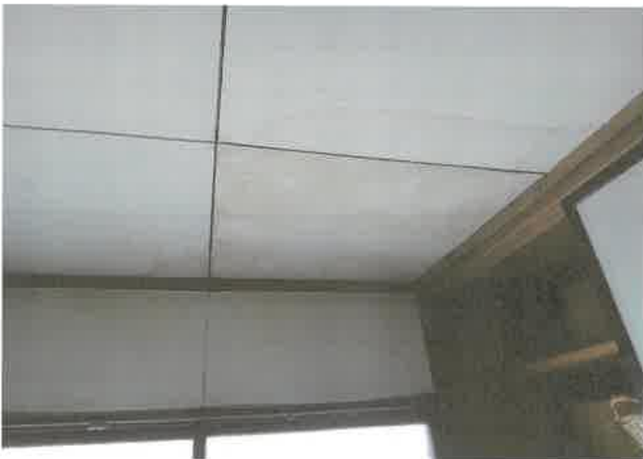
2 階和室 4 の天井の雨漏り跡
