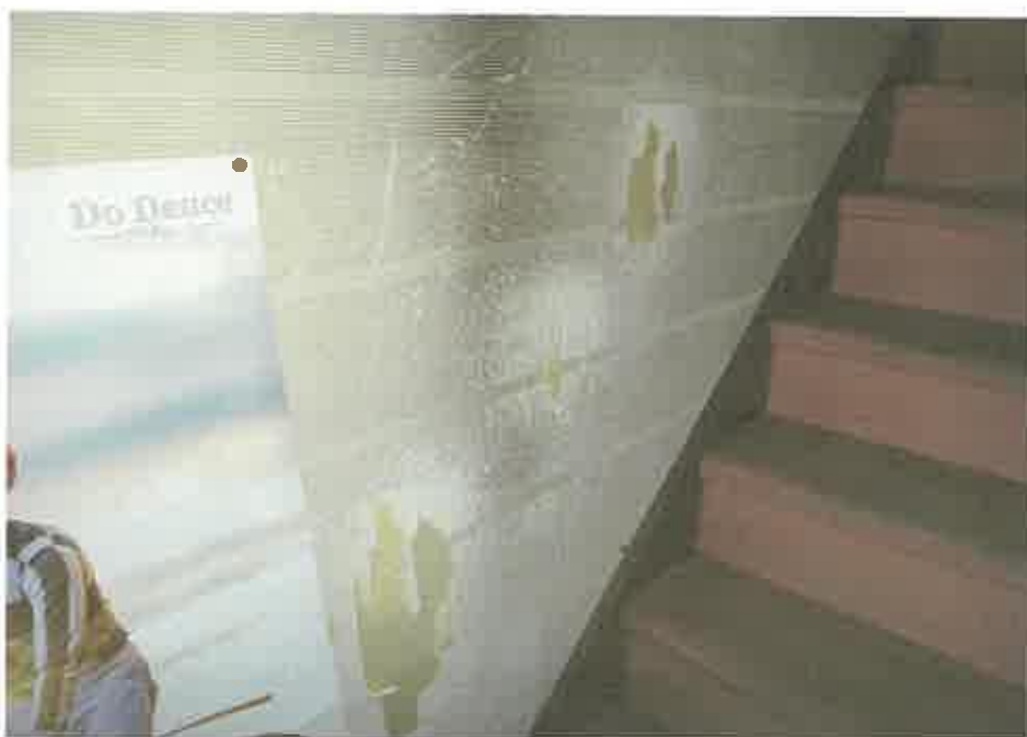
1 階階段付近の壁クロスの損傷
