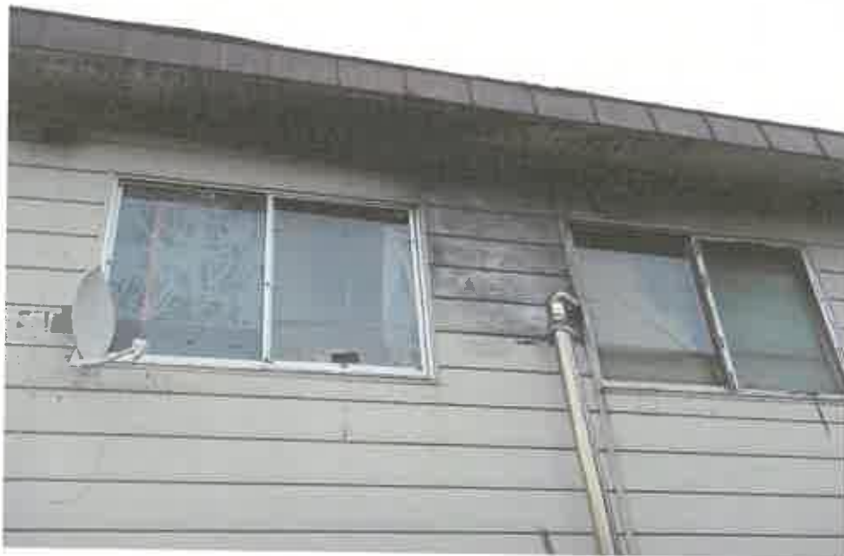
軒天の損傷、窓ガラスの破損
