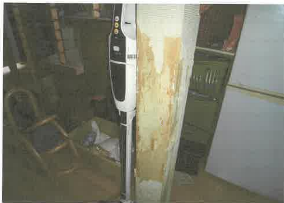
1 階階段付近の柱の損傷
