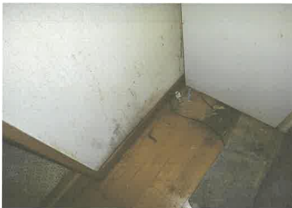
1 階台所の床及び壁クロスの汚損
