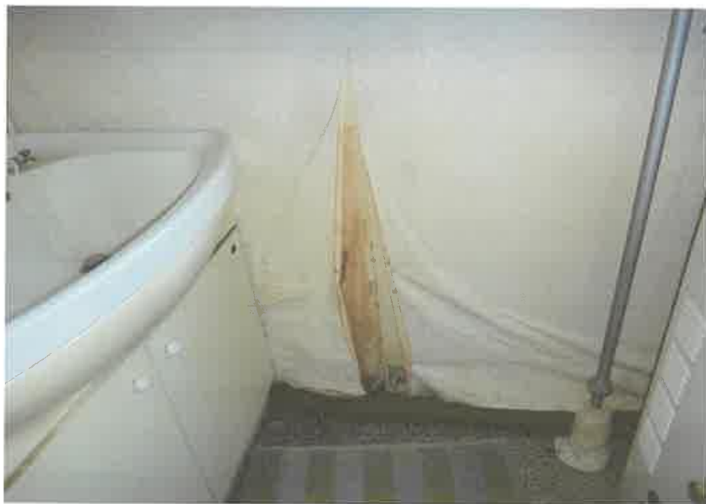
1 階洗面・脱衣室の壁クロスの剥離
