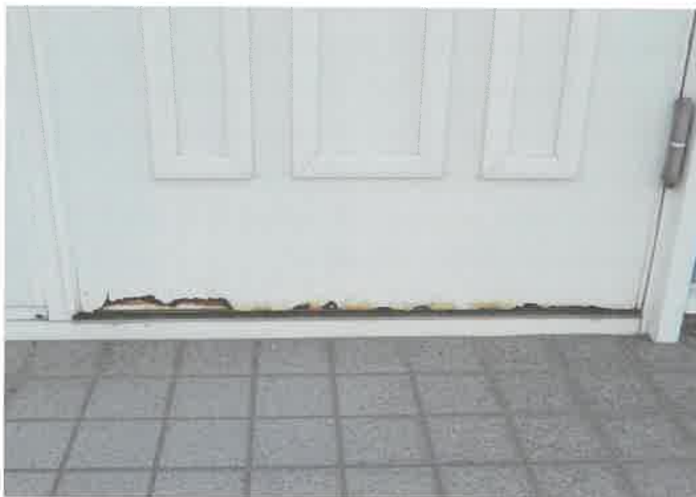
玄関ドア下部の劣化
