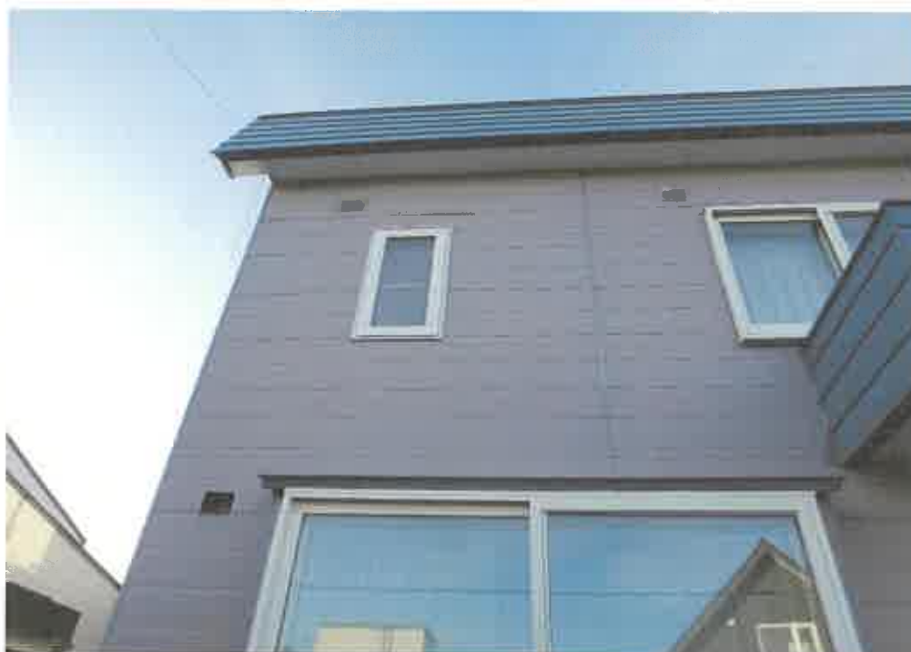
本件建物壁面の換気口フードの損傷
