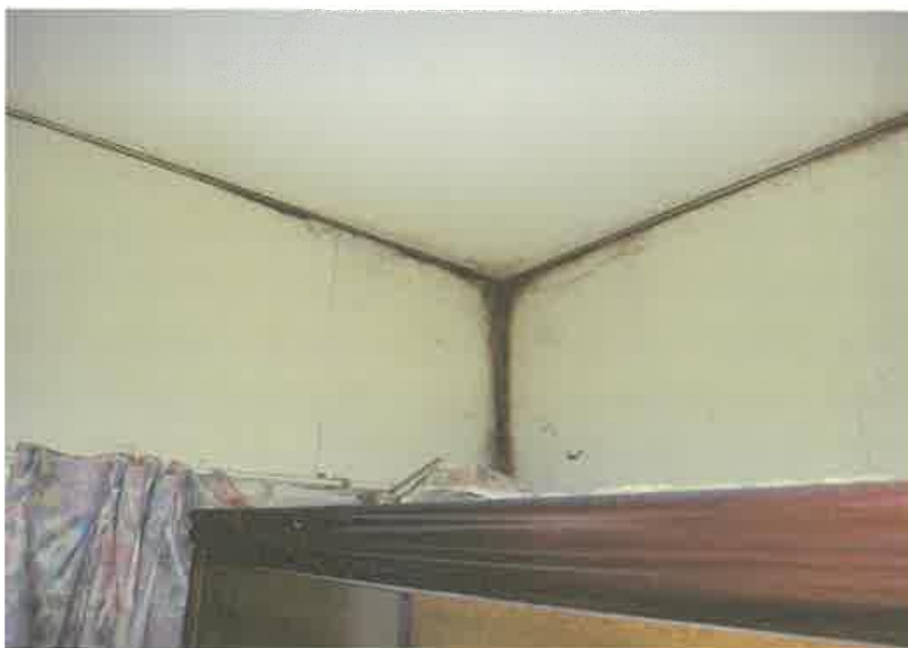
1 階洋室1の壁クロスの汚損
