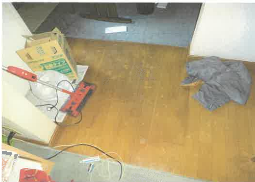
1 階居間の床の劣化
