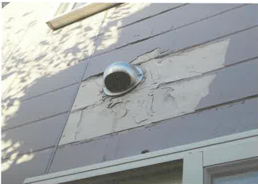
本件建物の外壁の損傷
