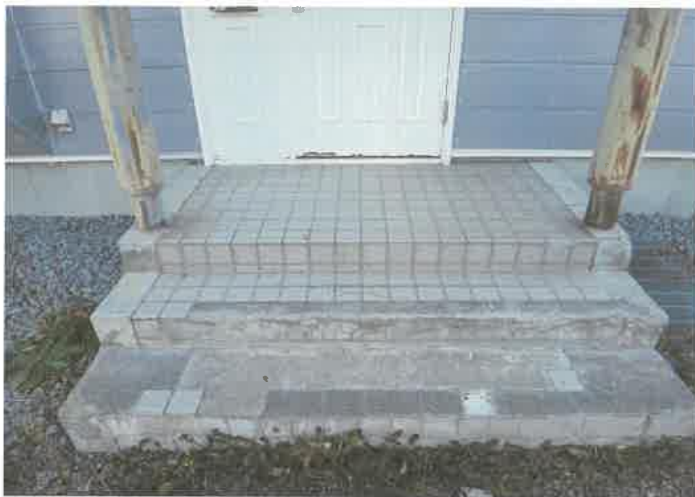
玄関前の支柱及び玄関前階段部分の劣化
