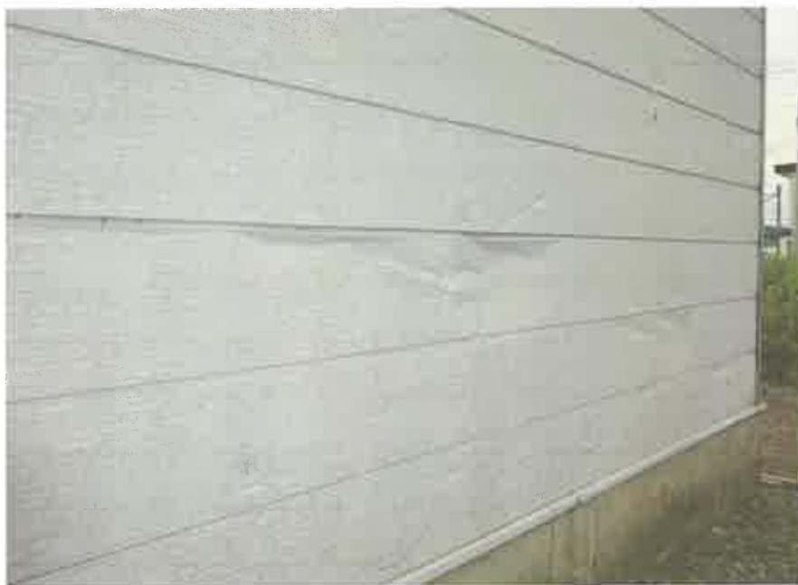
物件8 建物外壁の凹みの状況
