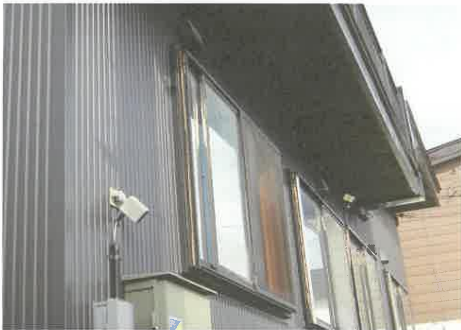
外窓枠の劣化
