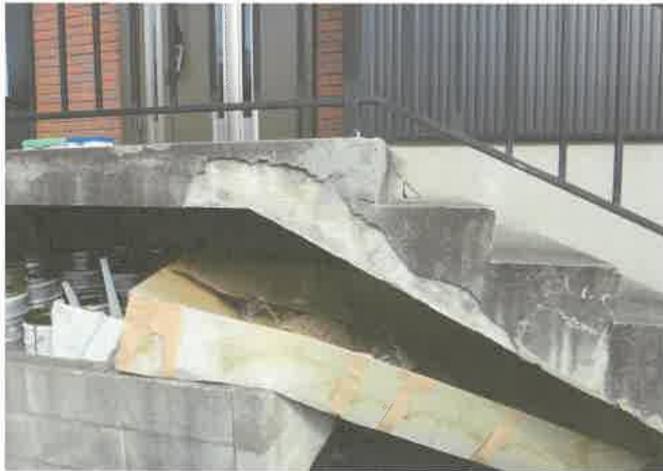
玄関前階段の一部損傷
