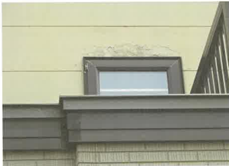
外壁塗装の剥離状況
