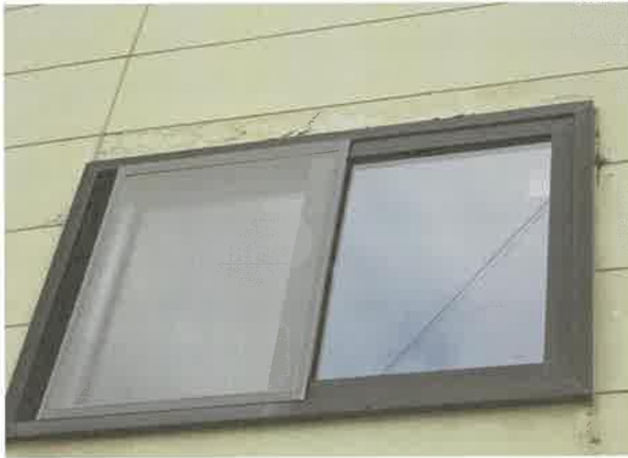
外壁塗装の剥離状況
