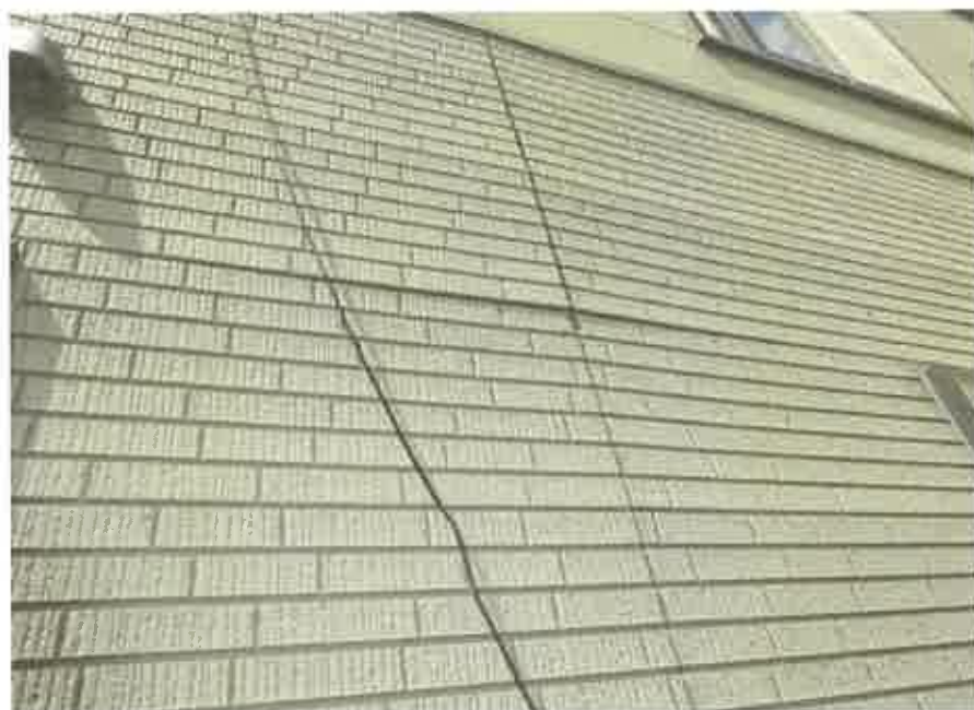
外壁が浮いている状況
