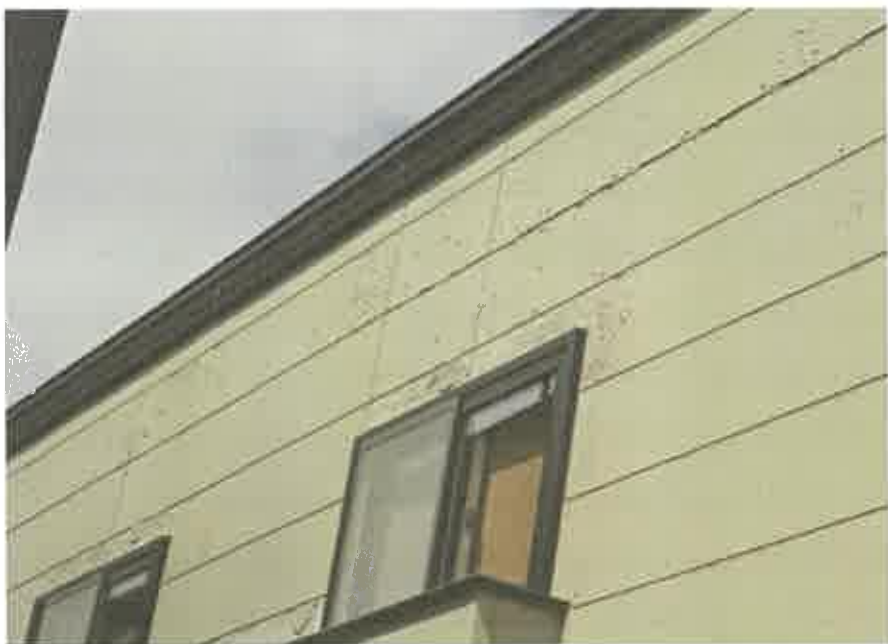
外壁塗装剥離状況
