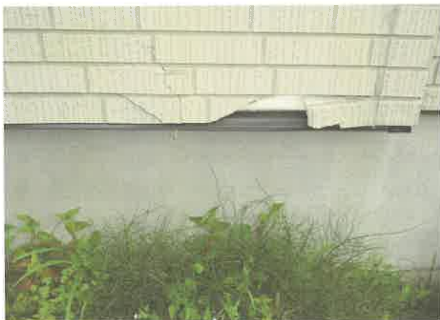
外壁の損傷状況
