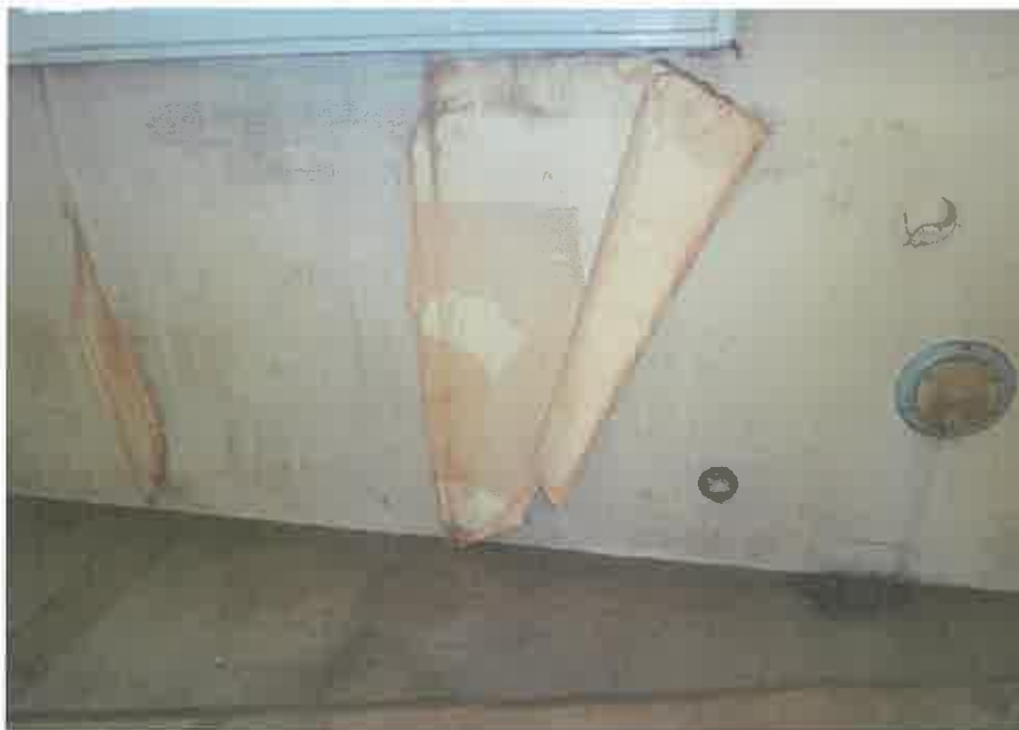
洋室2の壁の穴と壁クロスの剥がれ
