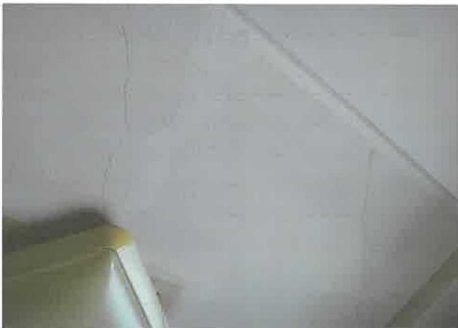
洋室1の天井クロスのひび割れ
