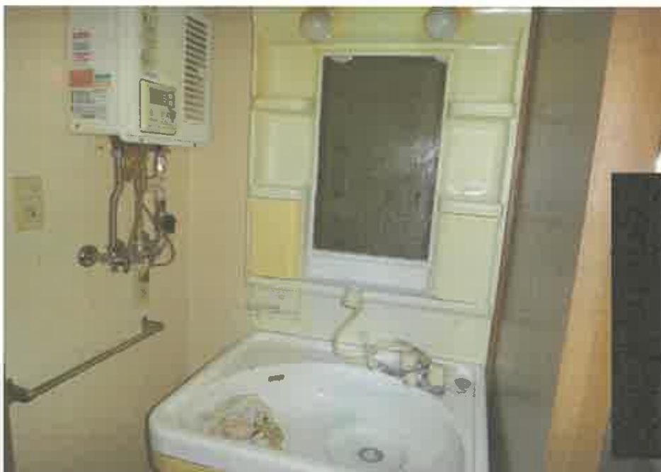
ユーティリティー内の洗面台
