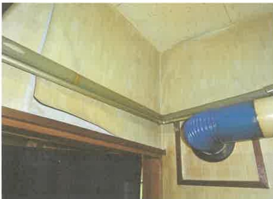
ユーティリティの壁紙クロスの剥離状況
