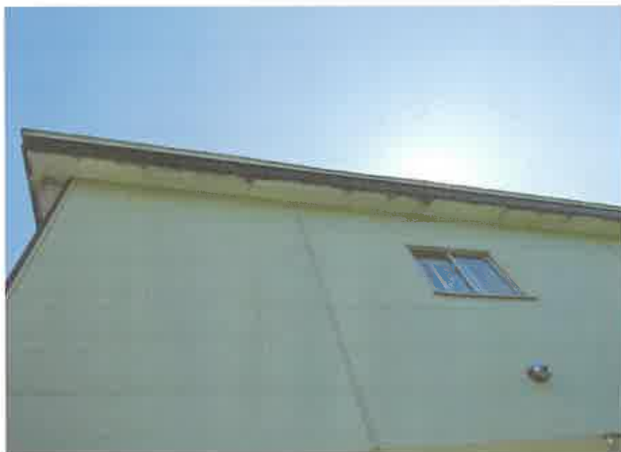
本件建物の屋根の略北側軒天の損傷状況
