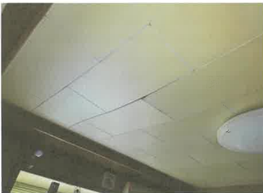
1 階居間の天井が落ち込んでいる状況
