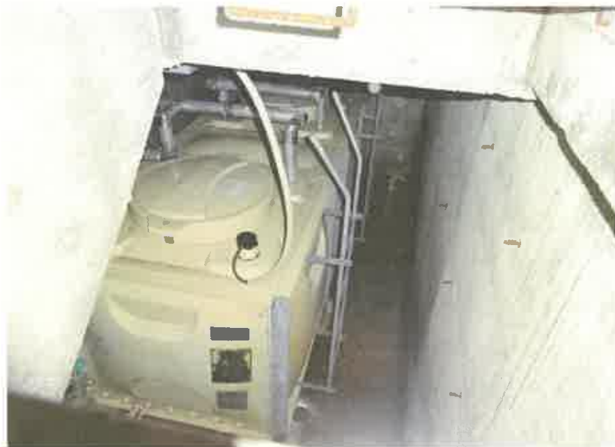
地下1階の受水槽室の状況
