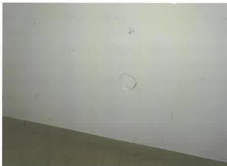
201号室洋室2の壁の損傷状況
