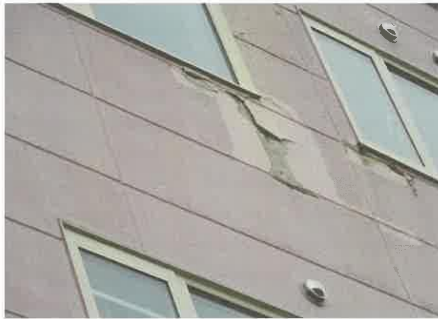
外壁の損傷状況
