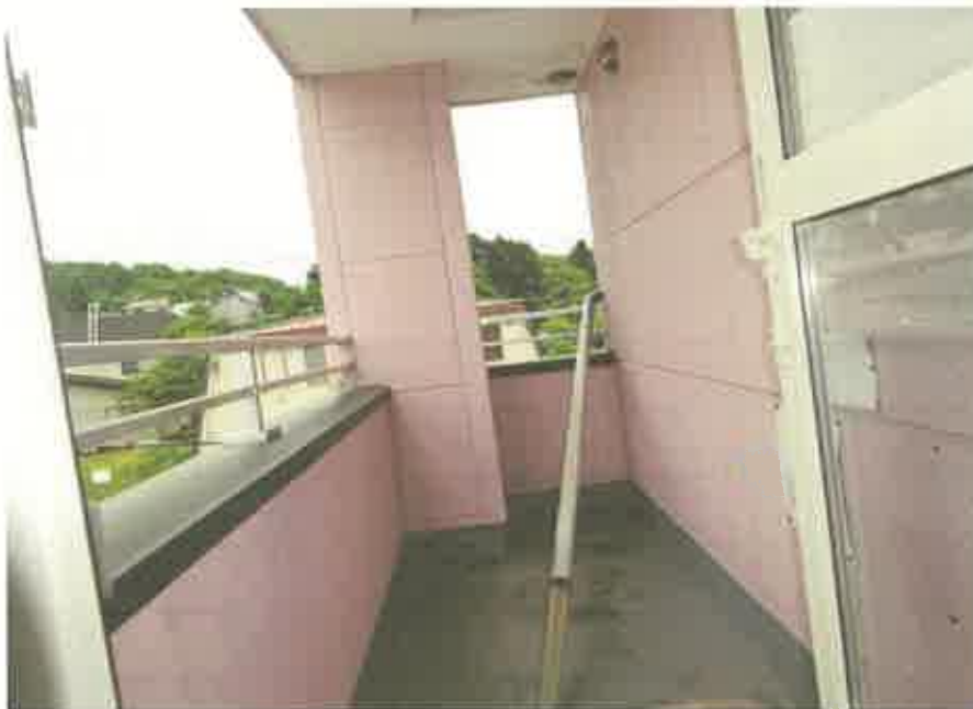
305号室のバルコニーの雨水排水管が外れている状況
