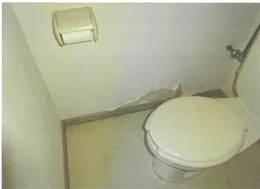
405号室トイレの壁紙クロスの剥離状況
