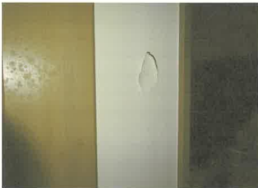
205号室の台所の壁の損傷状況
