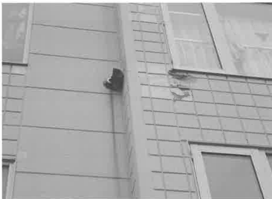
外壁の損傷状況
