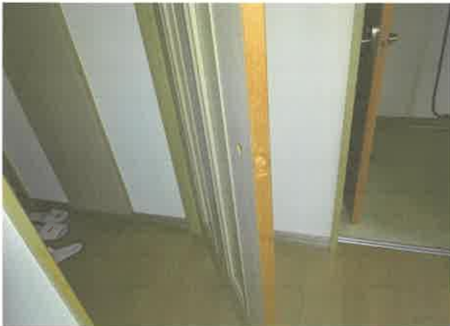
4 0 5 号室の居間と玄関の間のドアノブが外されている状況
