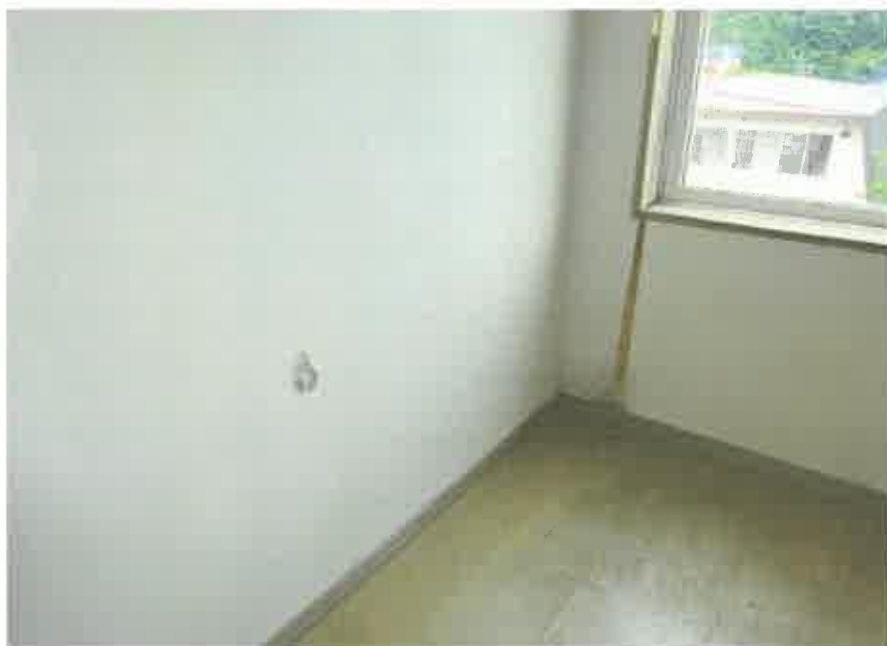
405号室洋室1の壁紙クロスの剥離及び損傷の状況
