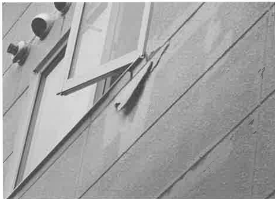
外壁の損傷状況
