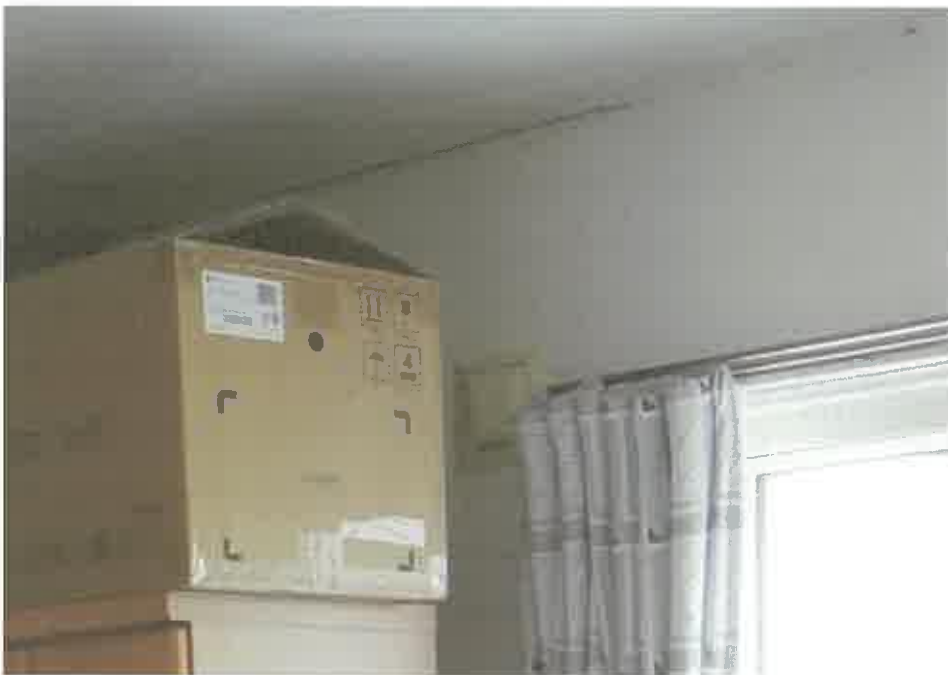
201号室の洋室1の壁クロスのカビによる汚損
