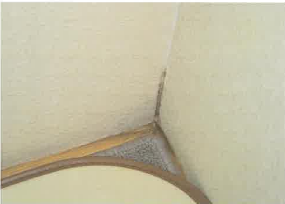
103号室の和室の壁クロスのカビによる汚損
