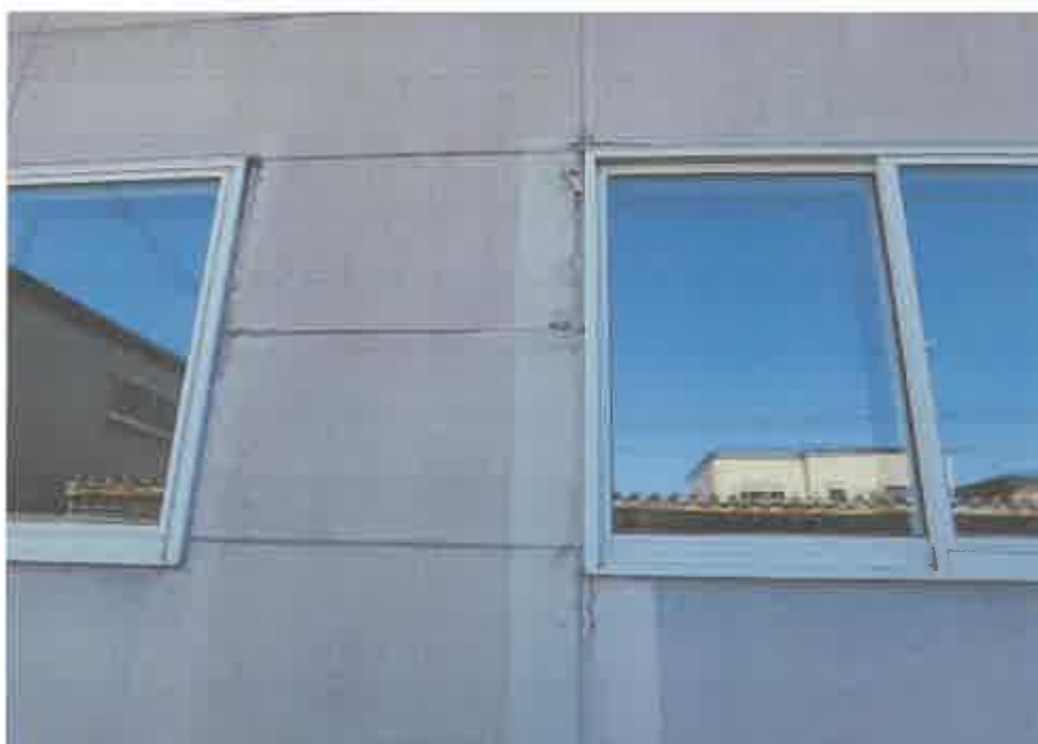
物件 6 の建物の外壁の劣化
