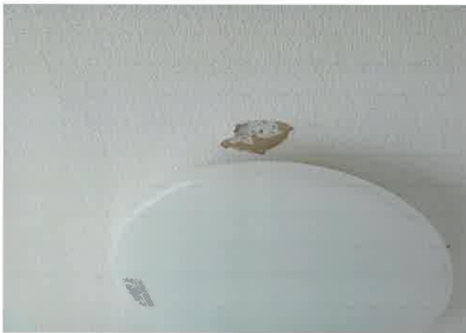
207号室の天井クロスの損傷
