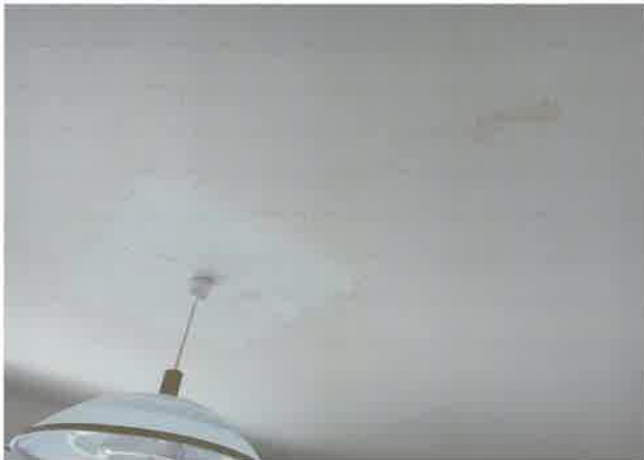
105号室の天井クロスの汚損
