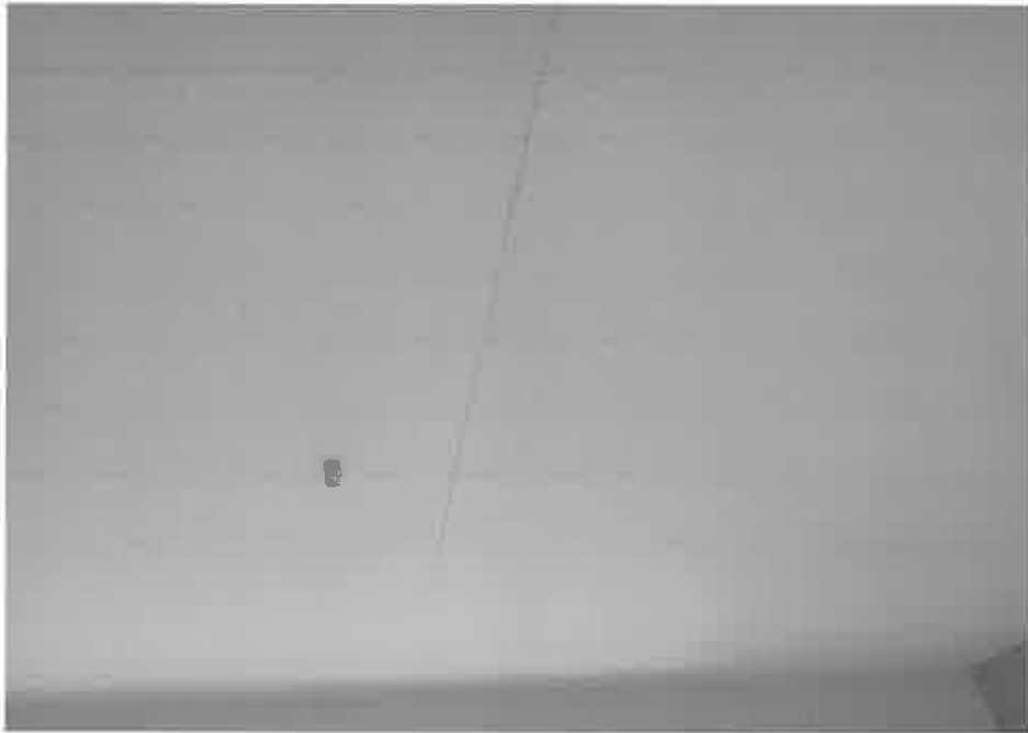
205号室の天井クロスの亀裂
