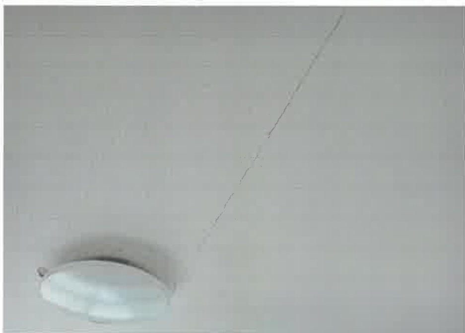
207号室の天井クロスの亀裂
