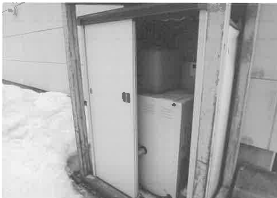
スチール製仮設ボイラー庫
