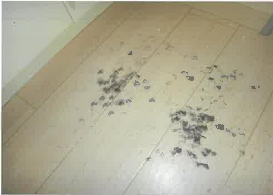
107号室の脱衣室の床の汚損
