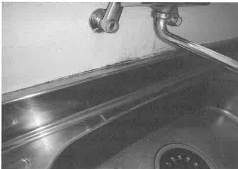
205号室の台所シンク上部の壁クロスのカビによる汚損
