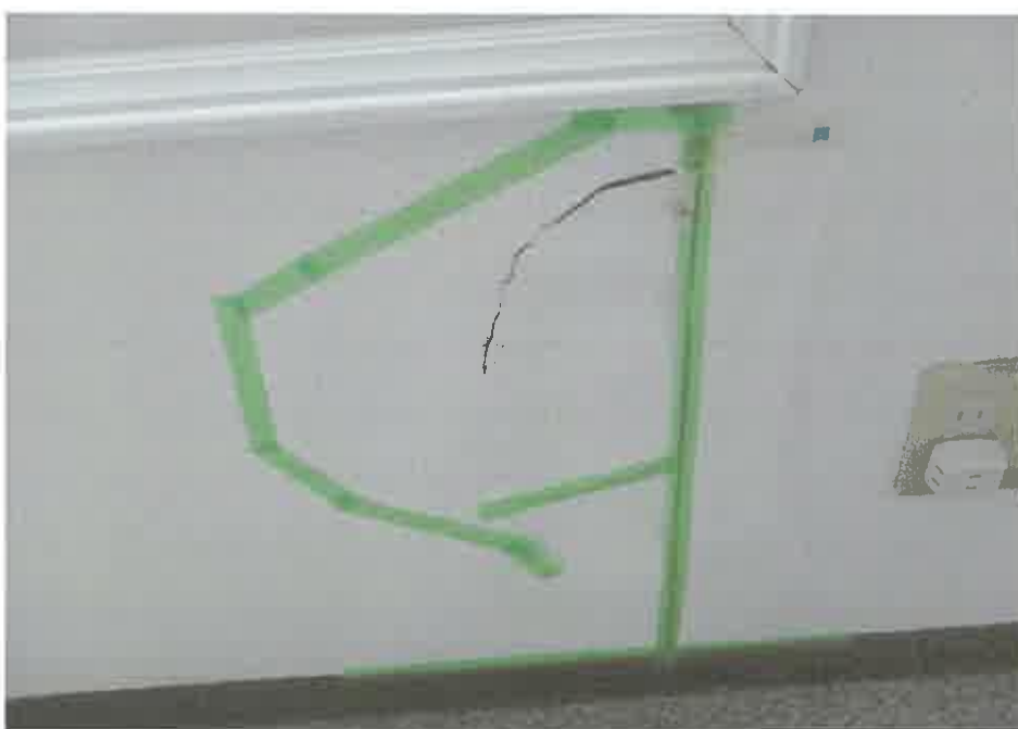
207号室の居間の壁クロスの損傷
