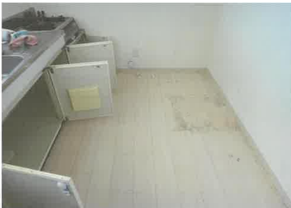
107号室の台所の床の汚損
