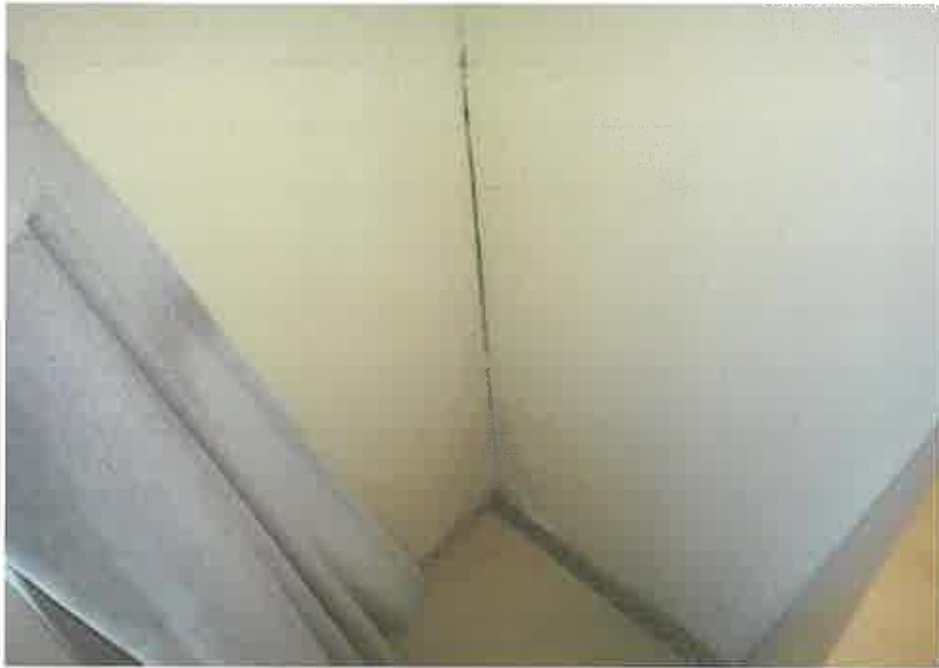
201号室の和室の壁クロスのカビによる汚損及び剥離
