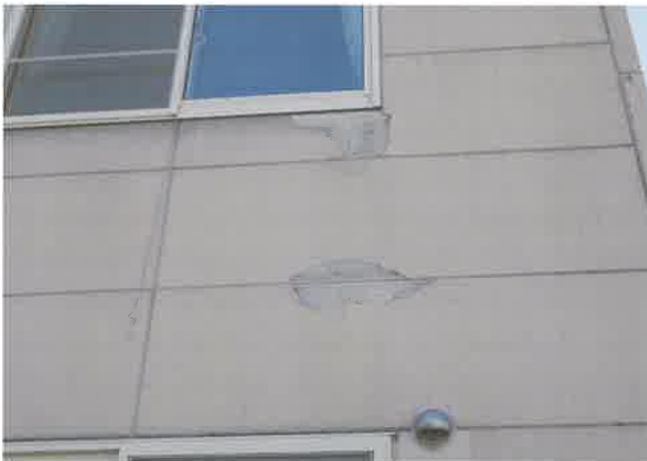
物件 7 の建物の外壁の損傷
