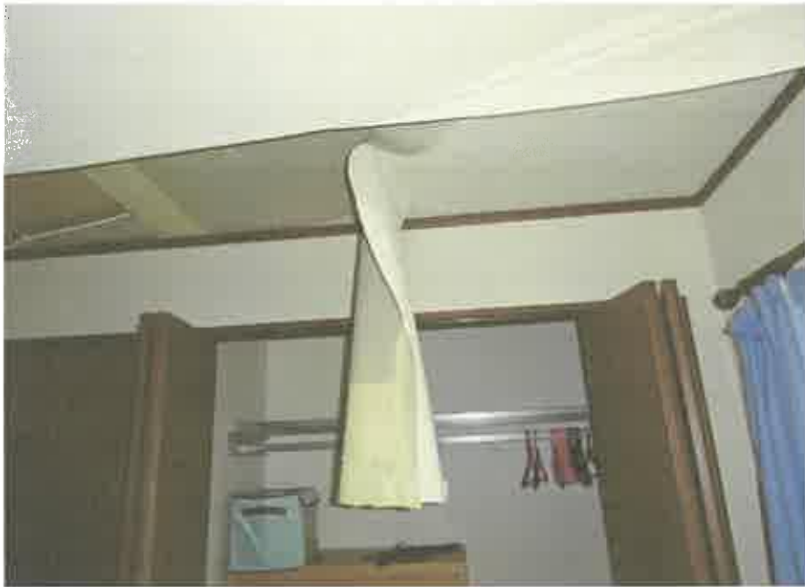
1 階洋室 2 の天井クロスが剥離して落ちている状況
