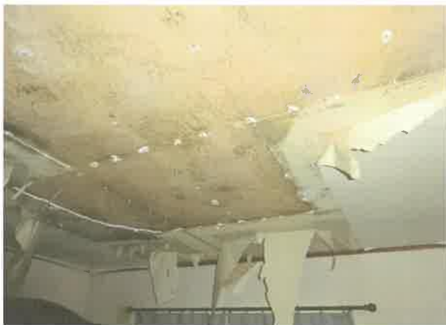
1 階洋室 3 の天井クロス及び石膏ボードが損傷している状況
