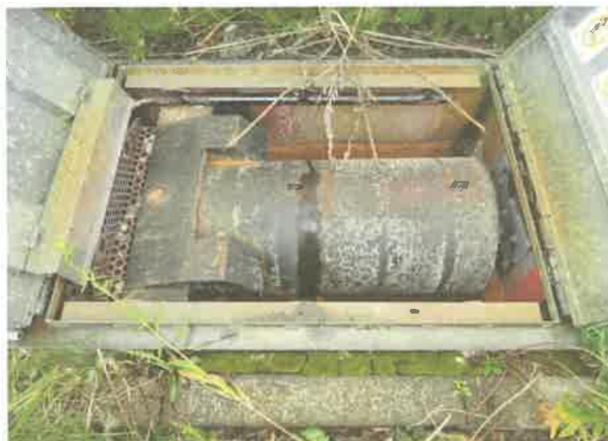
融雪槽（蓋が開いた状態）
