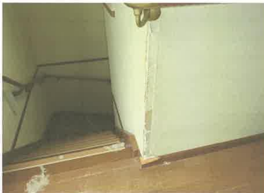
2階階段付近の壁紙クロスの損傷状況
