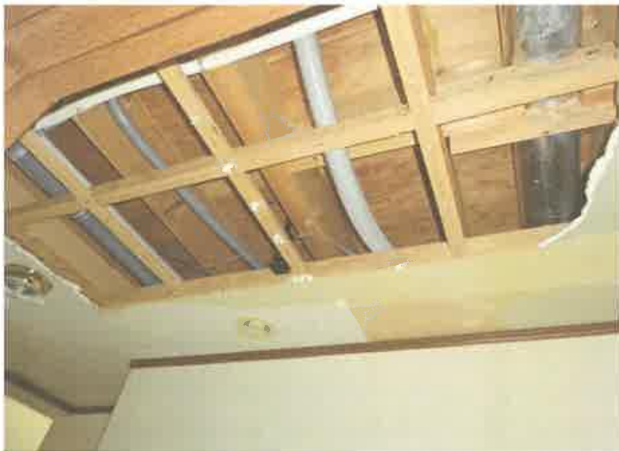
1 階廊下の天井の損傷状況
