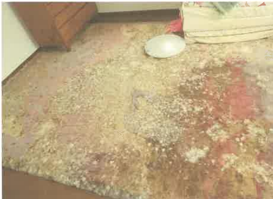
1 階洋室 1 の床の絨毯にカビが発生している状況
