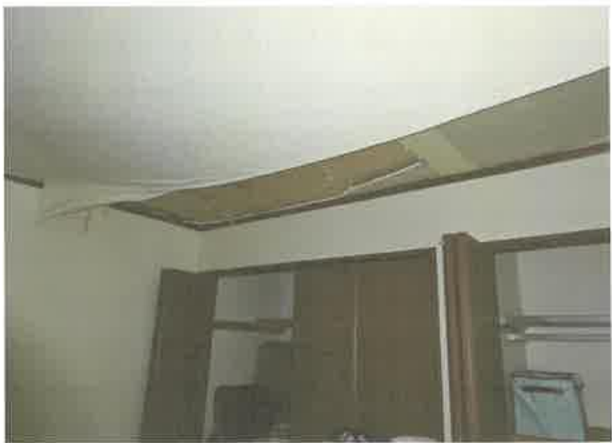
1 階洋室 2 の天井クロス及び石膏ボードが損傷している状況
