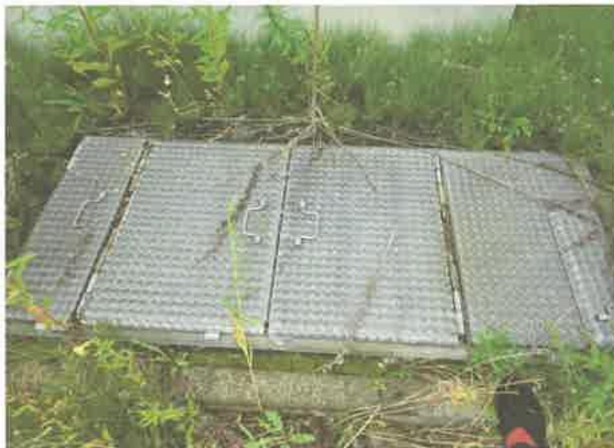
融雪槽（蓋が閉じた状態）
