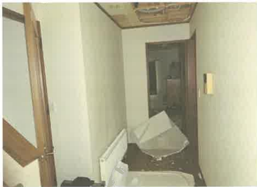
1 階廊下の状況（天井の石膏ボードが落下している。）
