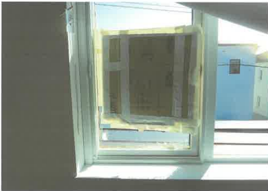
2階洋室4の窓ガラスの破損
