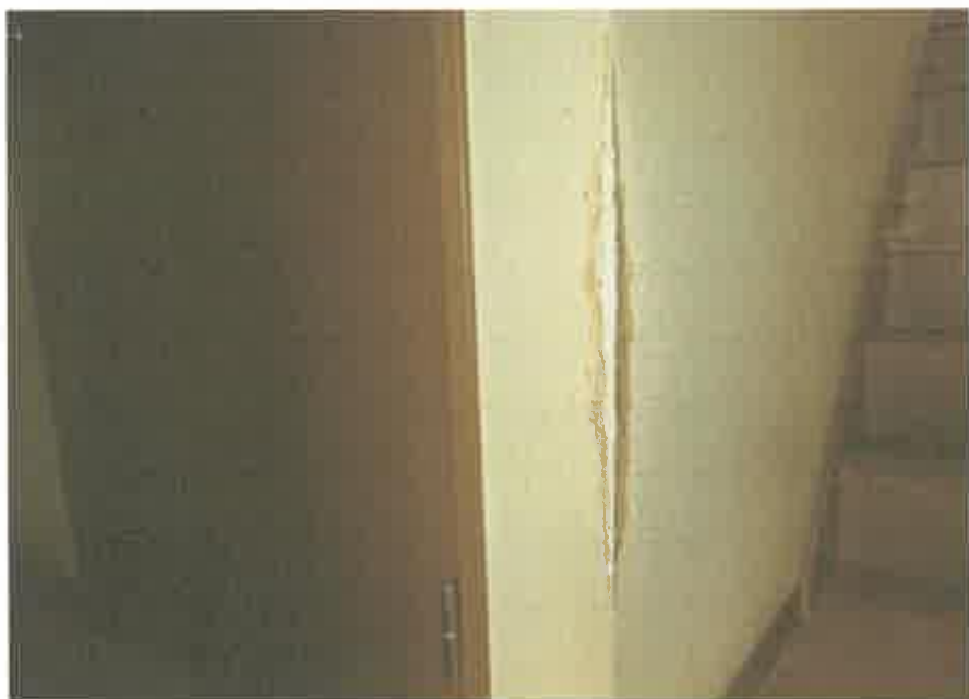
1 階階段付近の内壁クロスの損傷
