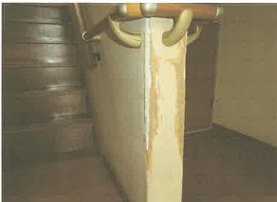
1 階階段付近の内壁クロスの損傷
