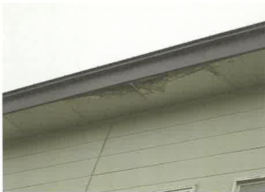
軒天の損傷状況
