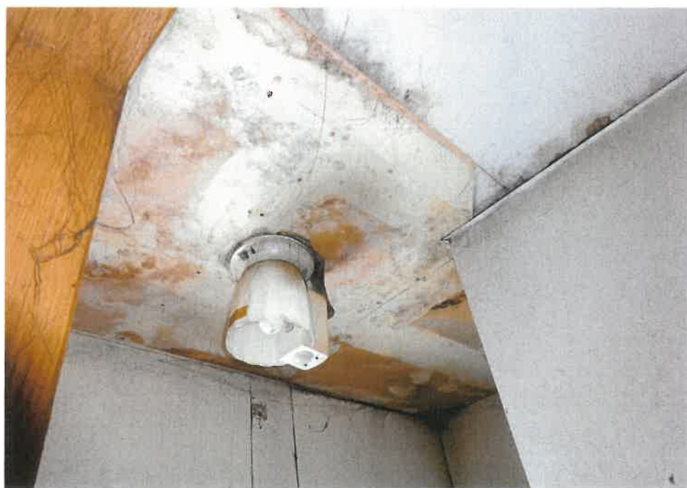
⑮ 2階 トイレの天井の汚損
