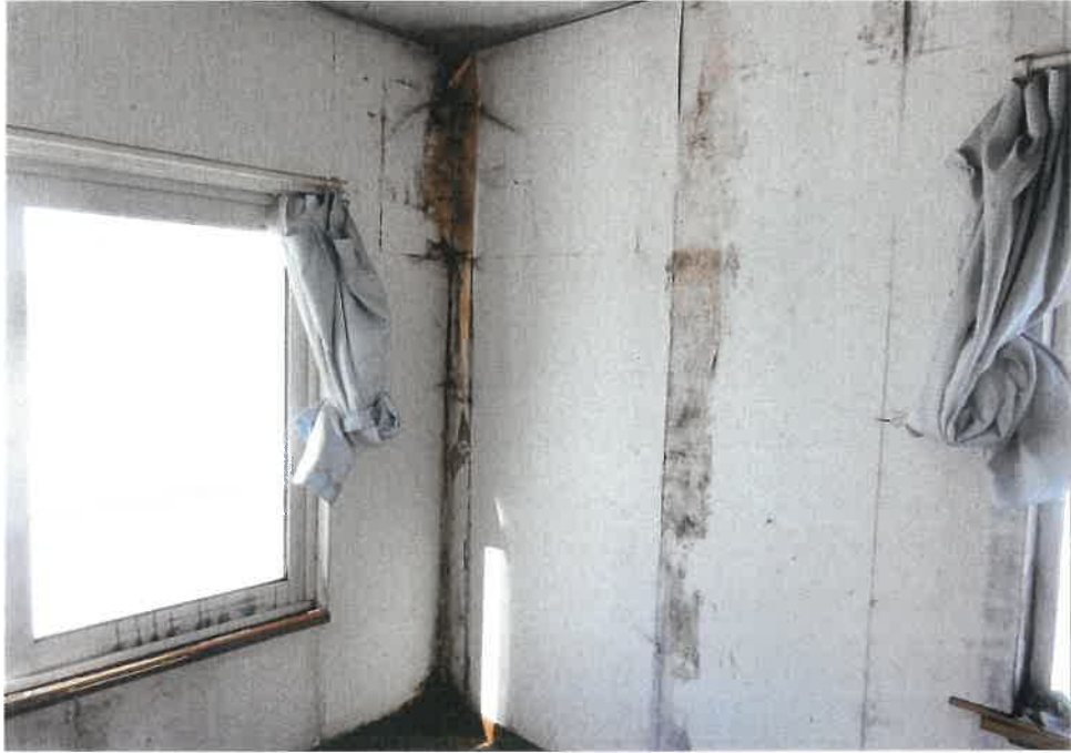
⑪ 2階 洋室1の壁の汚損、クロス剥離
