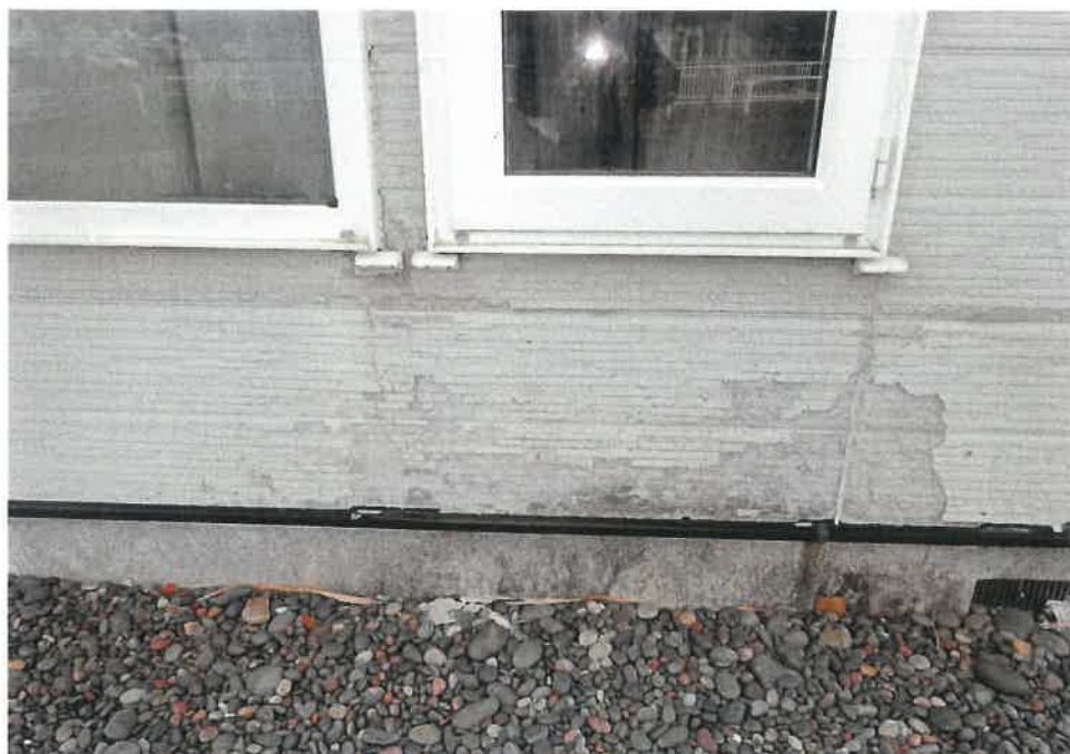
⑳ 外壁の損傷
