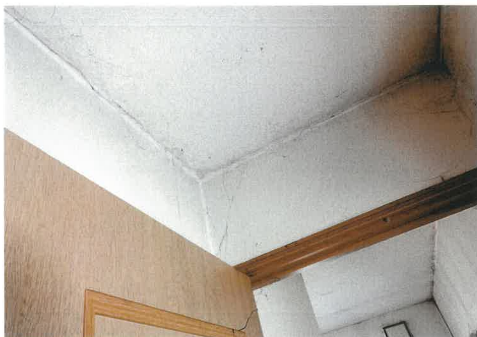
⑯ 2階 ホールの天井の汚損
