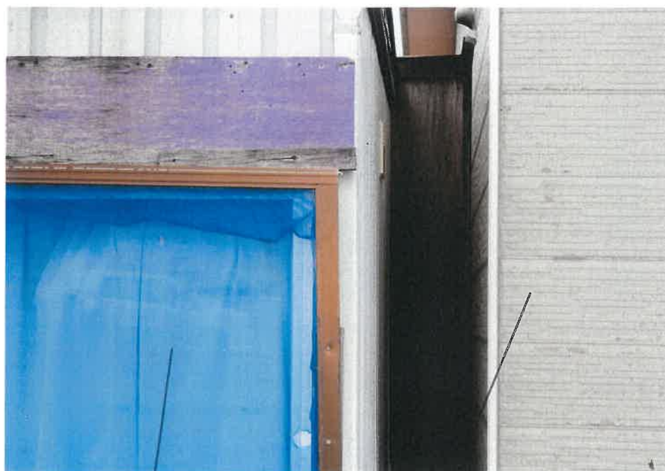
⑱ 本建物と木造仮設物置1が接している状況
