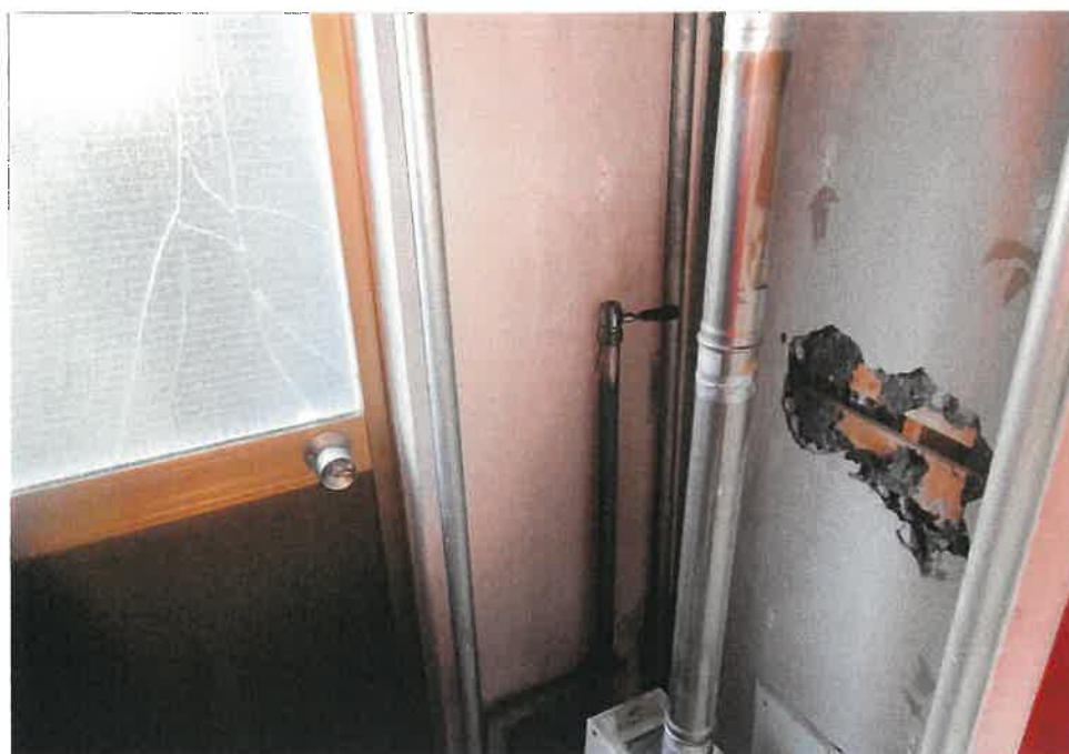
⑧ 1階 裏口のドアガラスの損傷、壁の穴
