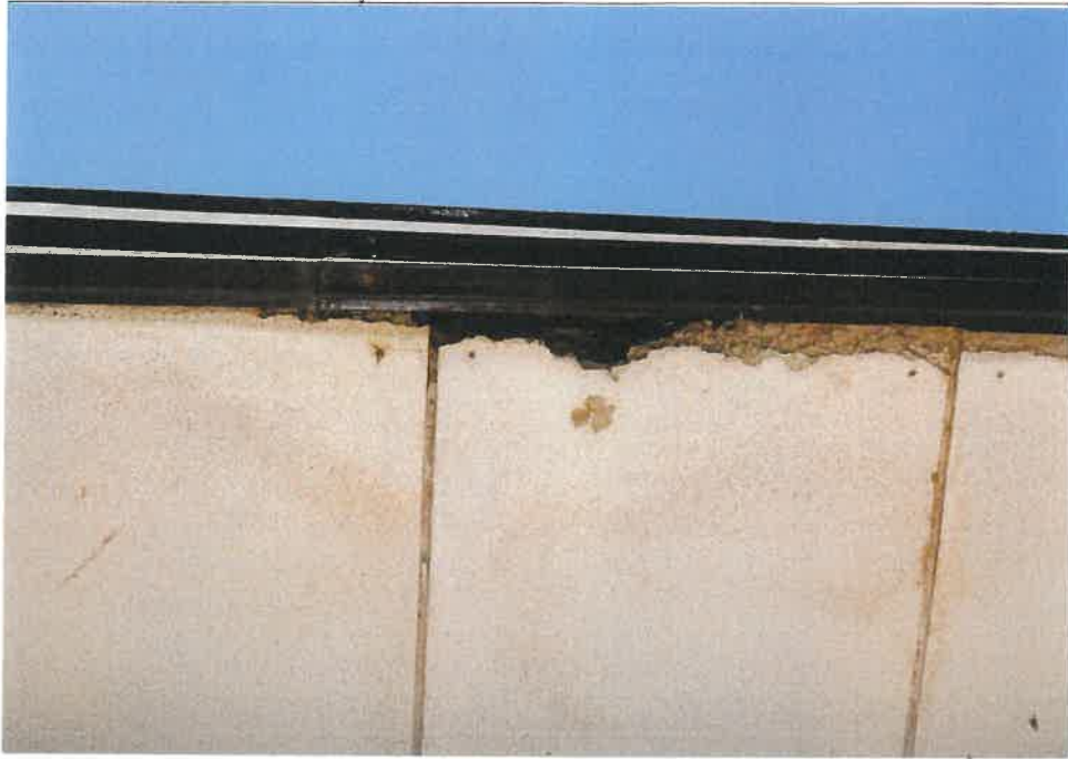
⑬ 屋根の損傷
