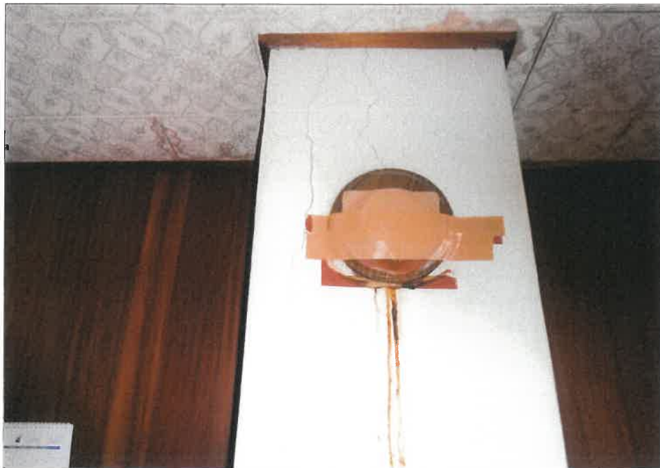
⑨ 2階 洋室1の集合煙突の亀裂、汚損
