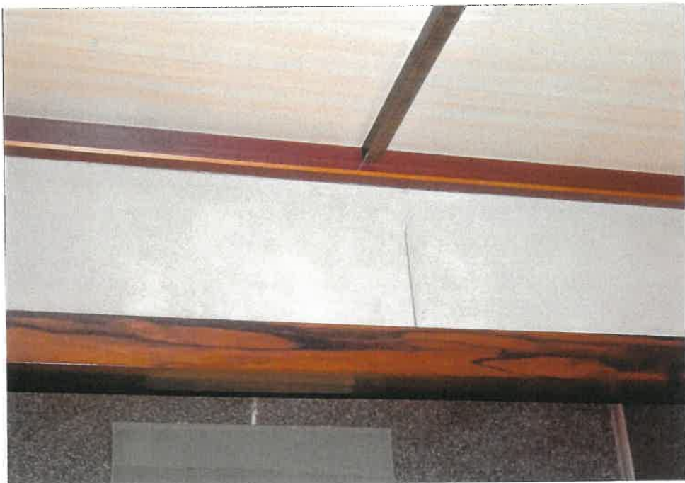
⑥ 1階 和室1の壁の亀裂
