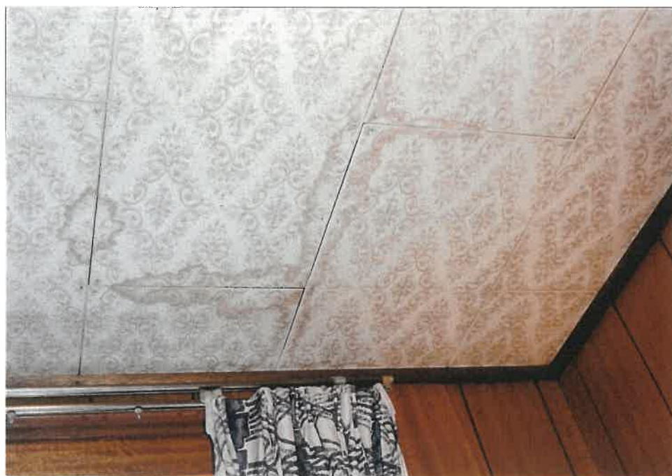
⑩ 2階 洋室2の天井の雨漏り跡
