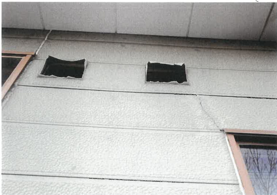
⑭ 換気口の損傷、外壁の損傷
