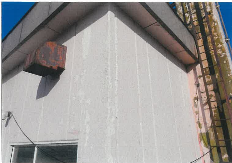
(28) 6階 機械室の外壁の損傷、腐食
