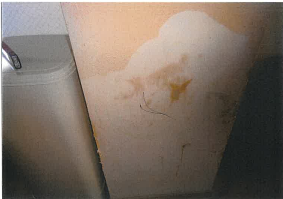
(32) 2階 201号室 居間の壁クロス剥離
