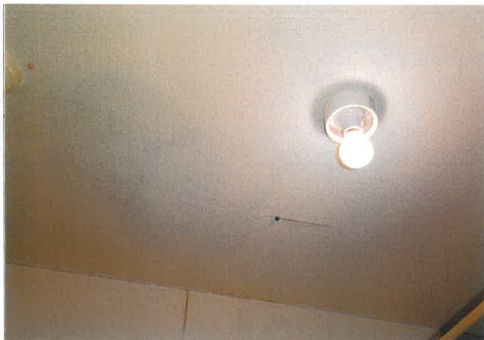
(46) 3階 301号室 洗面台付近の壁、天井クロスの剥離
