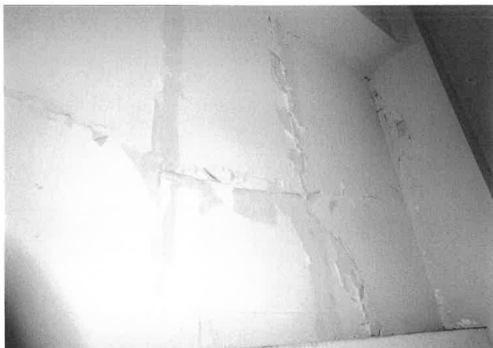
(18) 2階ホールの壁の損傷
