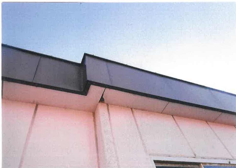
(29) 6階 機械室の軒天の損傷
