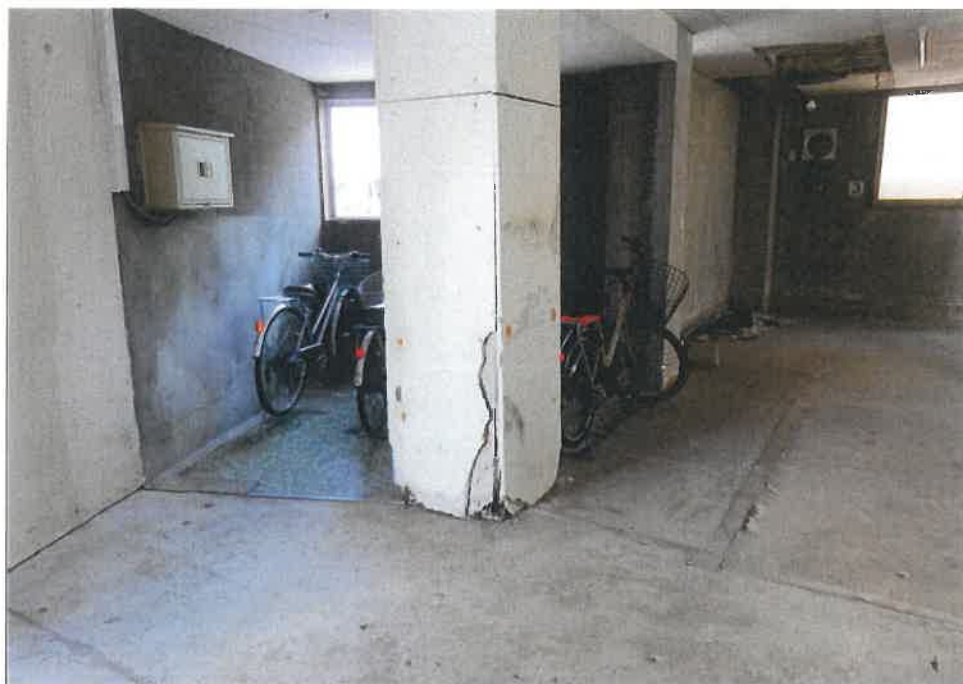
(7) 1階 駐車場の壁等の損傷
