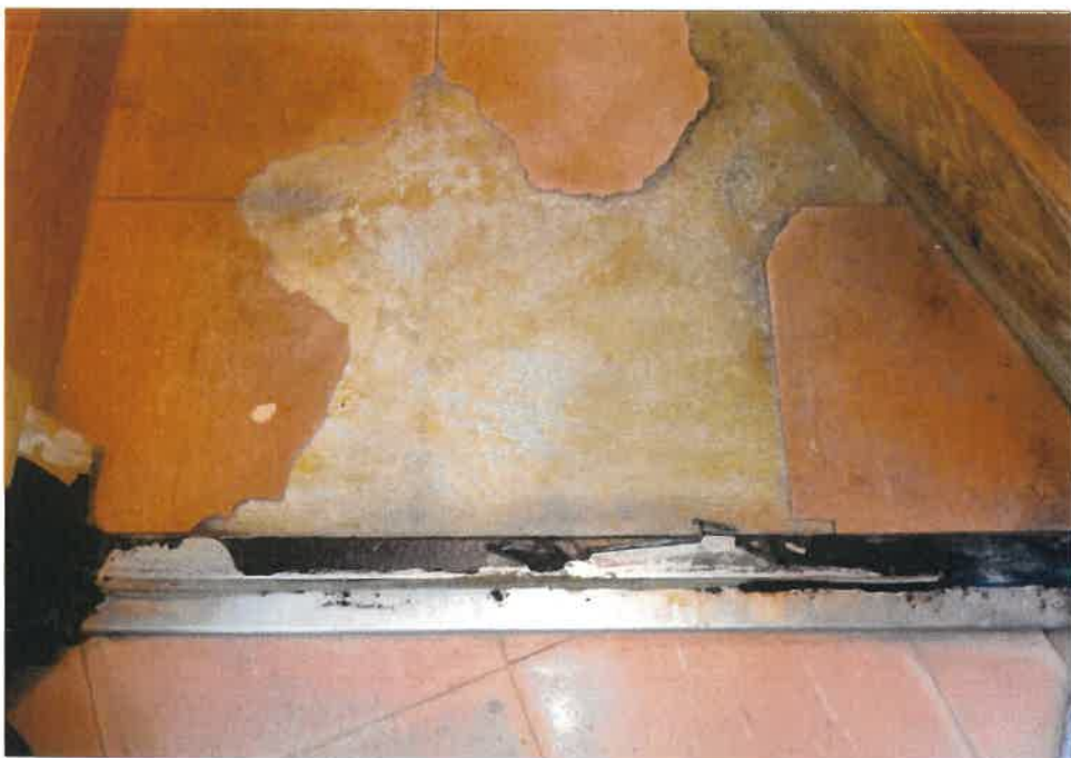
(70) 5階 502号室 玄関床のPタイルの損傷
