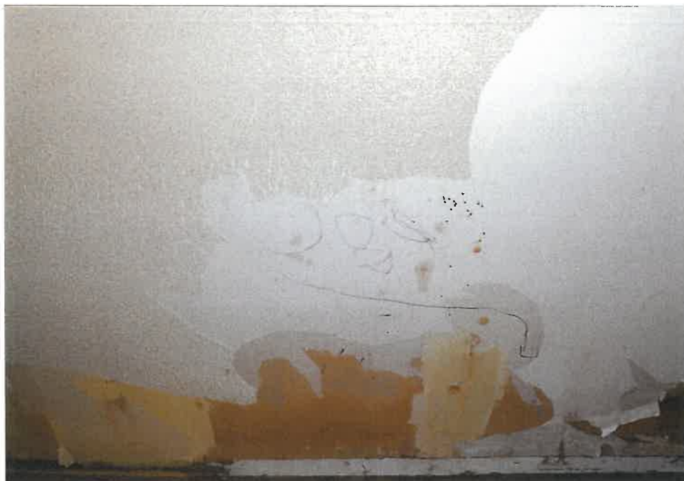
(34) 2階 201号室 居間の壁クロスの剥離、落書き
