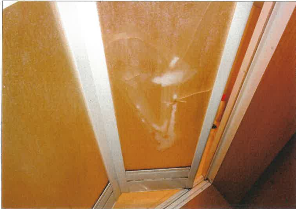
(63) 5階 502号室 浴室の折戸の損傷
