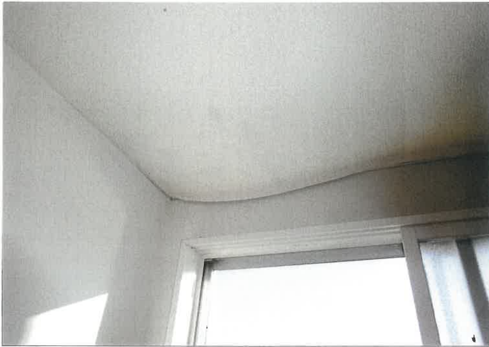
(19) 3階ホールの天井の歪み
