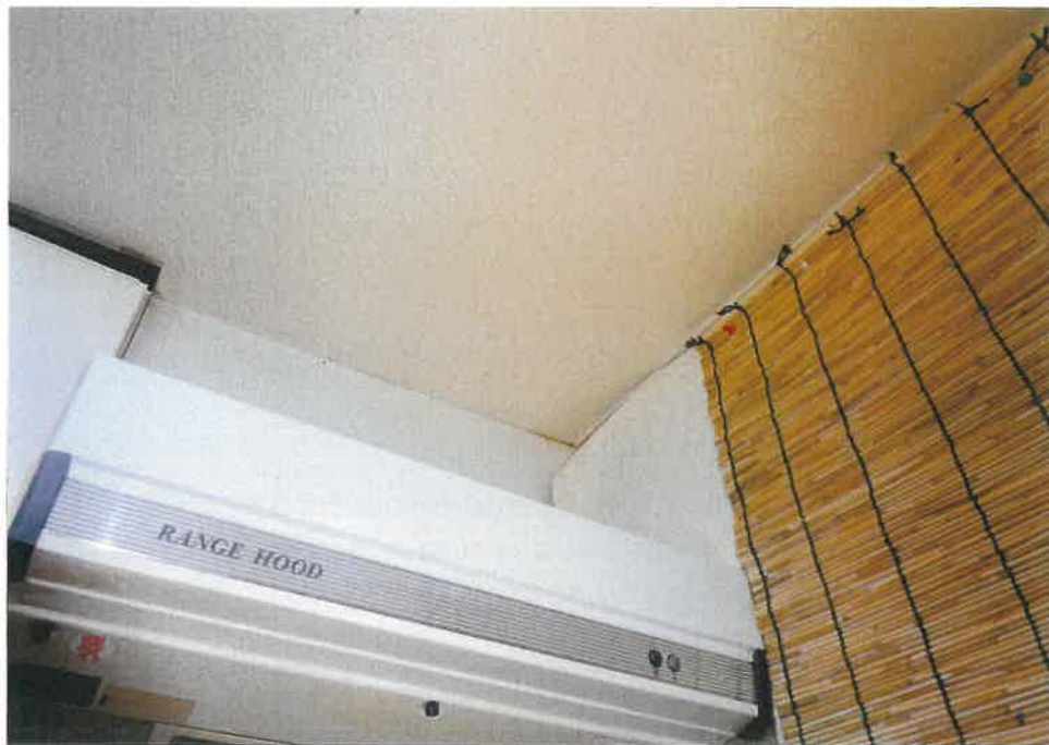
(45) 3階 301号室 台所の天井クロスの剥離
