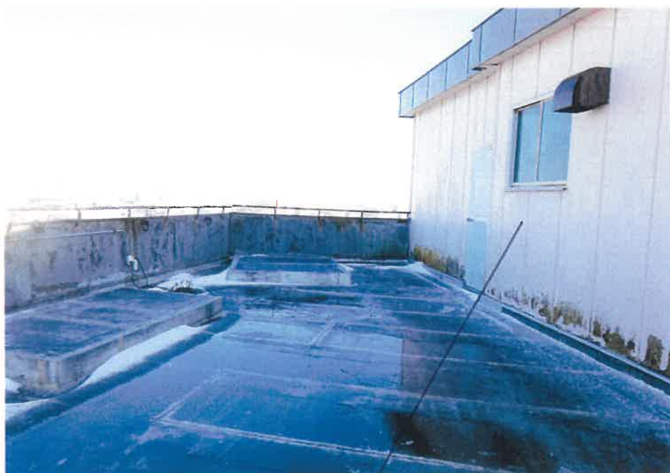
(30) 屋上(防水シートの劣化等)
