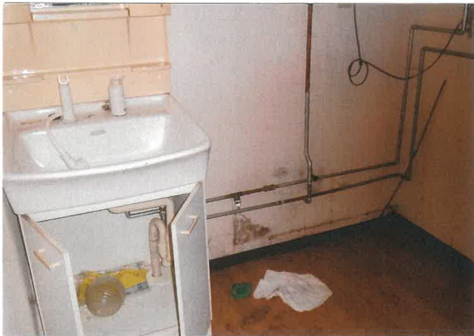
(37) 2階 201号室 洗面台付近の壁、床の汚損
