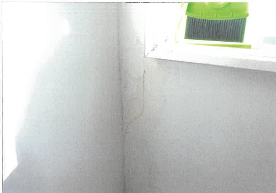
(20) 3階ホールの壁の損傷
