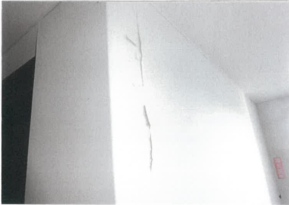
(21) 4階ホールの壁の損傷
