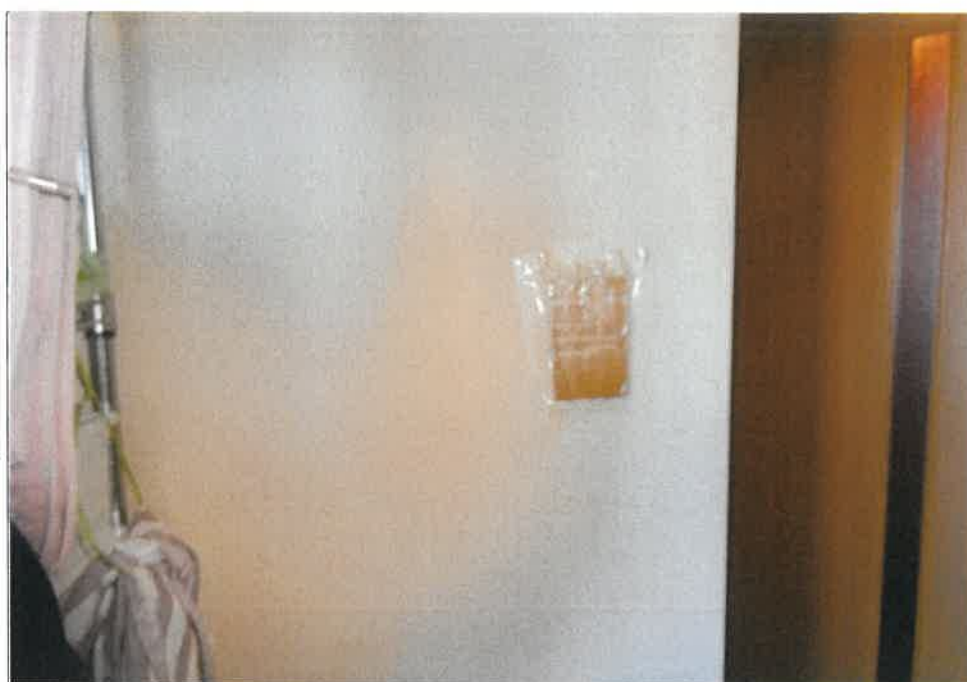
(62) 5階 502号室 居間のインターフォンが使用出来ない状況
