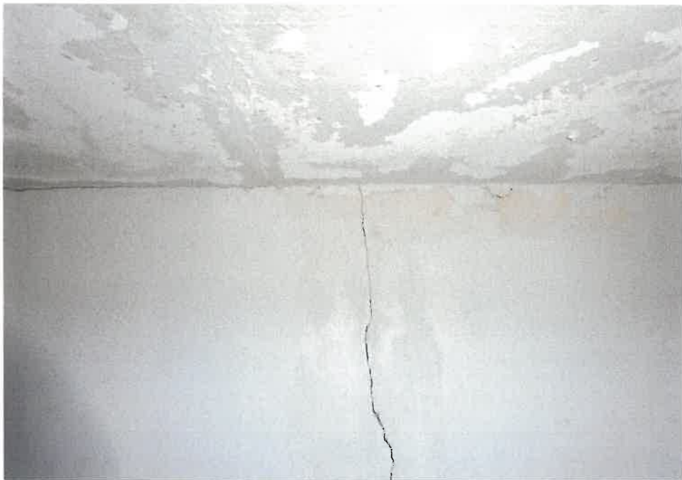
(12) 2階階段付近の壁の損傷
