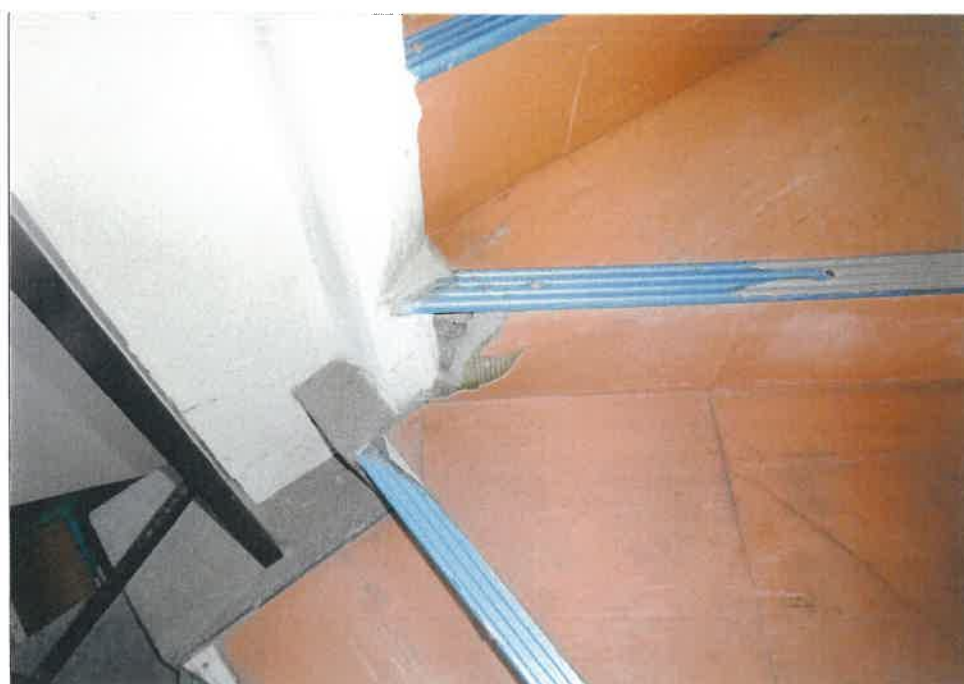
(14) 2階階段部分の損傷
