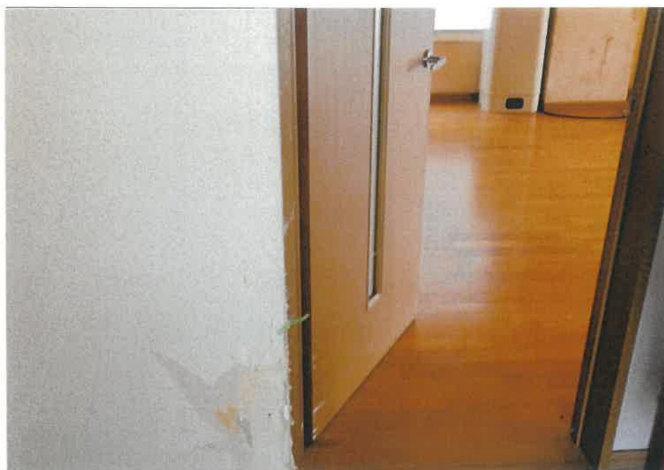
(40) 2階 201号室 ホールの壁の引っ掻き傷
