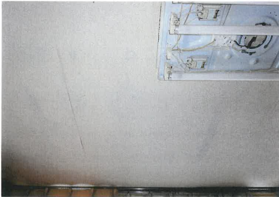
(67) 5階 502号室 洋室2の天井の雨漏り跡
