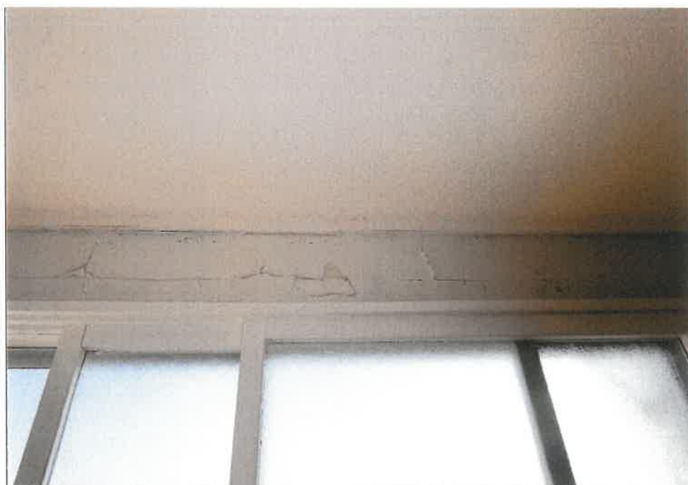
(16) 2階ホールの壁の損傷
