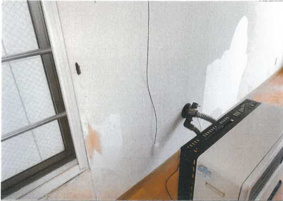
(33) 2階 201号室 居間の壁クロスの剥離
