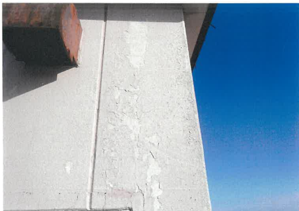
(26) 6階 機械室の外壁の損傷
