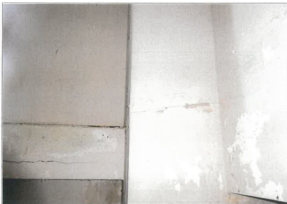
(13) 2階階段付近の壁の損傷
