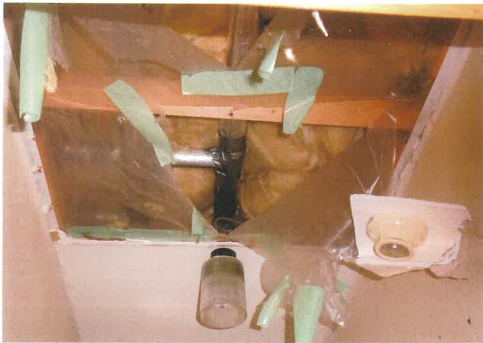
(39) 2階 201号室 トイレの天井の損傷
