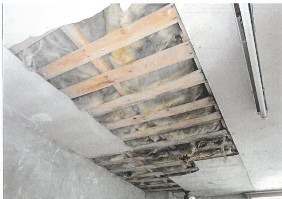
(8) 1階 駐車場の天井の損傷
