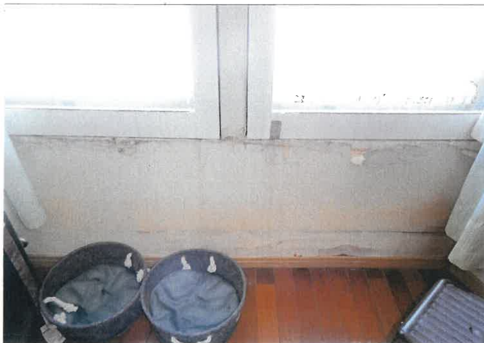
(61) 5階 502号室 居間の窓付近の壁クロスの剥離
