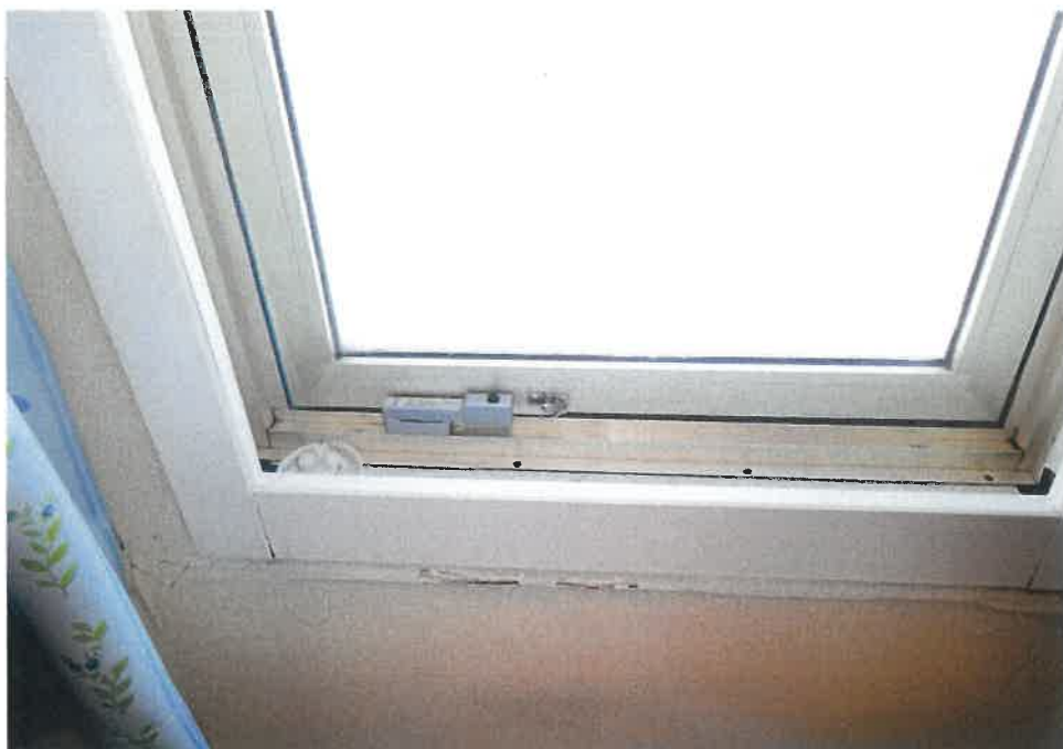
(42) 2階 202号室 居間の窓付近の結露
