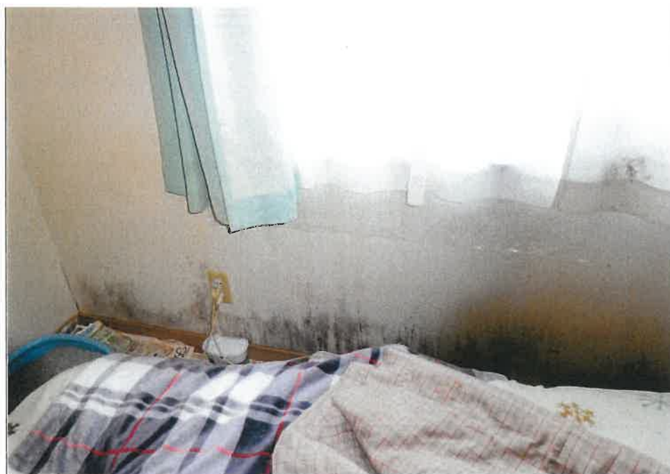
(64) 5階 502号室 洋室1の壁の黒カビ
