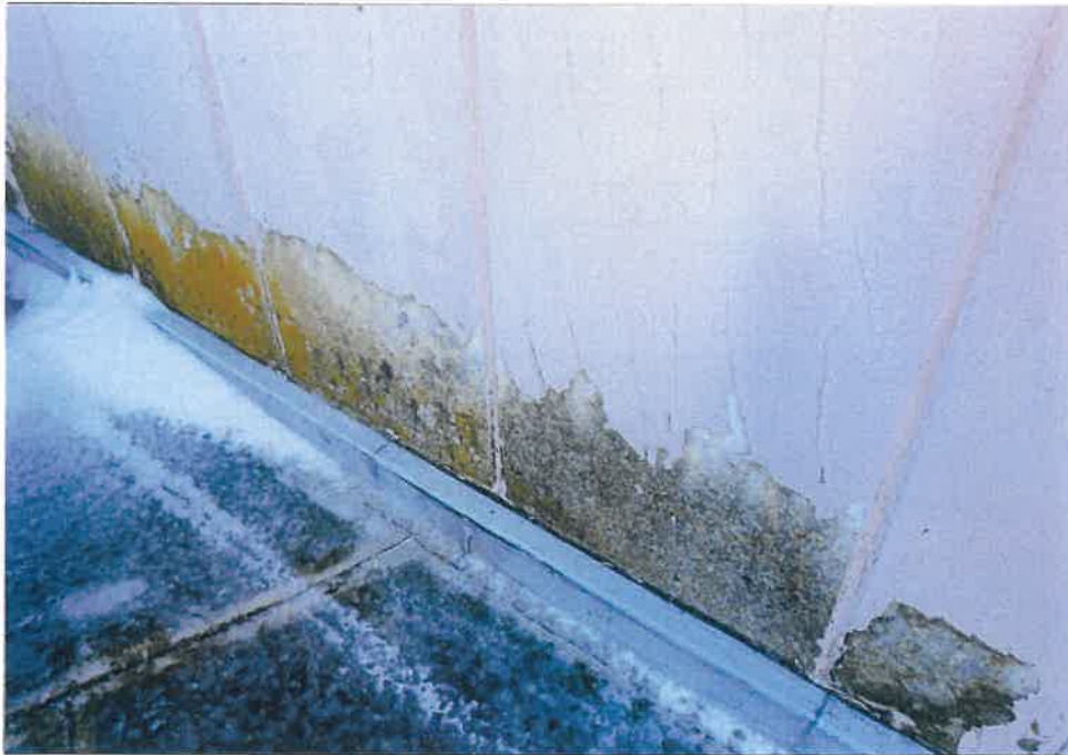
(27) 6階 機械室の外壁の損傷
