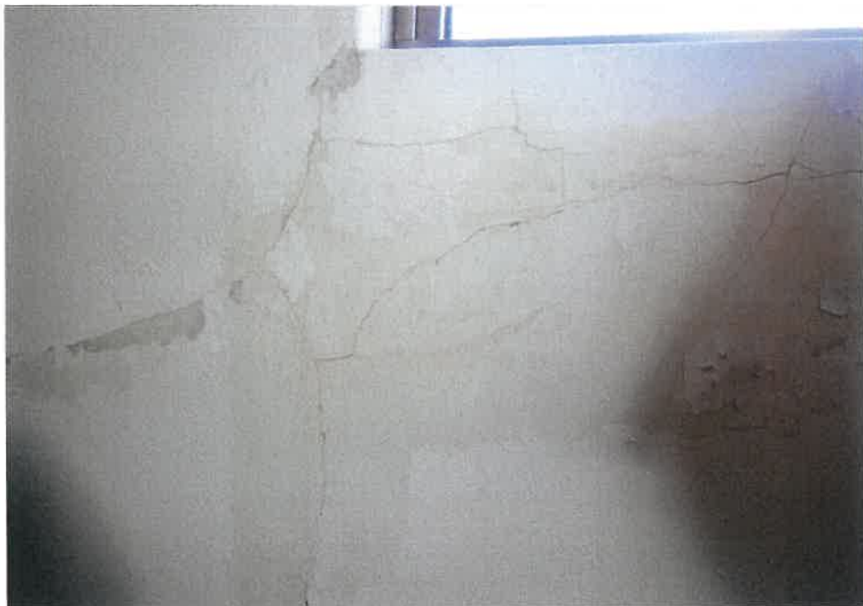
(22) 4階ホールの壁の損傷
