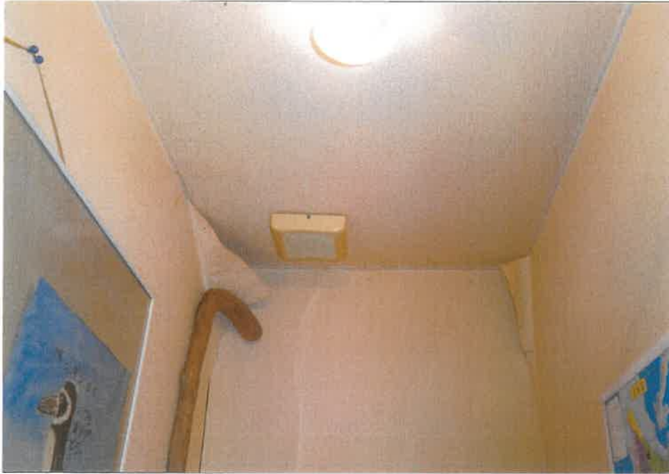
(47) 3階 301号室 トイレの天井クロスの剥離
