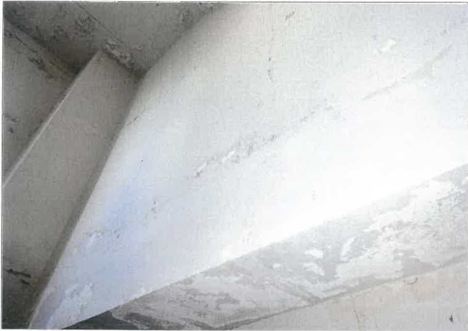
(11) 2階階段付近の壁の損傷
