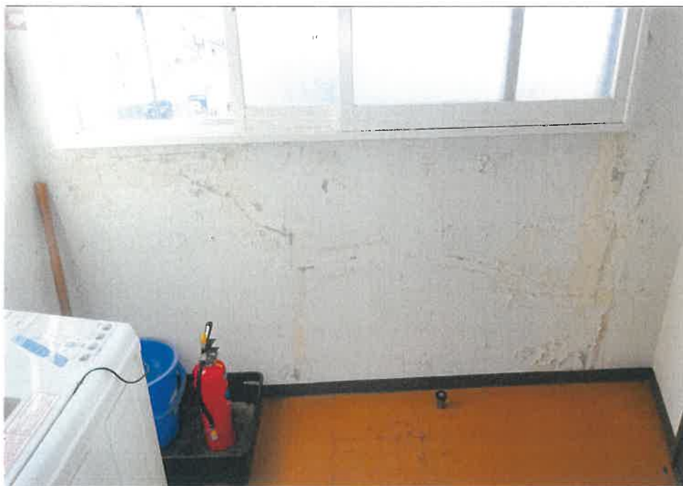
(15) 2階ホールの壁の損傷
