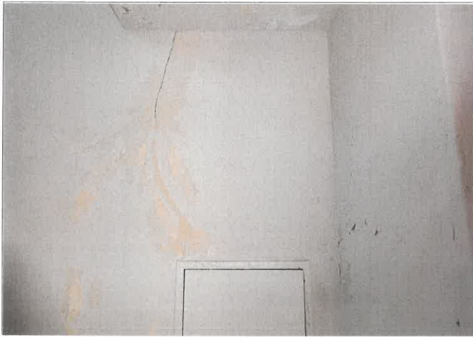
(9) 1階 駐車場の壁の損傷
