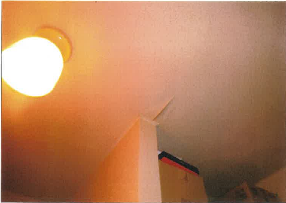
(69) 5階 502号室 ホールの天井クロスの剥離
