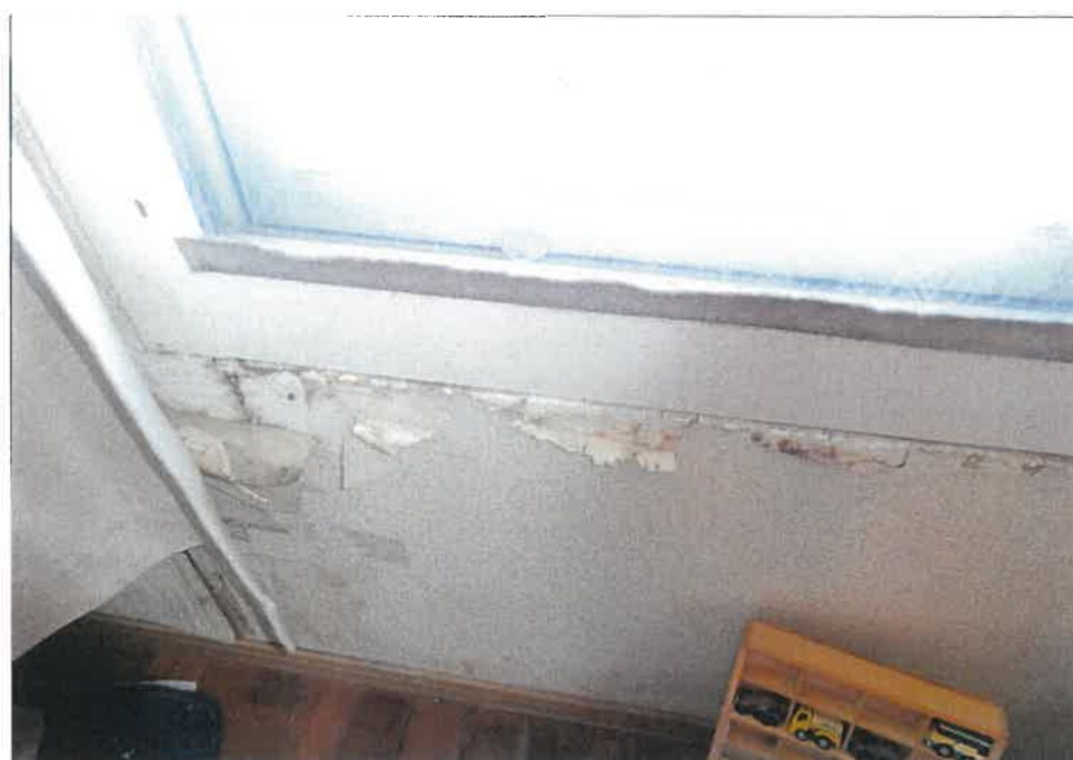
(66) 5階 502号室 洋室2の壁クロスの剥離
