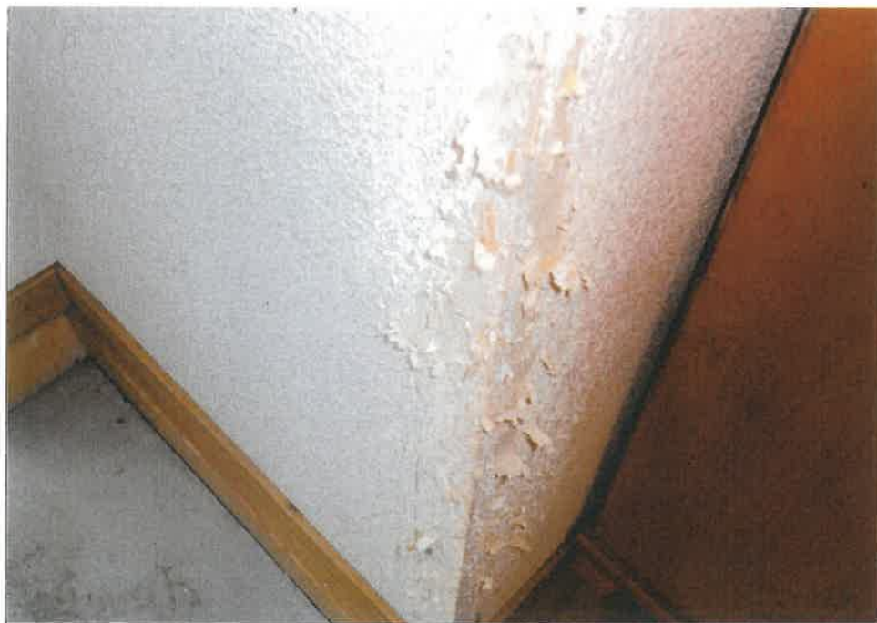
(41) 2階 201号室 ホールの壁の引っ掻き傷等
