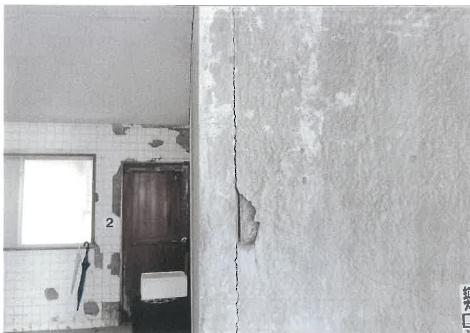
(6) 1階 駐車場の壁の損傷
