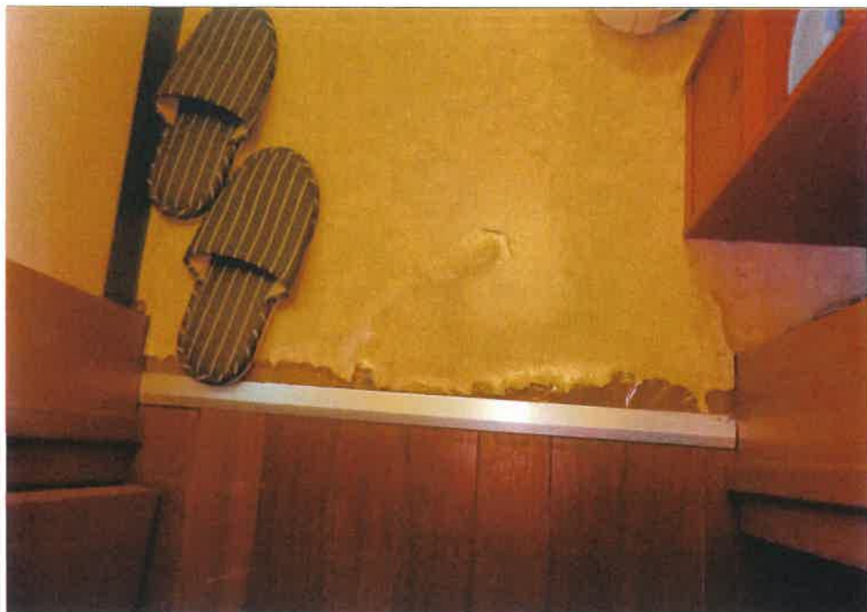
(68) 5階 502号室 トイレの床材の剥離
