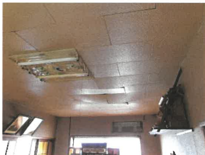
物件 4 建物の中の和室（9 畳）の天井の損傷の状況
