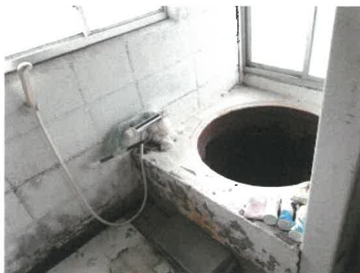
物件4 建物の浴室（利用不能）の状況
