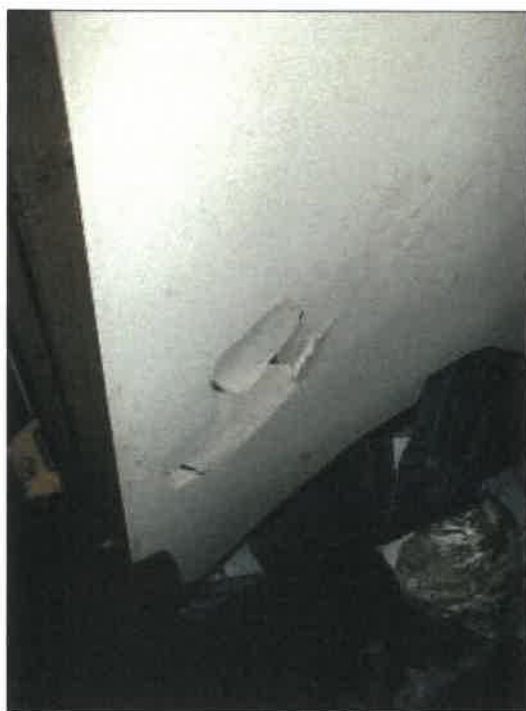
玄関前廊下の壁の損傷状況
