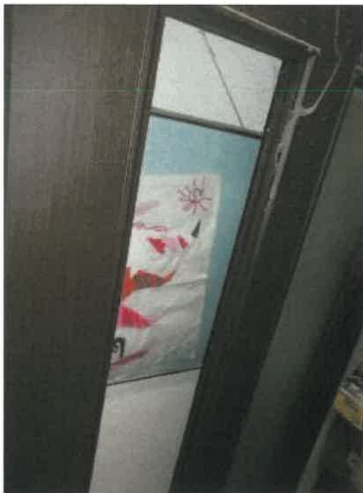
L D K出入口ドアのガラスの破損状況
