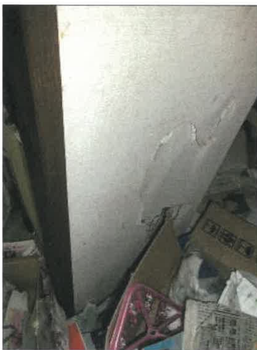
L D K出入口付近の壁の損傷状況
