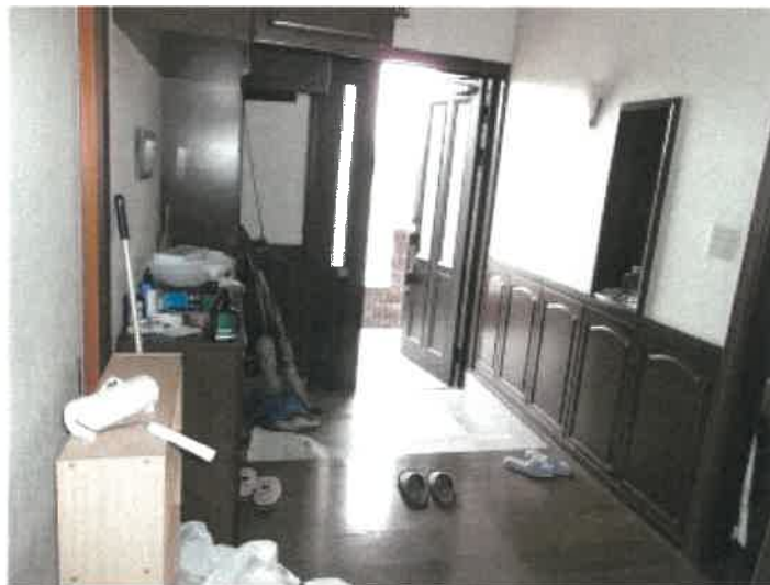
物件 3 建物の 1 階玄関内側周りの状況
