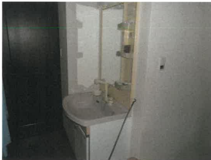
物件 3 建物の 2 階北西角付近洗面所の状況
