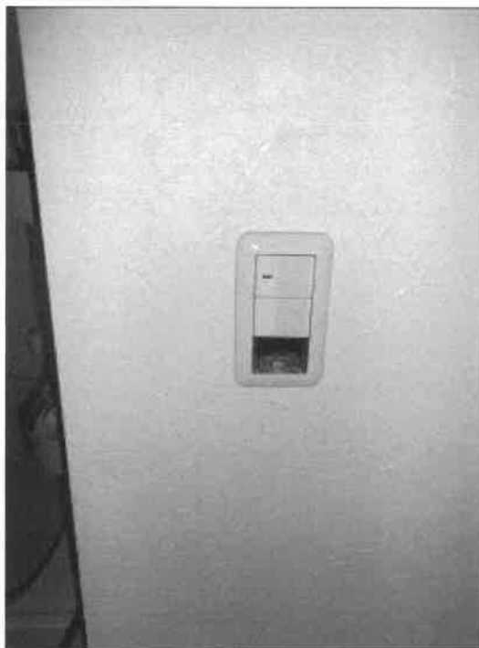
物件 3 建物の 2 階北西角付近壁のコンセントの破損の状況
