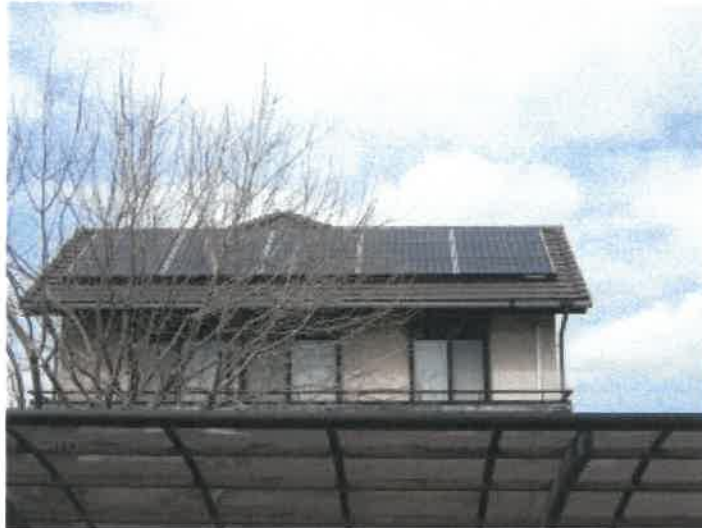
物件 3 建物の南側屋根の太陽光発電パネル設置状況
