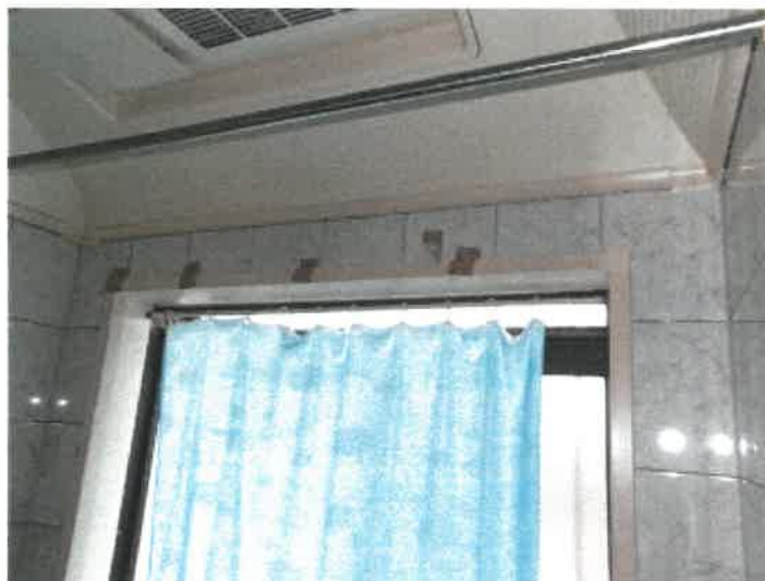
物件 3 建物の 1 階浴室の窓枠の損傷状況
