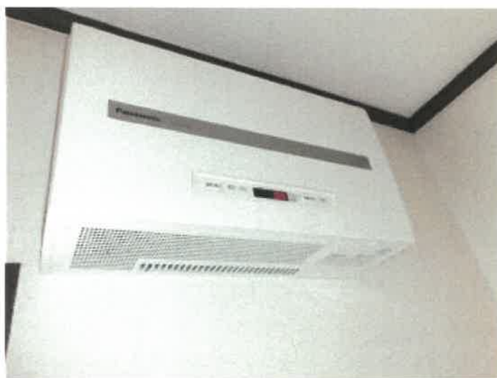
脱衣所壁の太陽光発電パワーコンディショナー設置状況
