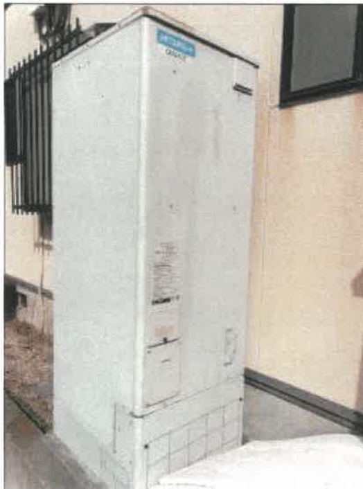
物件3建物南西角付近の電気温水器の設置状況
