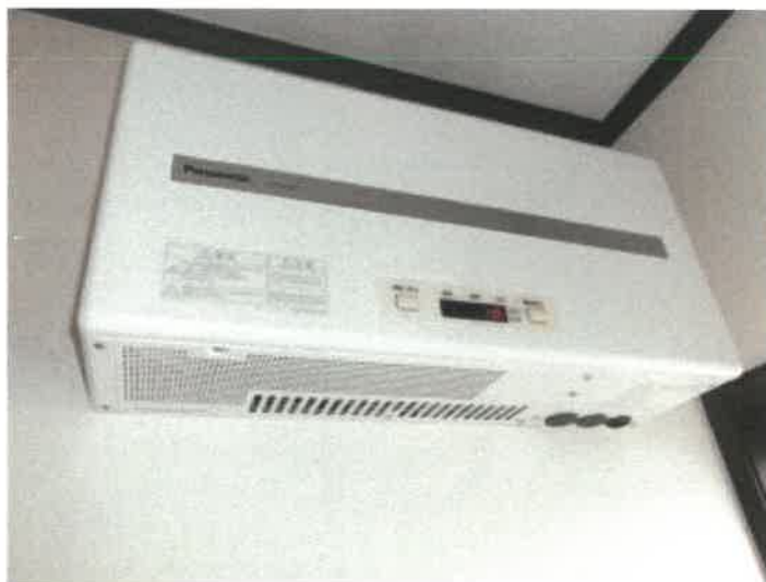
脱衣所壁の太陽光発電パワーコンディショナー設置状況
