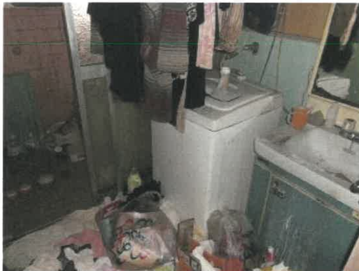
物件 2 建物洗面脱衣所の状況
