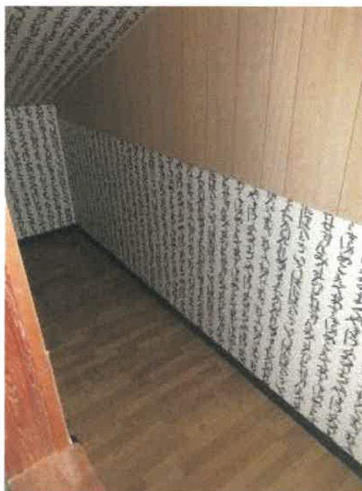
物件3建物部分2階和室の北側押入の状況
