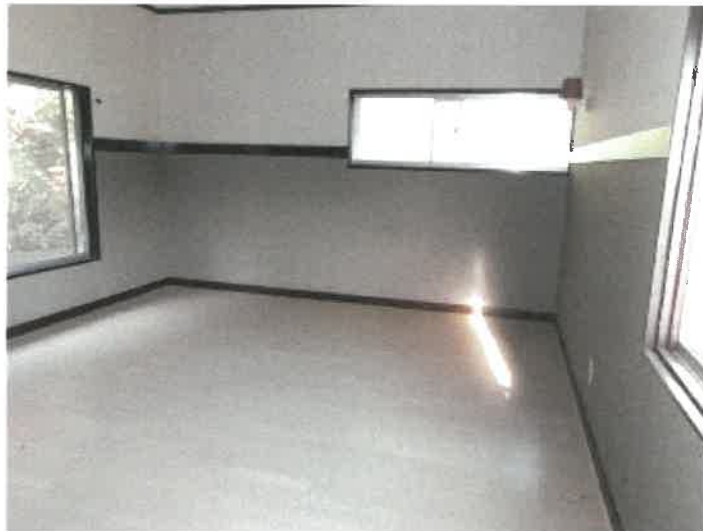
物件2建物部分2階洋室の状況
