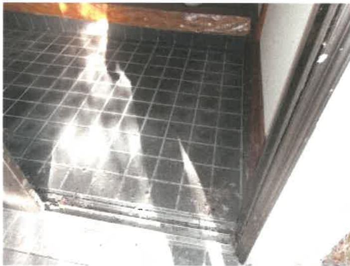
物件3建物部分玄関内のシロアリの死骸が多数ある状況
