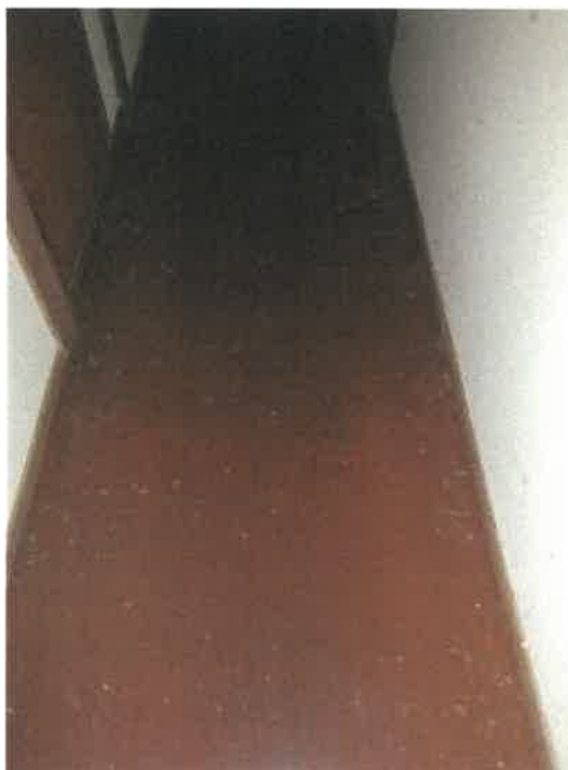
物件 3 建物部分 1 階南北廊下のシロアリの死骸が多数ある状況
