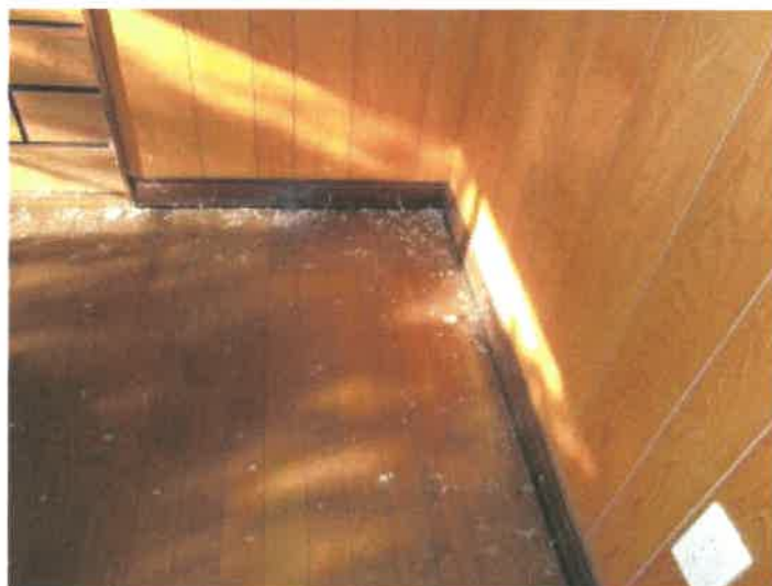
物件 3 建物部分 2 階南側洋室のシロアリの死骸が多数ある状況
