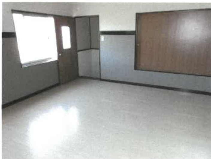
物件2建物部分2階洋室の状況
