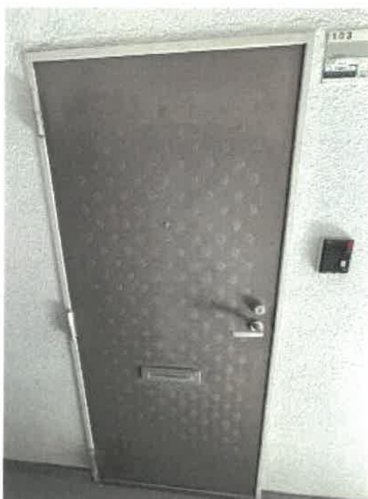
103号室入口ドアの状況
