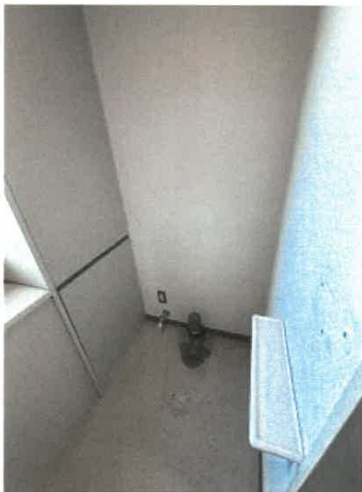
物件3 3階便所の状況（便器なし）
