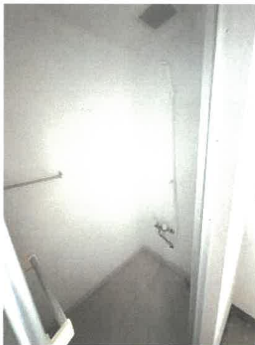
物件3 2階シャワー室の状況
