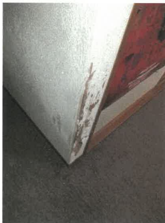
物件 2 建物の 2 階南側東洋室壁の犬・猫の損傷被害の状況
