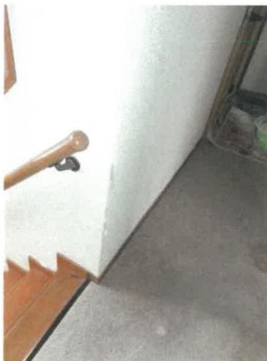
物件2建物の2階階段付近壁の犬・猫の損傷被害の状況
