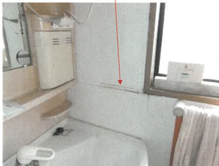
物件 2 建物の 1 階洗面脱衣所の洗面台横の壁の状況
