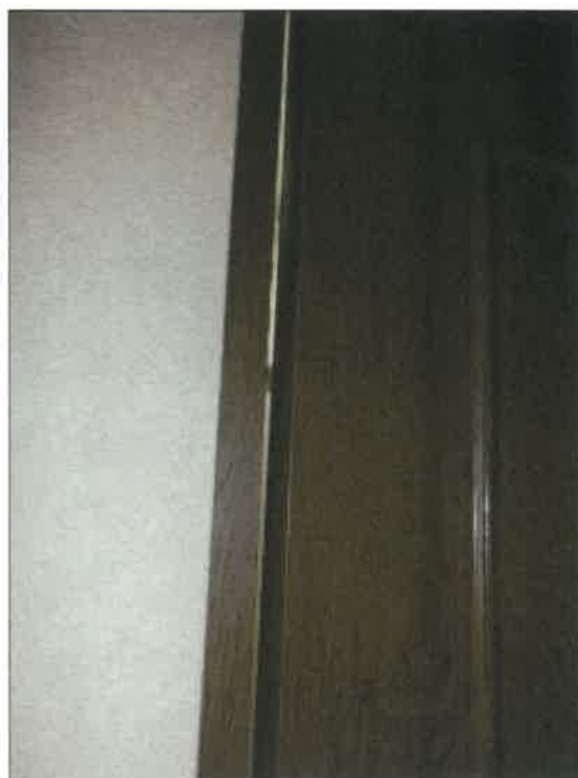
受命物件（201号室）のトイレのドアが立て付けが悪い状況
