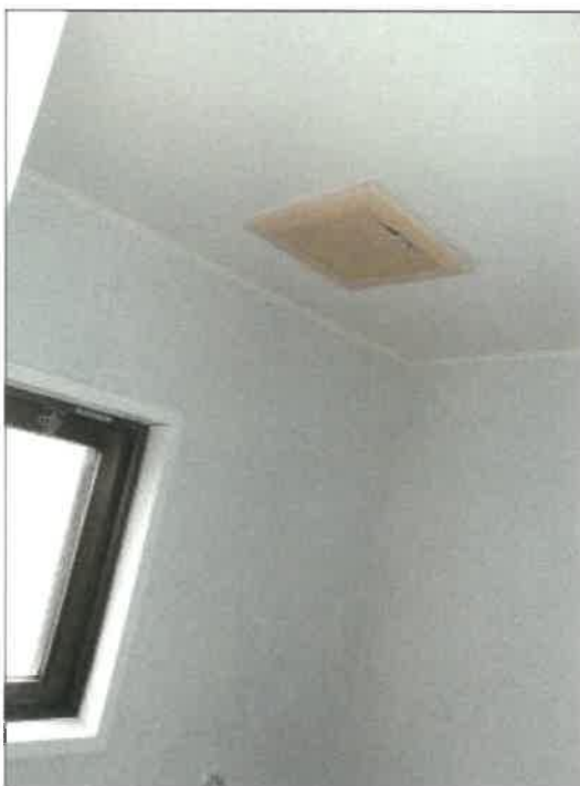
受命物件（201号室）の浴室の故障している換気扇の状況
