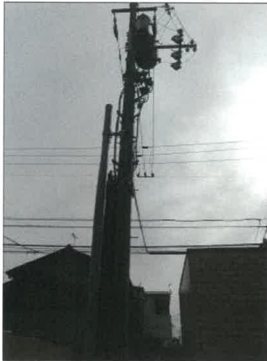
受命物件の存在するマンションの敷地内の高圧変電設備設置の電柱の状況
