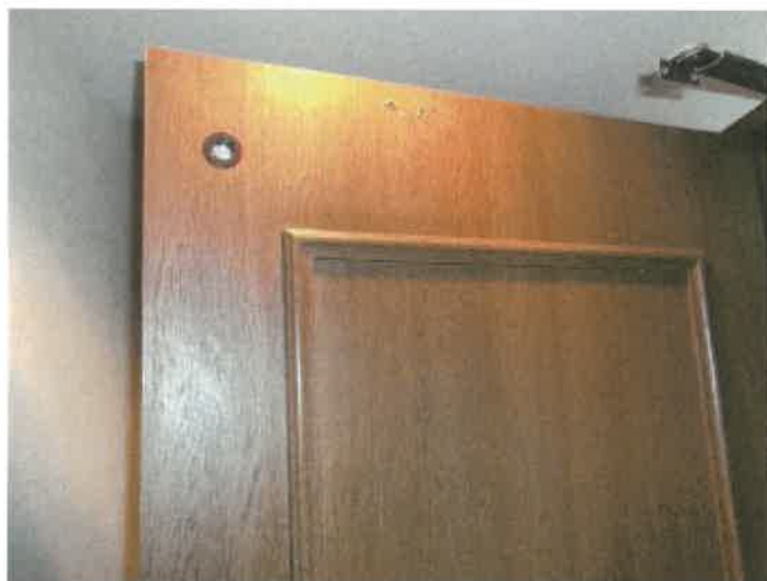
受命物件（201号室）の洗面脱衣所出入口ドアのクローザーが取れている状況
