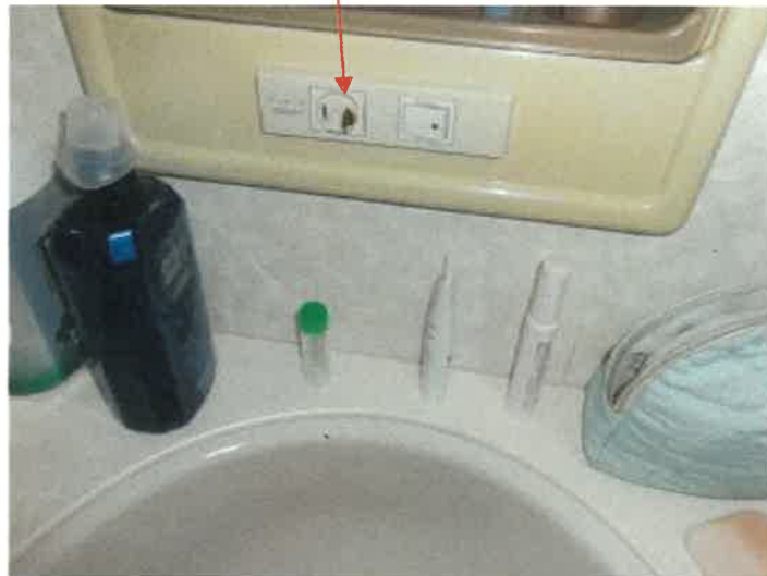
受命物件（201号室）の洗面台のコンセント異常の状況
