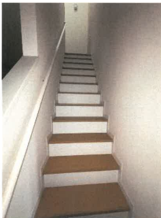
物件2 階段の状況
