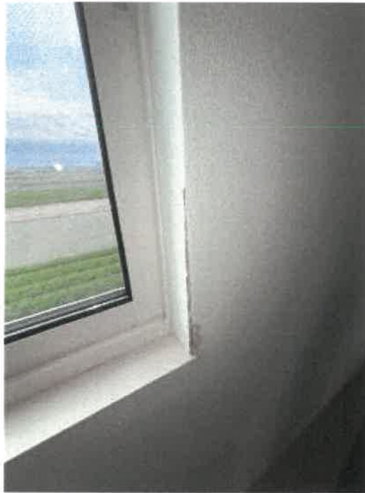
物件 2 2階西側洋室の西側窓枠の状況
