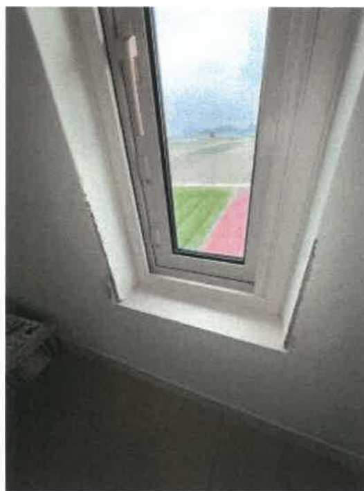
物件 2 2階西側洋室の北西側窓枠の状況
